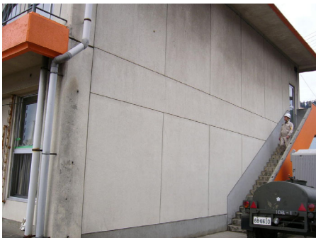
写真 5.43 外壁亀裂状況（妻壁）
