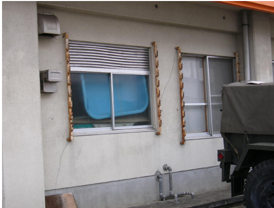
写真 5.41 外壁亀裂状況（雑壁）
