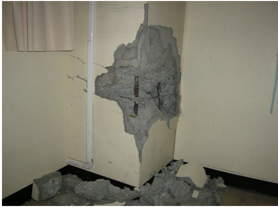
写真 5.29 6階建病棟の2階南西角の柱
