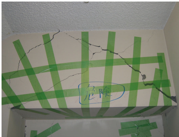
写真 5.8 昭和 44 年竣工棟の短スパン梁のせん断破壊
