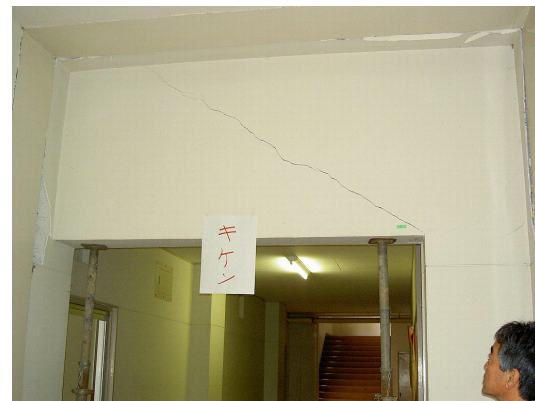
写真 5.17 短スパン梁のせん断ひびわれ （特別教室棟、EXP. J部1階）
