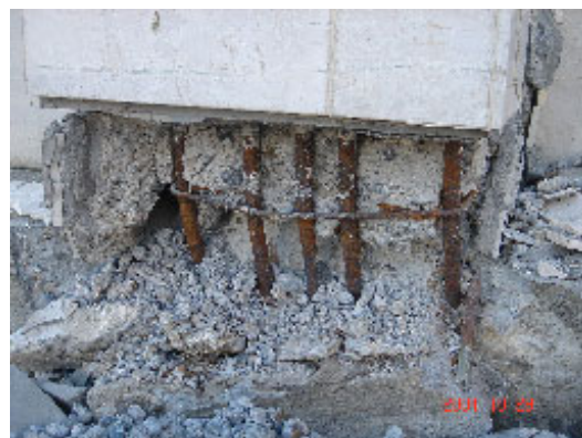
写真 5.25 柱脚ヒンジゾーンの主筋座屈
