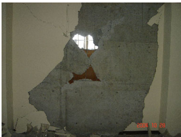
写真 5.10 昭和 44 年竣工棟の壁部材のせん断破壊
