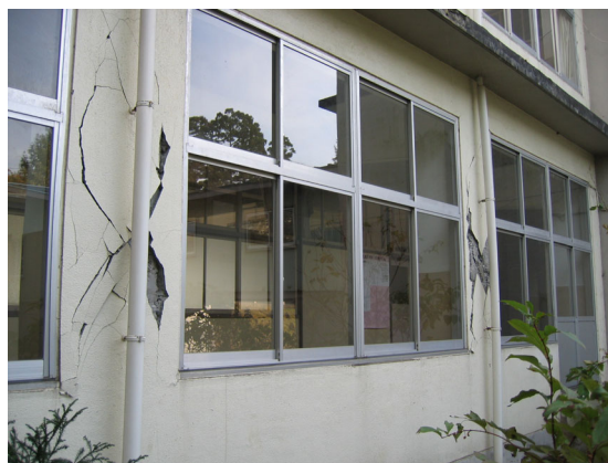
写真 5.2 特別教室棟の 1 階廊下側の被害
