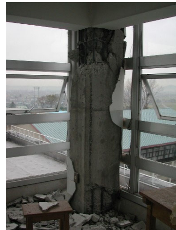
写真 5.28 柱のせん断破壊（ペントハウス）
