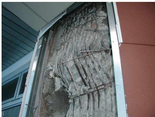
写真 5.32 建築物 J の柱のせん断破壊
