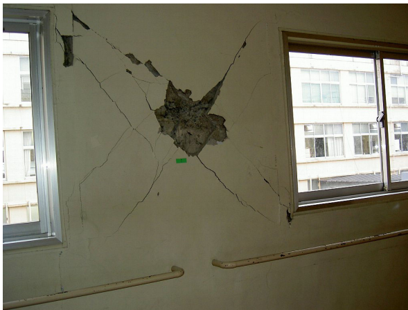
写真 5.14 壁柱のせん断破壊 （管理及び普通教室棟、2階西構面）
