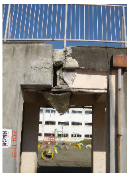
写真 5.36 渡り廊下接続部の衝突
