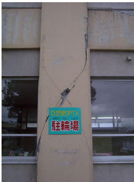
写真 5.37 1 階柱のせん断ひび割れ
