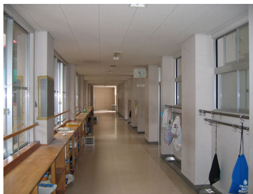
写真 5.19 腰壁による柱の短柱化
