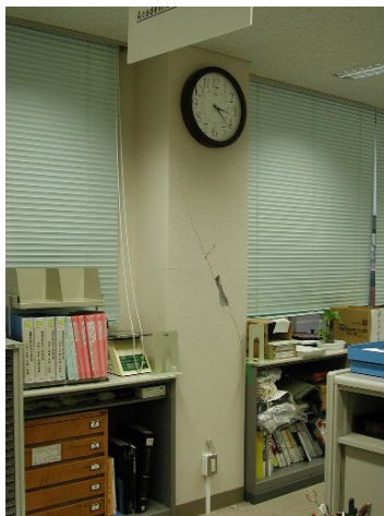
写真 5.26 屋内柱のせん断ひび割れによる損傷
