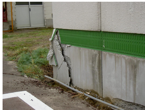
写真 5.33 基礎の破壊状況
