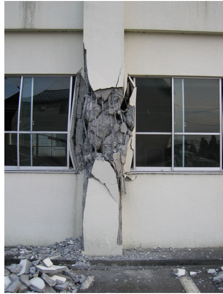
写真 5.5 短柱のせん断破壊
