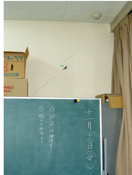
写真 5.15 耐力壁のせん断ひびわれ （管理及び普通教室棟、1階張間方向）
