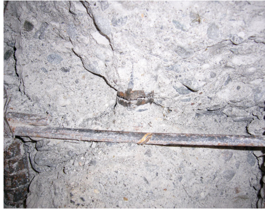
写真 5.30 2階南西角の柱の詳細 (中央が主筋圧接部の破断箇所)
