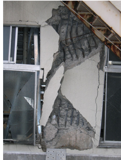
写真 5.7 昭和 43 年竣工棟の短柱のせん断破壊
