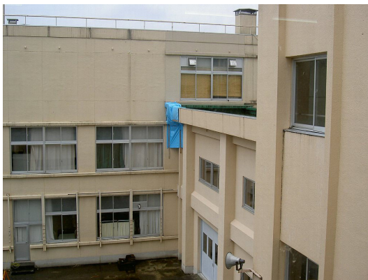
写真 5.16 EXP. J部の被害 （管理及び普通教室棟～特別教室棟間）
