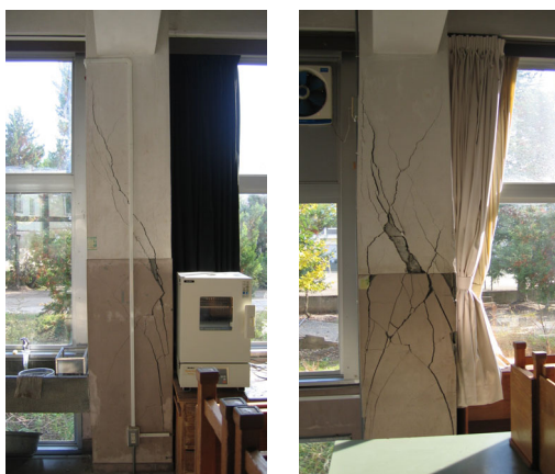
写真 5.3 特別教室の 1 階教室側柱のせん断破壊
