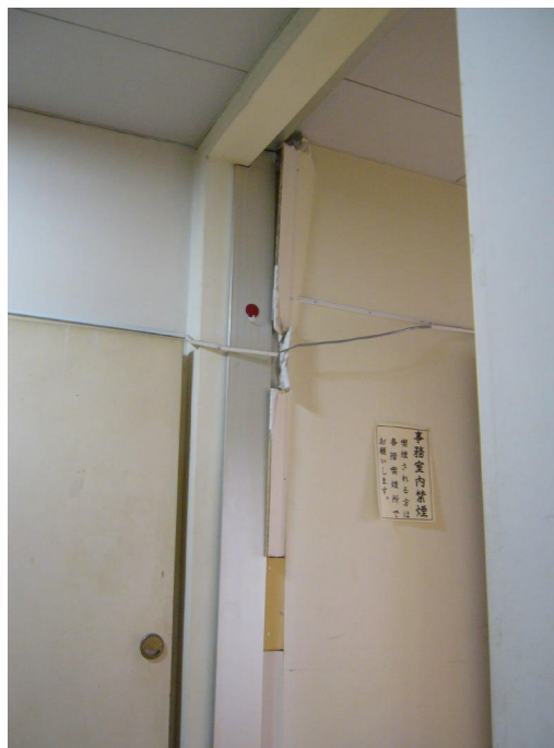
写真 5.40 エキスパンション損傷状況 (室内 2 階)
