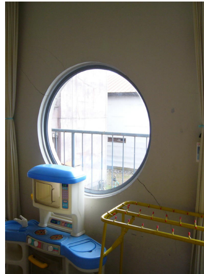
写真 5.42 開口部亀裂（2 階丸窓）
