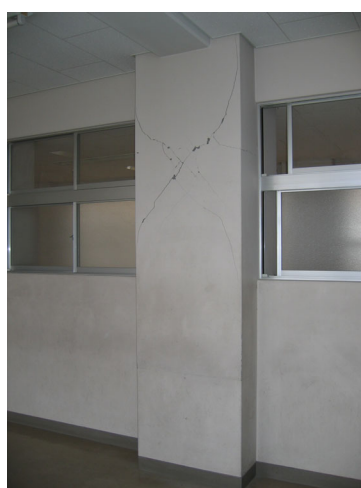
写真 5.21 教室の短柱のせん断破壊
