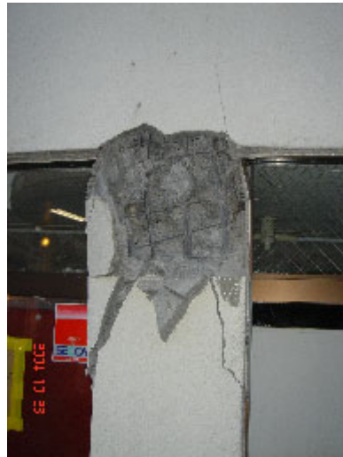
写真 5.23 柱頭部の損傷
