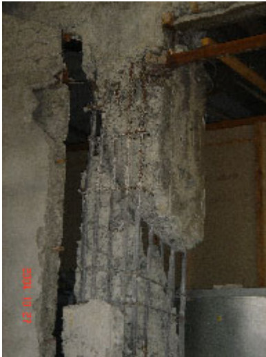
写真 5.22 柱のせん断破壊
