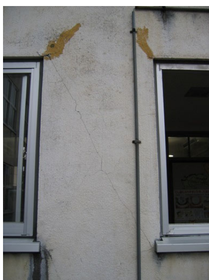
写真 5.35 柱のせん断ひびわれ
