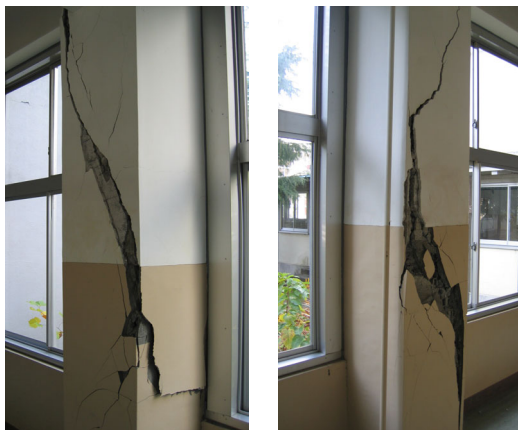
写真 5.1 特別教室棟の 1 階廊下側 短柱のせん断破壊
