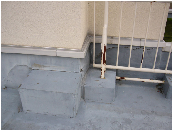
写真 5.31 2階南西角の柱の外側 (仕上げが浮き上がっている) (写真中央から手前に向かって、1F 柱を屋上まで延長させた部分が見 える。)
