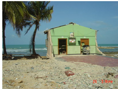
図3.1.3 沿岸に建つ住家の被害
