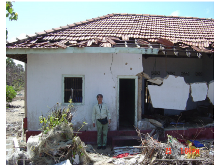
図3.1.7住家の被害（ポイントペドロ東側）
