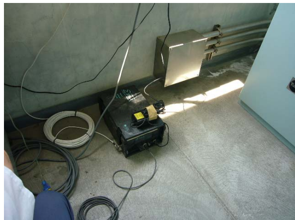
写真4 柏崎市役所本館 7F 設置状況
