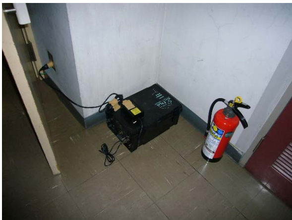
写真3 柏崎市役所本館 B1F 設置状況
