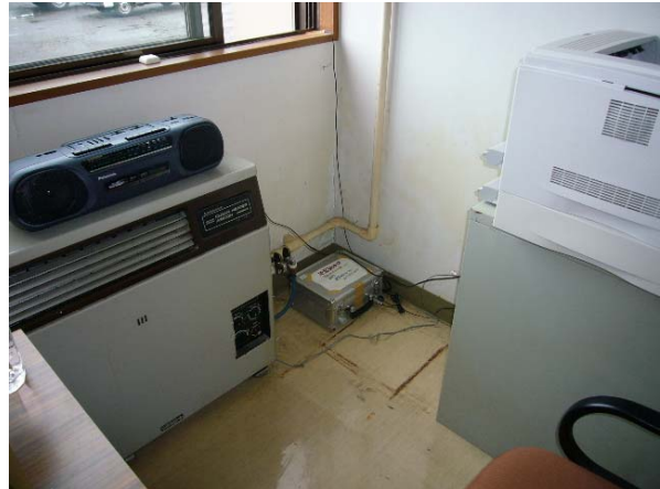
写真8 西山町事務所 1F 設置状況
