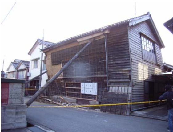
写真 5.5 倒壊寸前の土塗り壁を有する家屋
