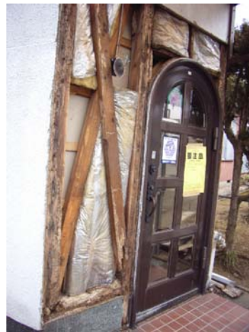
写真 5.46 木造躯体の腐朽
