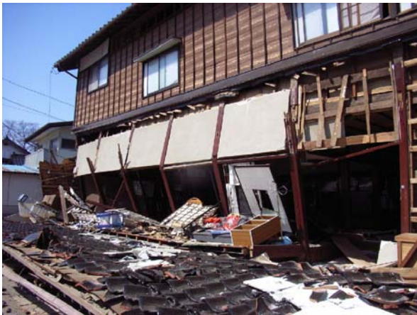
写真 5.15 倒壊は免れたが柱が折損した住宅
