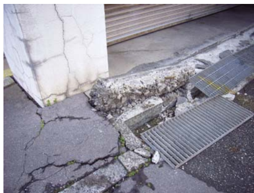
写真 6.2 輪島市役所周辺地盤の隆起・ひび割れ
