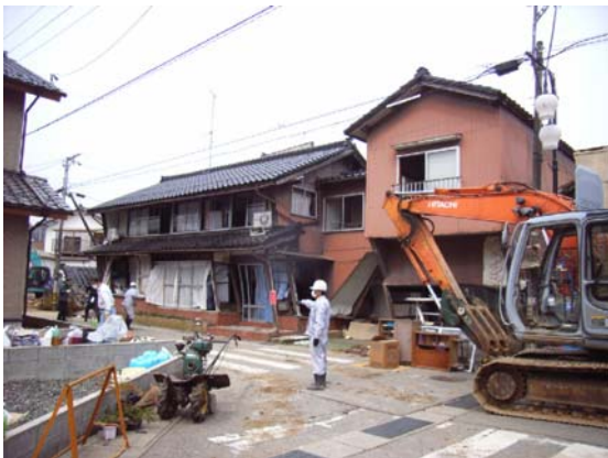
写真 5.41 残留変形が大きい店舗併用住宅
