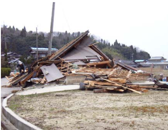
写真 5.51 倒壊した作業所または倉庫
