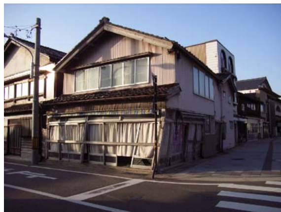
写真 5.6 大きく傾いた店舗併用住宅
