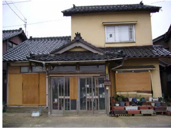
写真 5.50 国道 249 号線沿いの被害家屋
