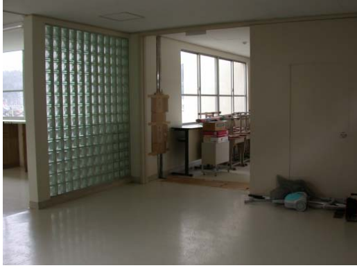
写真 6.9 校舎 EXP.J 部の被害
