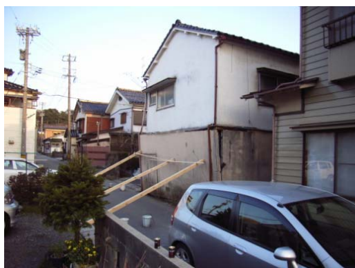
写真 8.3 K-net 輪島周辺で被害を受けた木造住宅
