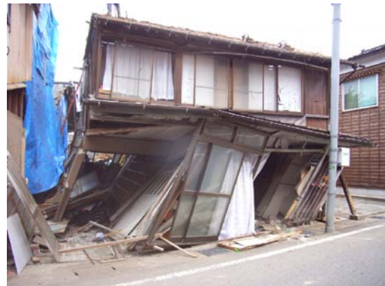
写真 5.42 倒壊寸前の建物
