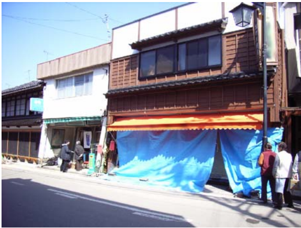
写真 5.21 大きな被害を受けた店舗併用住宅
