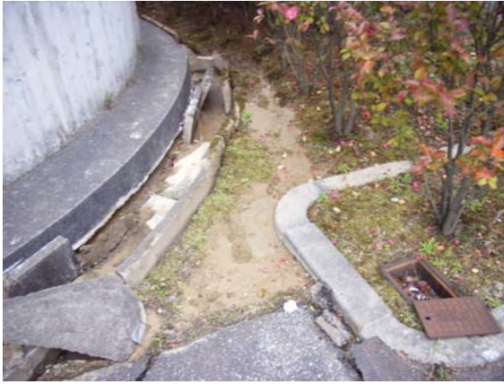
写真 5.49 田鶴浜支所裏の噴砂痕
