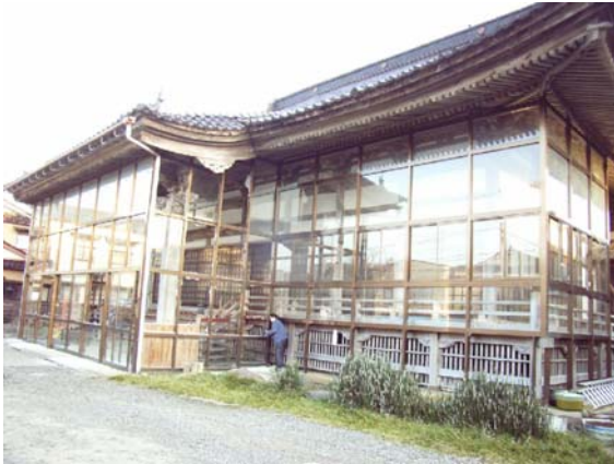
写真 5.9 カーテンウォールの被害
