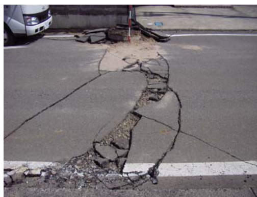
写真 6.6 総合福祉会館周辺の地盤変状
