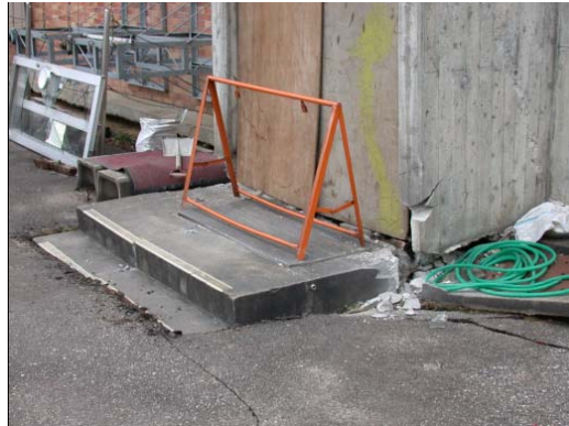
写真 6.15 建物周辺部の液状化被害
