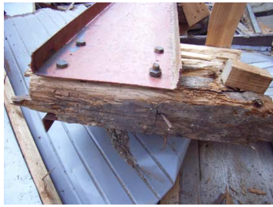
写真 5.4 左の家屋の鉄骨梁と木材柱の腐朽
