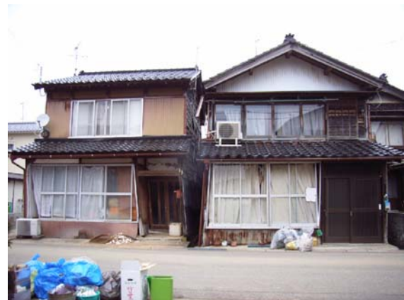
写真 5.44 衝突して外側へ傾いた建物
