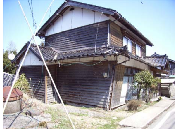
写真 5.14 道路側に大きく傾いた家屋
