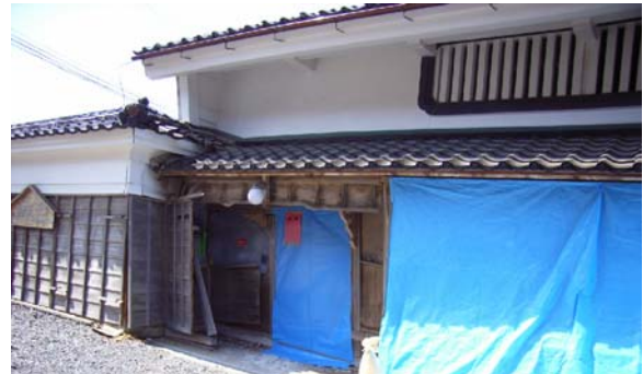
写真 5.32 残留変形が大きい住宅
