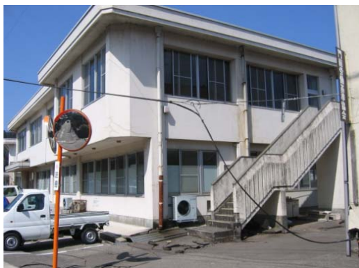
写真 6.5 門前地区の総合福祉会館 （柱、外壁に軽微なひび割れ、周辺地盤の変状）
