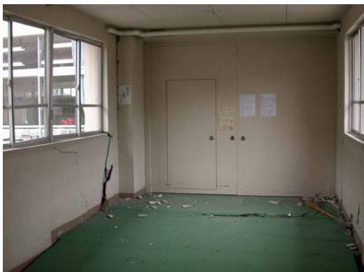
写真 6.11 校舎と講堂の渡り廊下の被害
