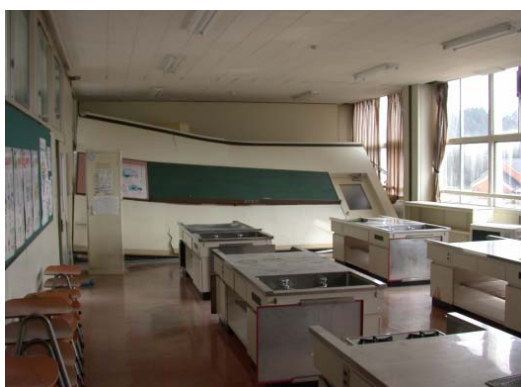
写真 7.6 間仕切り壁倒壊
