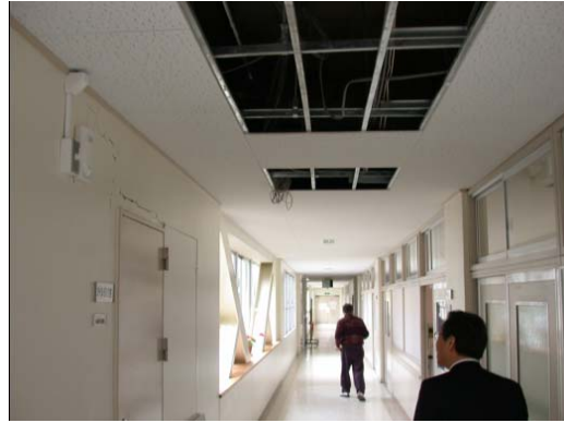
写真 6.10 校舎の廊下天井パネルの落下
