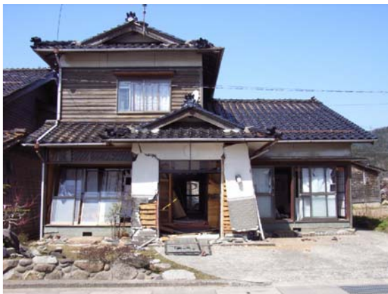
写真 5.25 外装、建具が大破した建物
