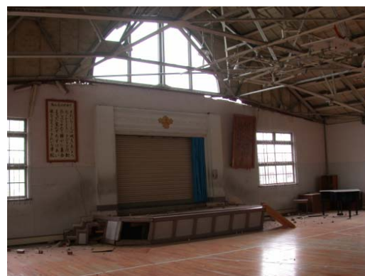
写真 6.12 講堂の妻壁部の被害
