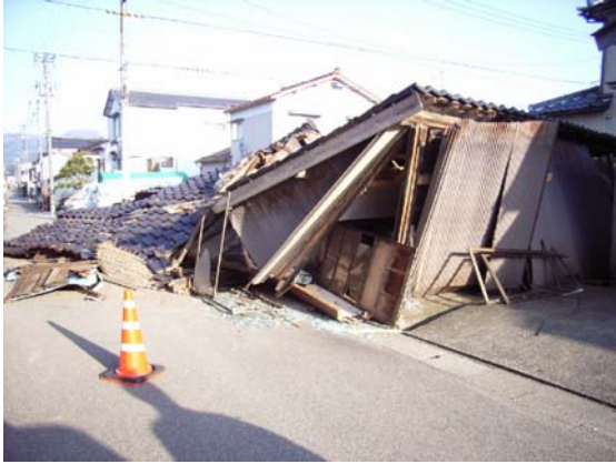
写真 5.7 1階車庫か倉庫の建物の倒壊
