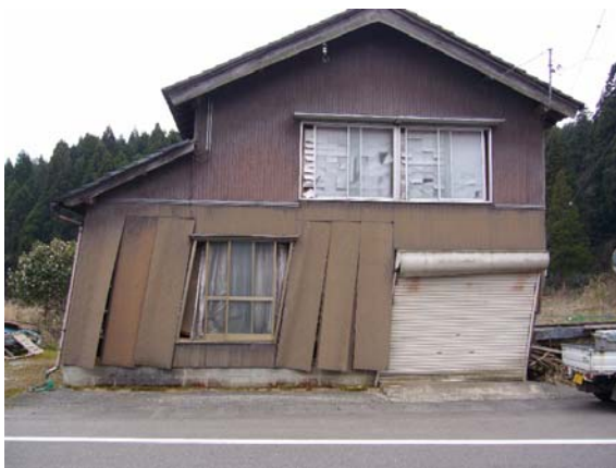
写真 5.47 残留変形が大きい車庫付き家屋
