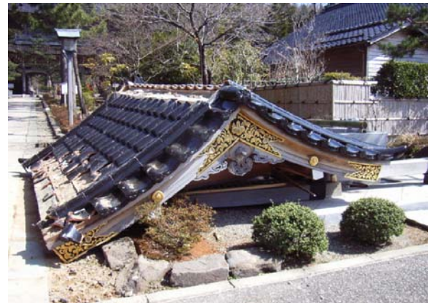
写真 5.18 倒壊した手洗いの東屋
