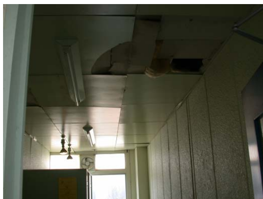
写真 7.5 天井パネル被害
