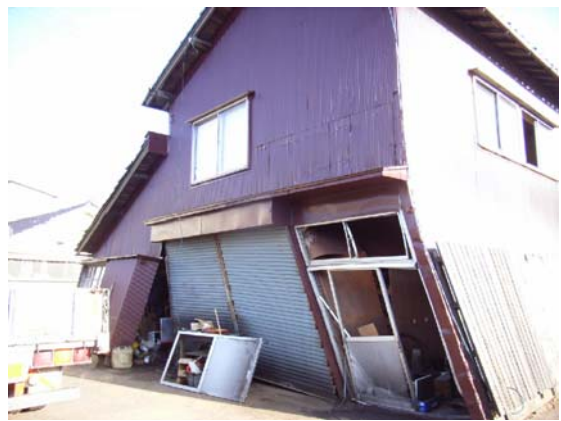
写真 5.2 倒壊寸前のチップ工場の倉庫
