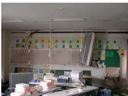
写真 7.8 妻壁被害（エアコン脱落）
