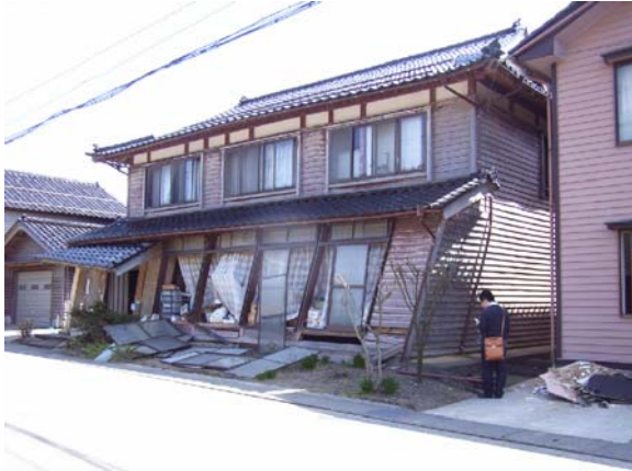
写真 5.29 通りの方向の残留変形が大きい住宅
