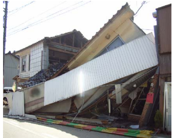
写真 5.22 倒壊した店舗併用住宅
