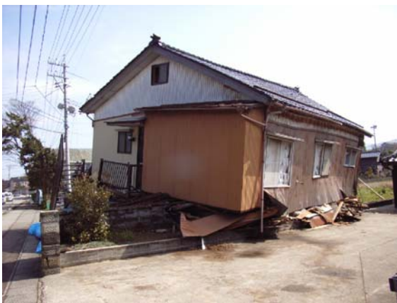
写真 5.11 小伊勢地区の倒壊家屋
