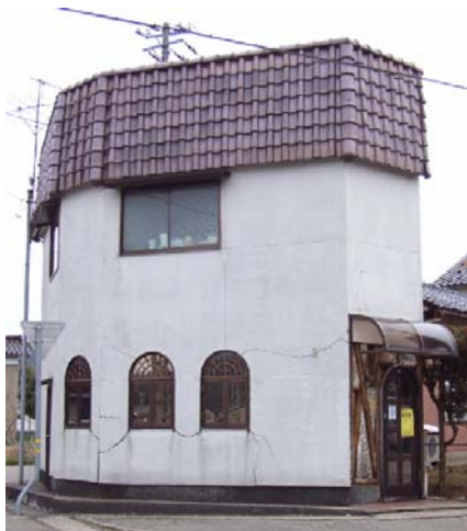
写真 5.45 躯体の腐朽が確認された店舗
