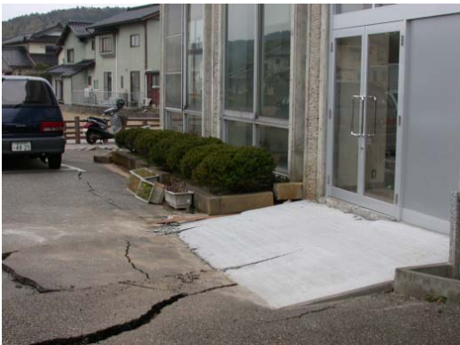
写真 6.16 建物周辺部の液状化被害
