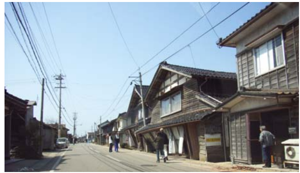
写真 5.30 道路側に大きく傾斜した家屋群
