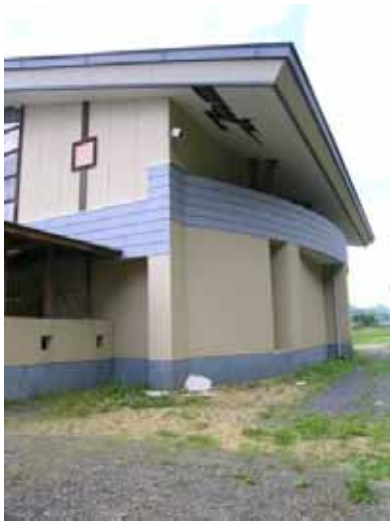
(a) 軒天外装材落下
