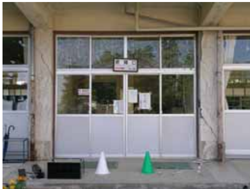
(c) 1階出入口脇の柱の損傷
