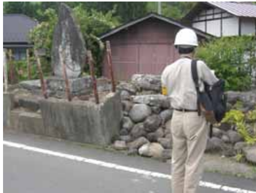
(a) 石碑基部の崩壊
