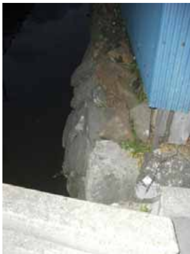
(a) 擁壁はらみ出し
