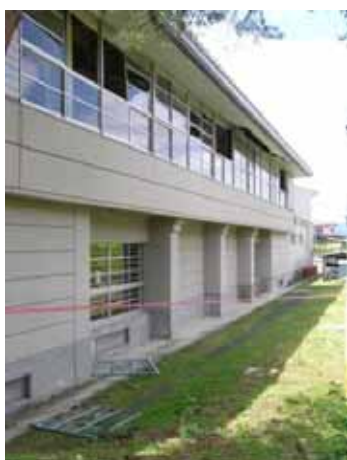
(c) 北側被害状況
