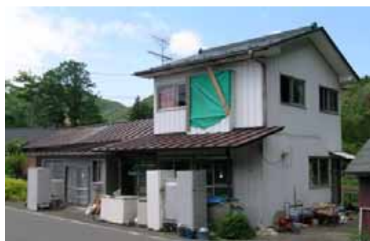
(b) 住宅の窓の損傷
