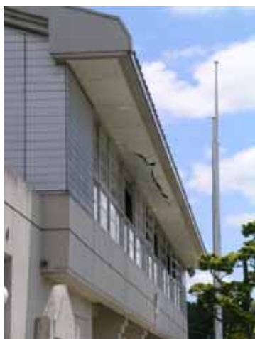
(a) 南側被害状況
