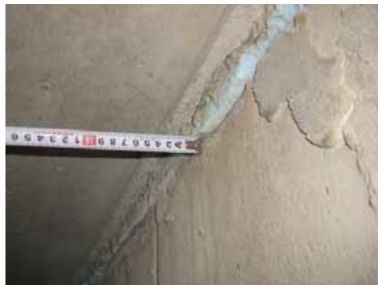
図-5.4.6 シール材(スチレンボード:水色)と免震層周囲の擁壁とのずれ(北に1.5~2cm程度)
