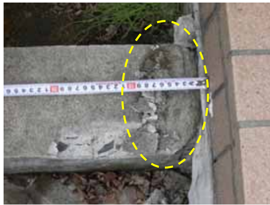
図-5.4.9 免震層犬走り (茶色タイル部) の破損 (5 ~ 10cm程度)
