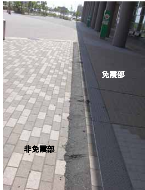
(b) 舗装の損傷（補修済み）
