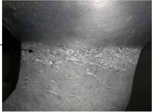
(b) 鉛ダンパー屈曲部のささくれ状の変状
