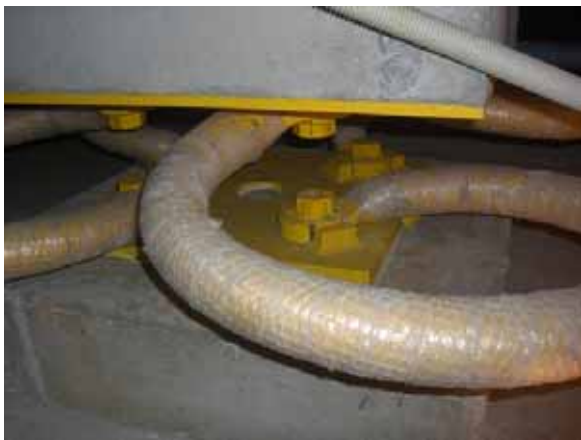
(c) 鋼材ダンパー及び塗料のはがれ
