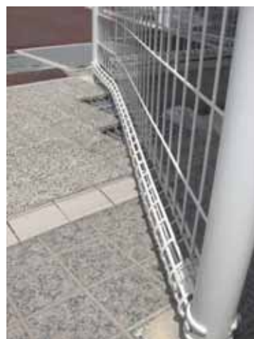
(b) 侵入防止柵のゆがみ
