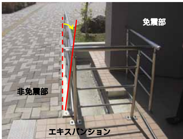
(a) 金属柵の傾斜
