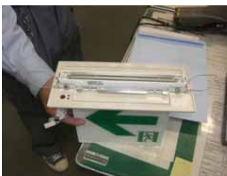
図-5.4.5 落下した誘導灯
