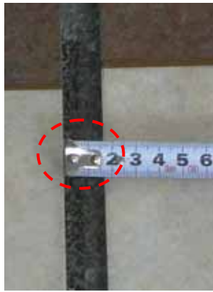
(b) 廊下内装のずれ (東西約1.5cm)
