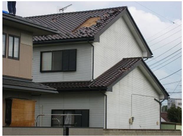
写真 24 屋根瓦のずれ
