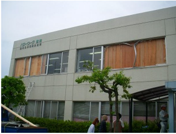
写真6 2階窓の破損（南西からみる）
