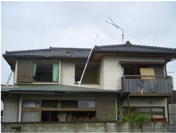
写真 23 開口部の破損とテレビアンテナの曲がり
