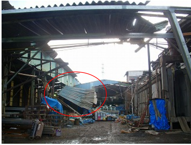
写真 12 工場内部の状況（屋根ふき材の飛散）
