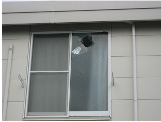
写真 27 窓ガラスの飛来物衝突痕
