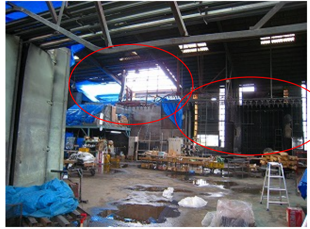
写真 13 工場内部の状況（屋根ふき材等の剥離）
