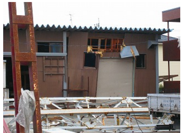
写真 16 作業用倉庫の壁面の損傷
