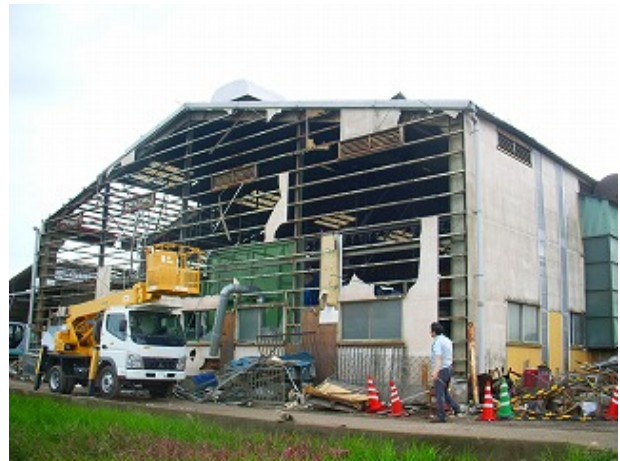
写真9 壁面の被害状況（北東からみる）
