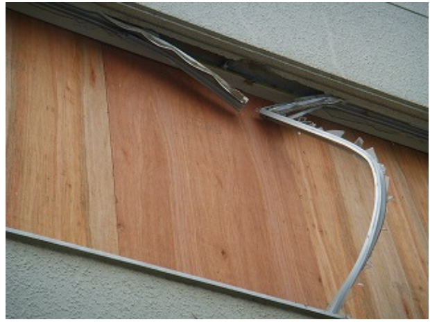
写真7 窓サッシの変形
