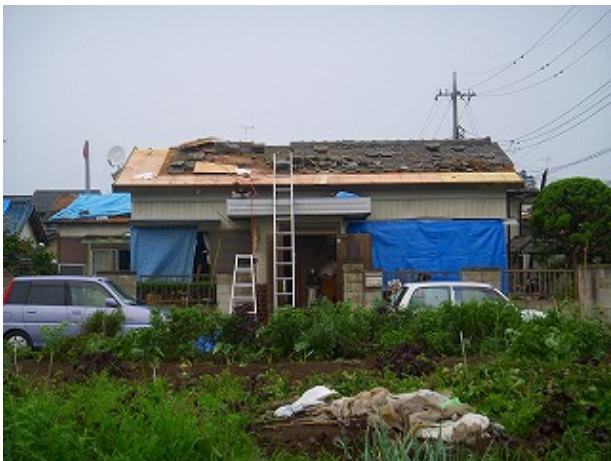
写真 25 屋根瓦のずれ
