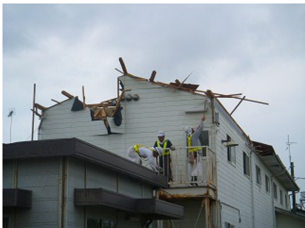
写真 17 小屋組の被害状況
