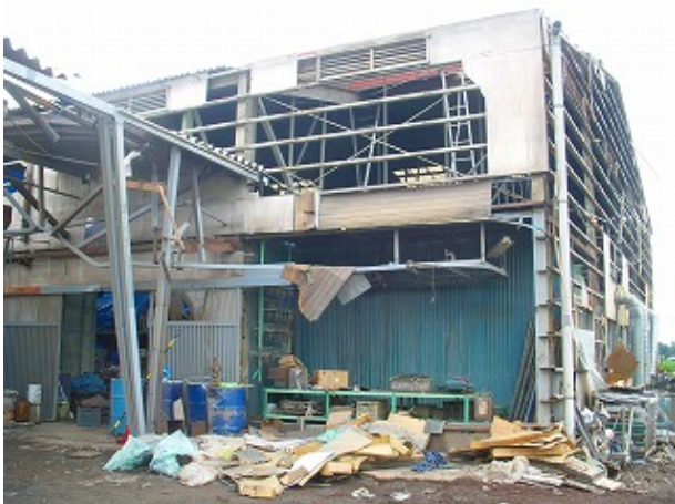
写真10 壁面の被害状況（南東からみる）
