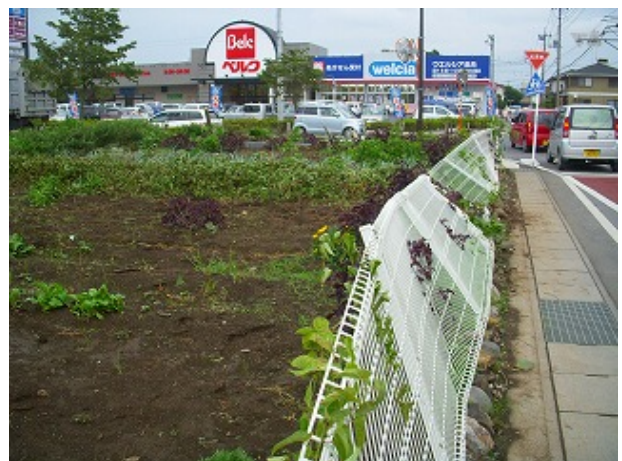
写真 31 フェンスの変形
