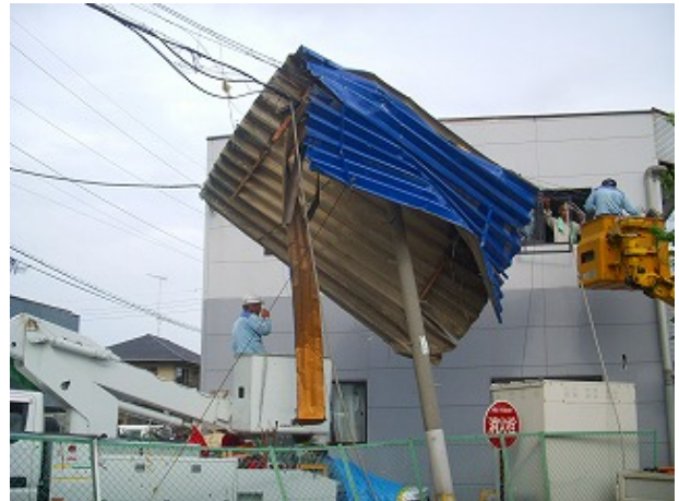
写真 29 鋼板製屋根の飛散
