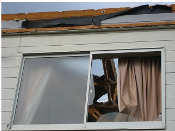
写真 19 窓ガラスの損壊
