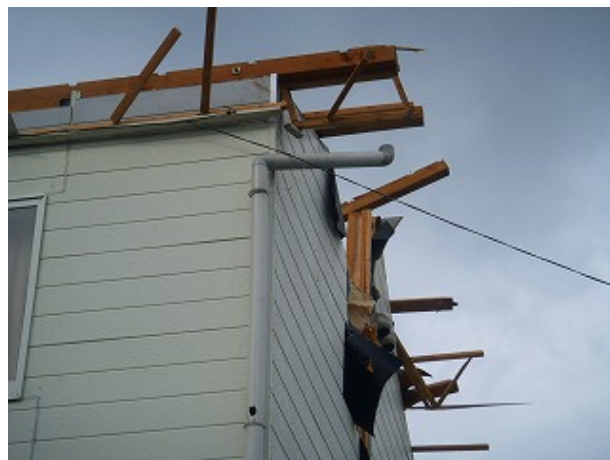
写真 18 小屋組（けらば部）の被害状況
