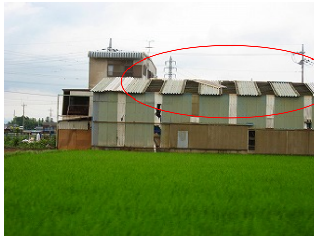
写真 14 屋根ふき材の剥離
