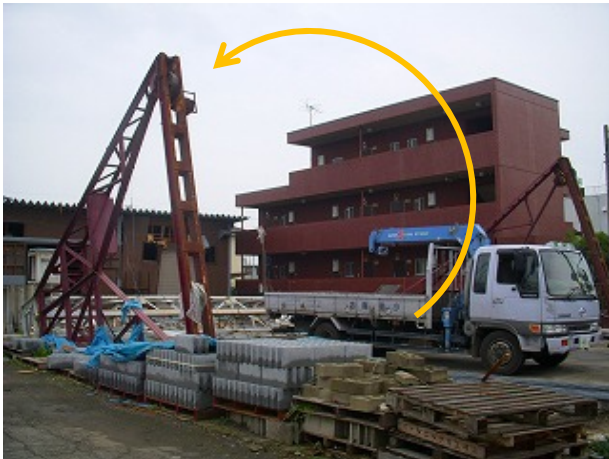
写真 28 滑節構造をもつ移動式クレーンの転倒
