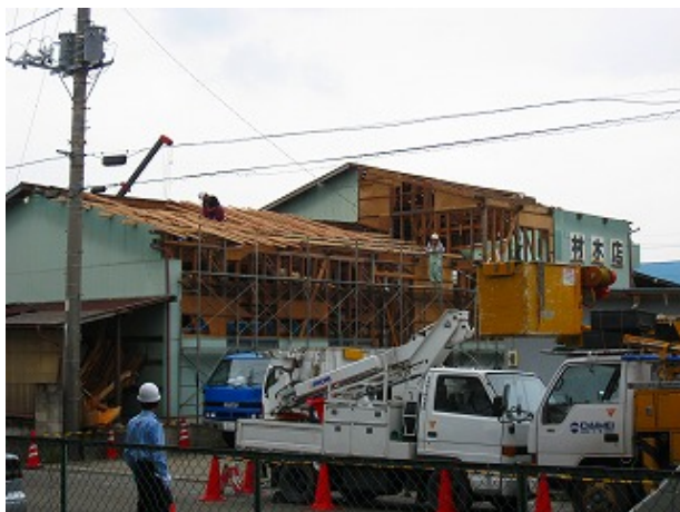
写真 15 材木店の屋根と壁面の被害（北東からみる）
