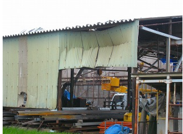
写真11 壁面の損傷状況
