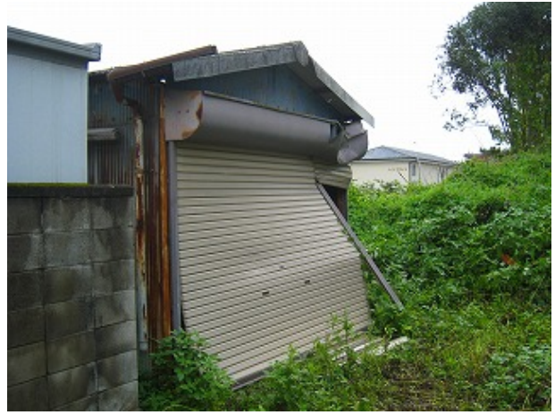
写真 22 シャッターの外れ
