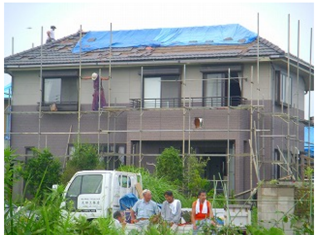
写真 26 屋根瓦のずれと壁面の飛来物衝突痕
