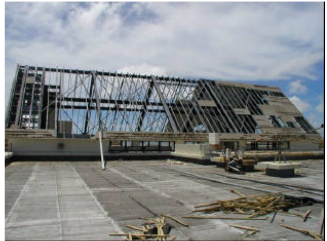
写真 29 切妻屋根面の被害（北東からみる）
