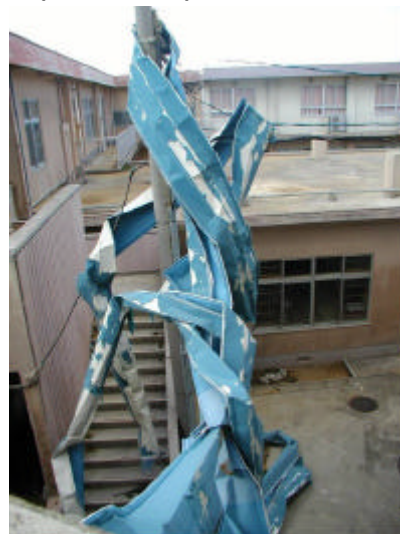
写真 20 屋根ふき材の飛散
