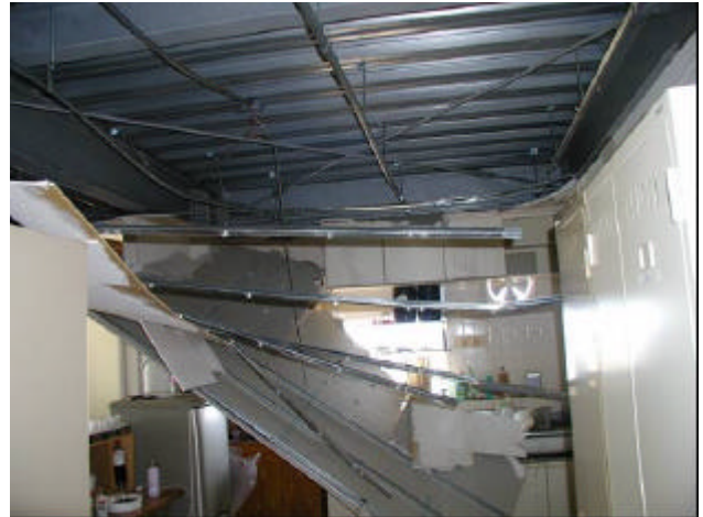
写真 46 事務室内の天井仕上げ材の損傷
