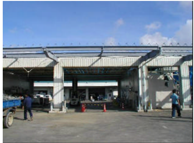
写真 40 屋根底部分の屋根ふき材の飛散（北西からみる）
