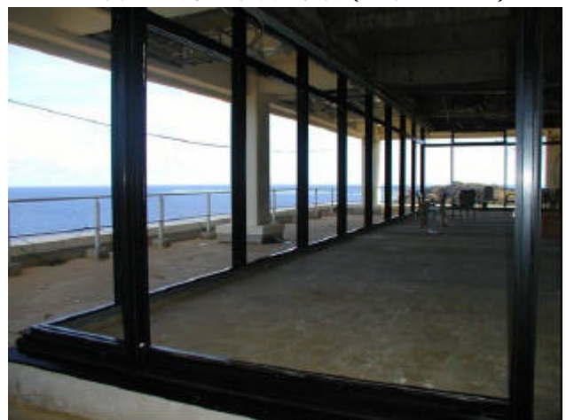
写真 31 海に面した 2 階窓ガラスの被害
