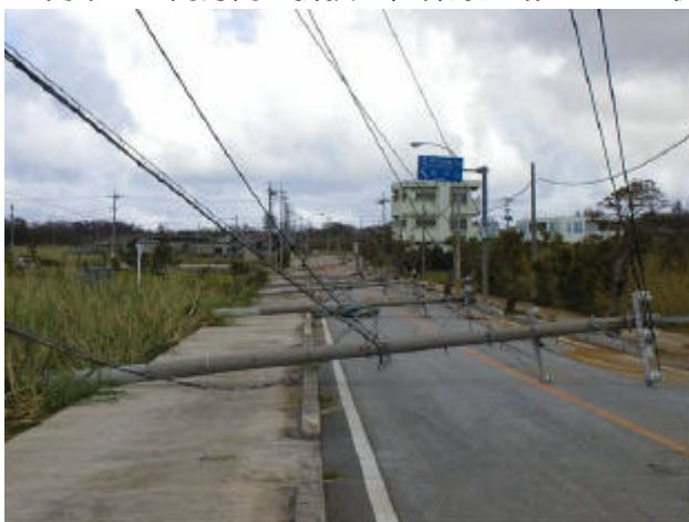
写真 51 平良城辺線沿いの電柱の折損 1
