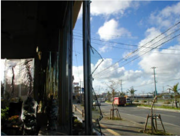
写真 26 窓ガラスの損傷（南からみる）
