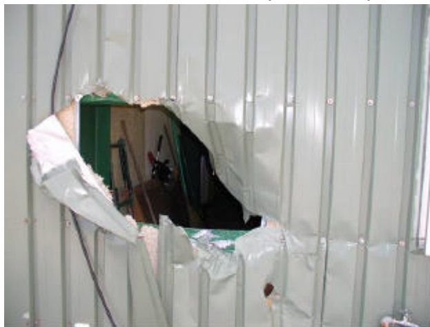
写真18 北側壁面の損傷
