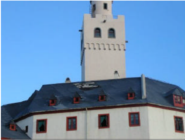
写真32 屋根ふき材の飛散（北からみる）
