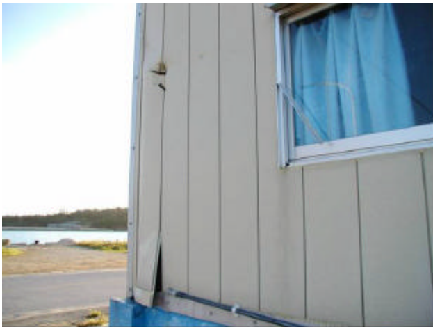
写真36 壁面隅角部の浮き上がり（南西からみる）
