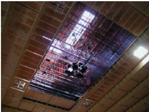
写真15 天井中央部の破損
