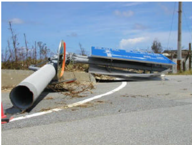
写真 63 道路標識の折損（保良西里線沿い）
