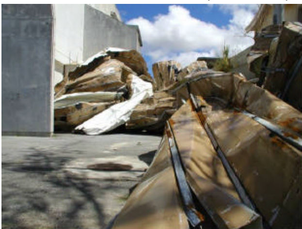
写真13 剥離した屋根ふき材（南西からみる）
