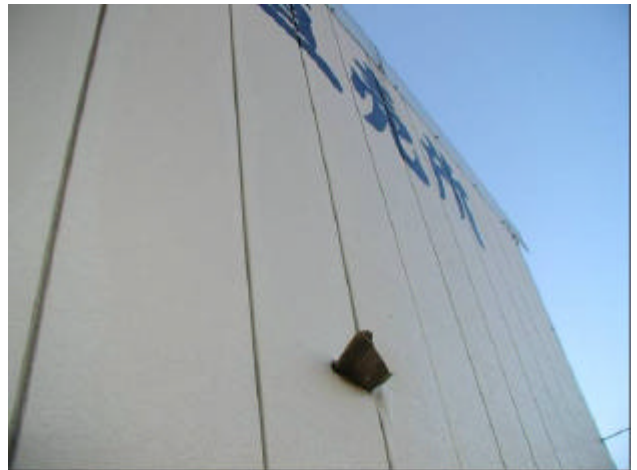
写真37 飛来物による損傷（南西からみる）
