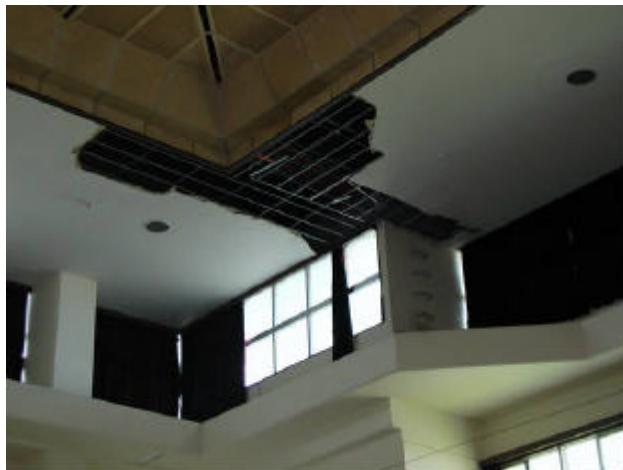
写真16 天井仕上げ材の破損
