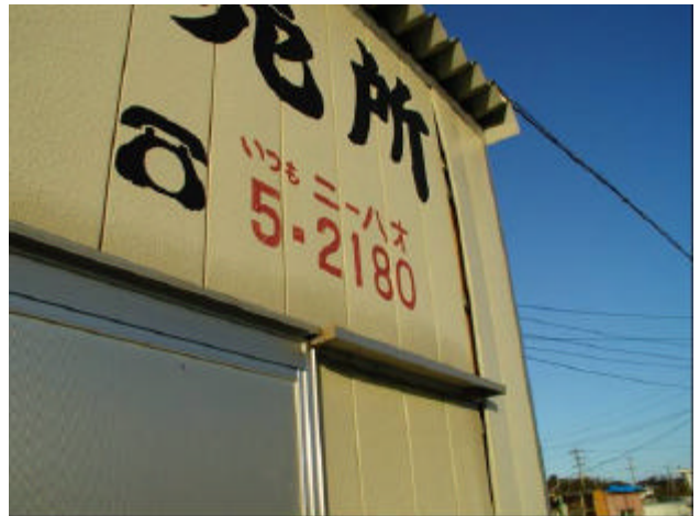
写真35 壁面隅角部の浮き上がり（北西からみる）
