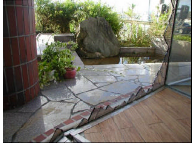
写真 27 窓ガラスの損傷（北からみる）
