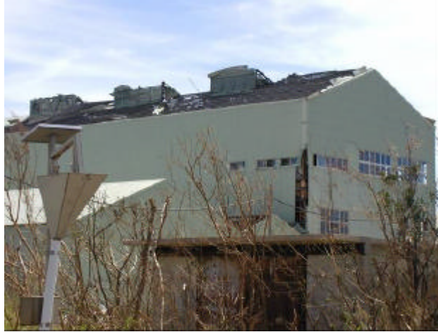
写真 38 切妻屋根及び壁面隅角部の被害（北東からみる）
