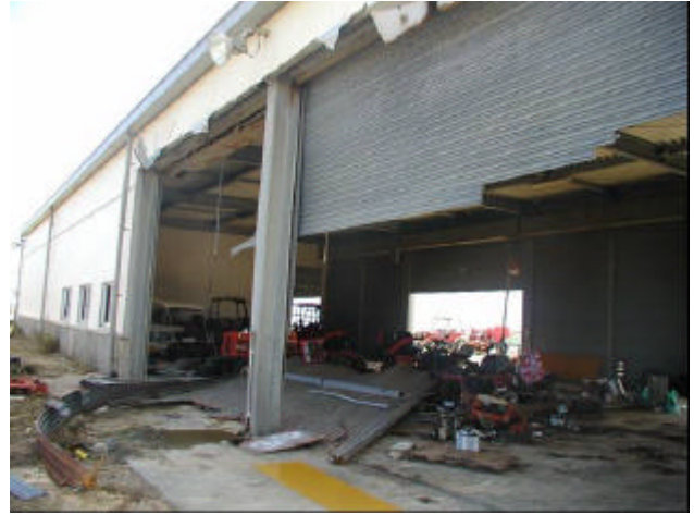
写真 44 開口部の損傷（北からみる）
