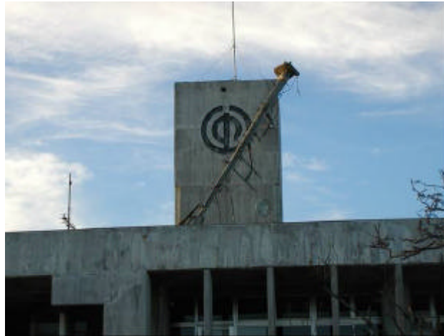
写真 23 通信用鉄塔の転倒
