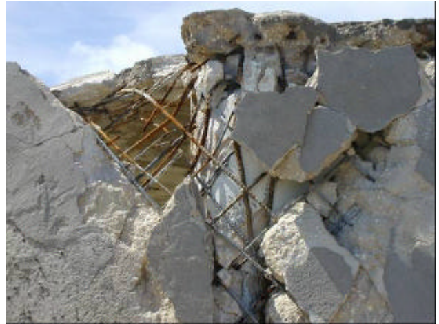
写真 6 屋根版の倒壊
