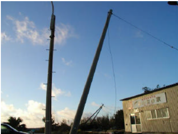
写真34 鮮魚直売所前の電柱の傾斜（西からみる）
