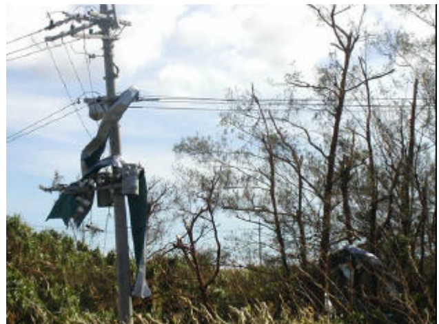
写真 42 貨物庫南西の電柱にからみつく屋根ふき材
