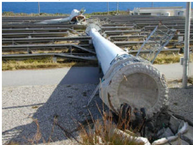
写真 60 タワー部の倒壊（北からみる）
