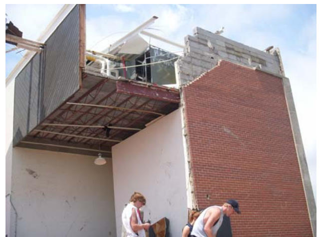
写真6 壁の倒壊部分
