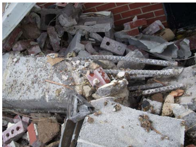
写真7 鉄筋が挿入された構造部材の破壊
