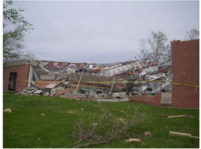
写真4 教室の壁の倒壊と屋根の崩落
