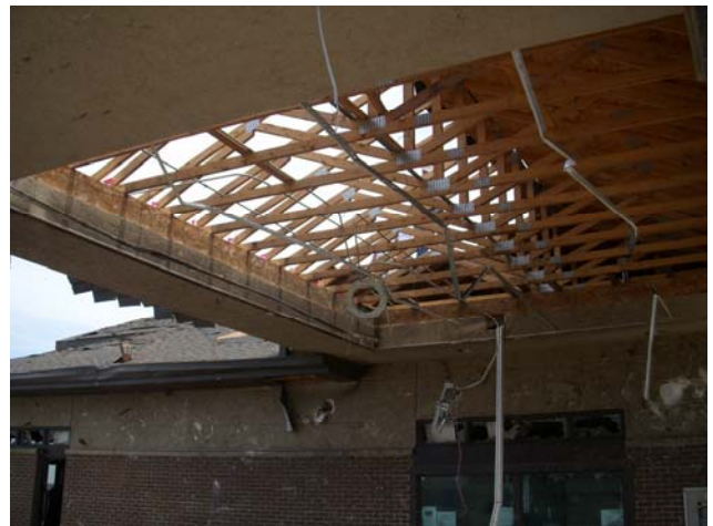
写真12 屋根ふき材と軒下面の飛散（銀行B）
