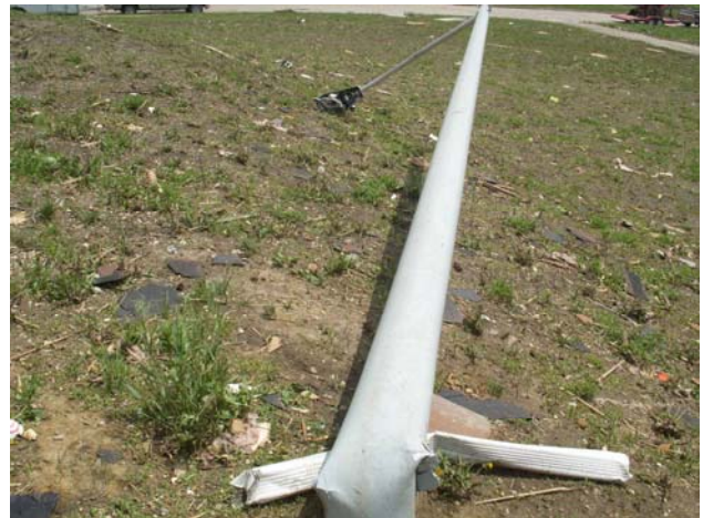
写真 48 街路灯の折損
