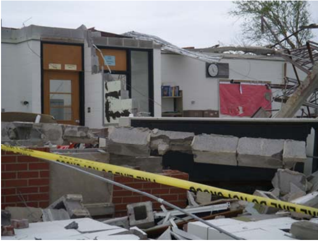
写真3 教室の壁の倒壊
