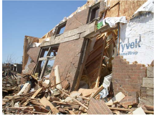
写真10 壁の倒壊（銀行A）
