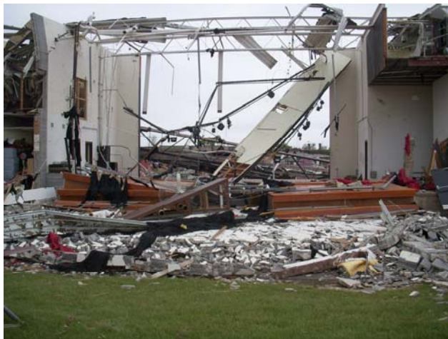
写真5 壁の倒壊と屋根の崩落
