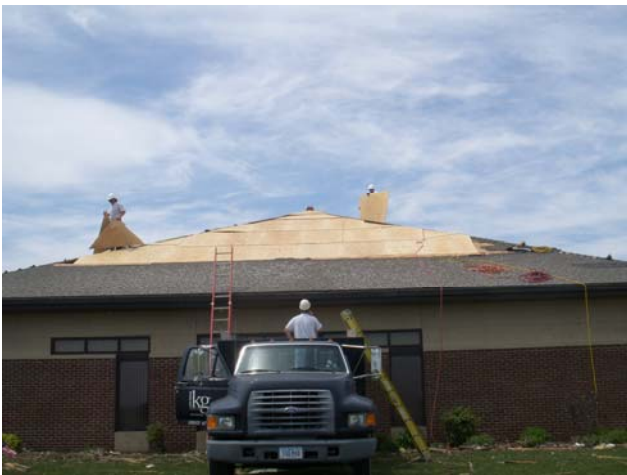
写真11 屋根ふき材の飛散（銀行B）
