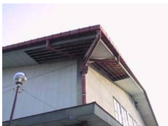
写真2 軒天井の損傷(佐賀県竜巻)
