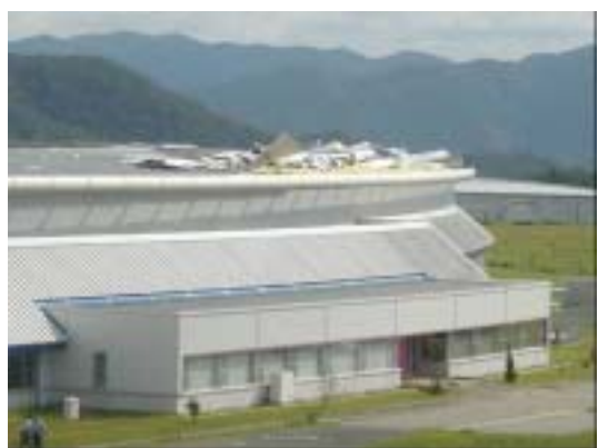
写真3 鋼板製屋根ふき材の損傷(台風0416号)
