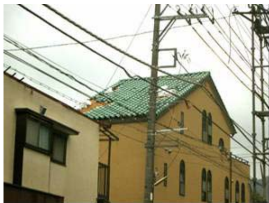
写真1 瓦の飛散(台風0422号)
