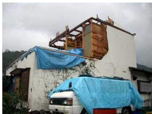
写真5 木造住宅の小屋組被害(台風0422号)
