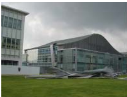
写真4 鋼板製屋根ふき材の飛散(台風0418号)
