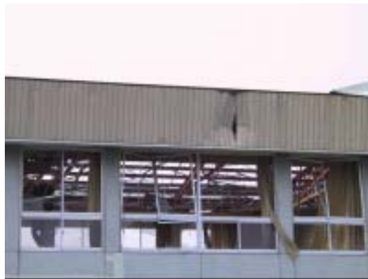
写真6 農協施設の小屋組被害(佐賀県竜巻)
