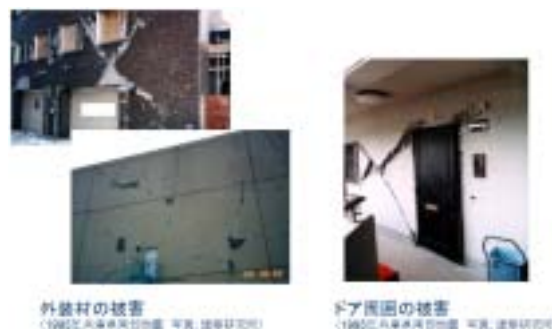
写真 1 1995 兵庫県南部地震における被害
