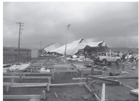
写真1 被災直後の新佐呂間トンネル作業事務所・宿舎 (国土交通省北海道開発局提供)
