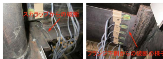
図 7 長継続時間地震動による梁端部の破断
