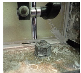
写真 2 面外変形による四周シール部の切れ
