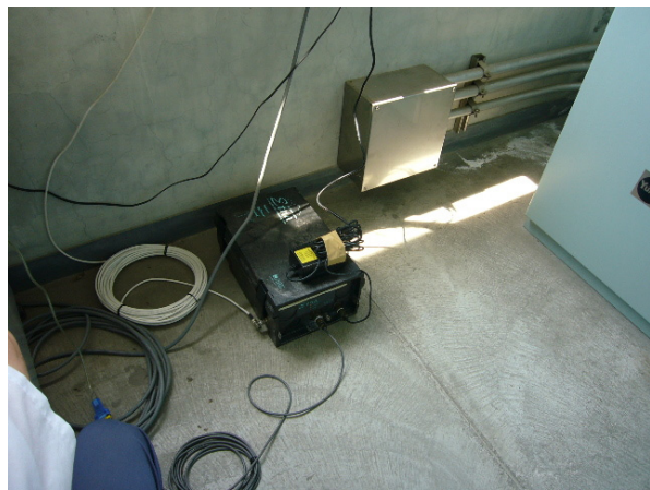
写真-3.4 柏崎市役所本館 7F 設置状況
