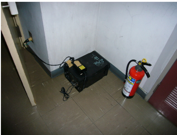
写真-3.3 柏崎市役所本館 B1F 設置状況
