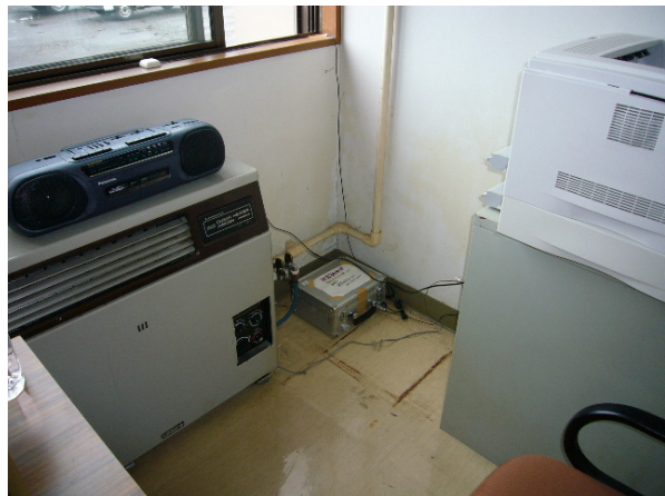
写真-3.8 西山町事務所 1F 設置状況
