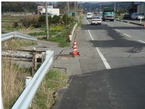
F-f 路肩に生じた亀裂
