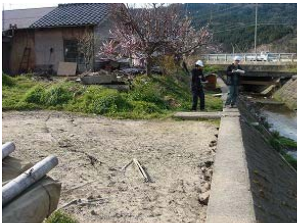
F-e 護岸脇の半円状の亀裂
