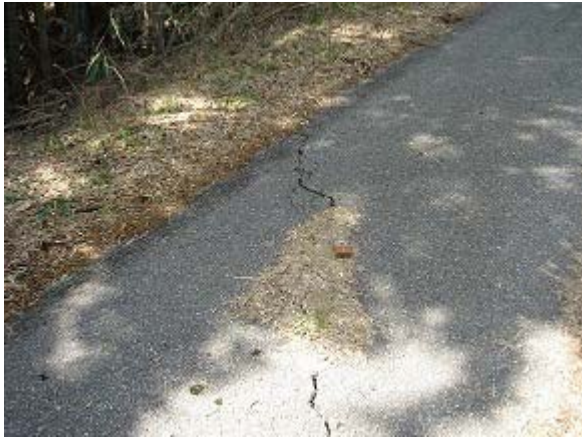
B-c クラックと道路脇の状況
