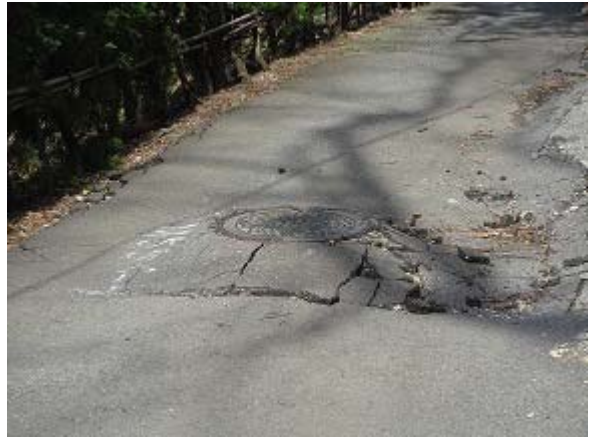
E-b マンホール脇の沈下
