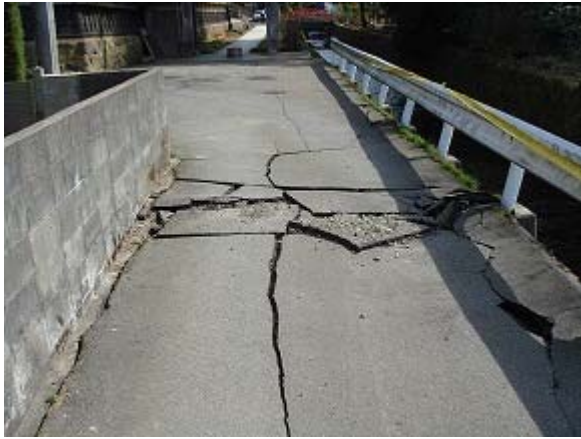
E-a アスファルト路面のクラック
