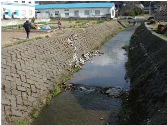
F-b 護岸の破壊状況 1
