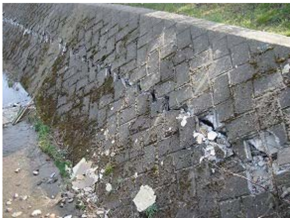
F-d 護岸の破壊状況 3
