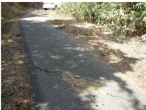
B-a 路面のクラックの状況
