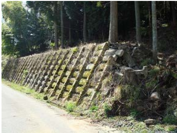
A-b 井桁組擁壁の肩部の損傷 (地震動によるもの)
