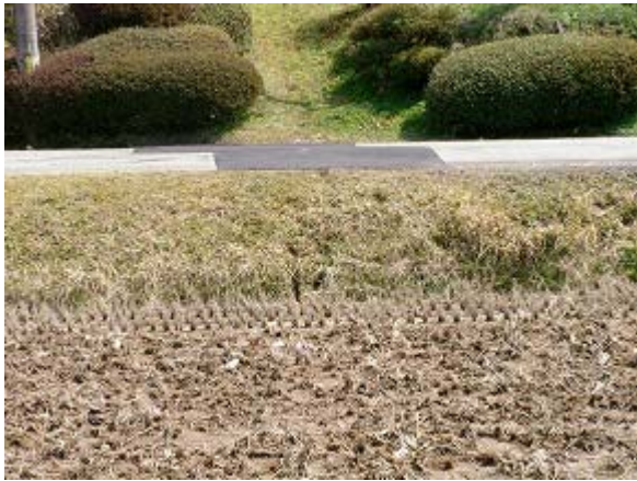
C-c 盛土側面のクラック
