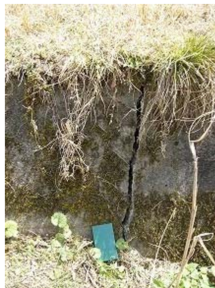
C-h 水路壁に生じたクラック
