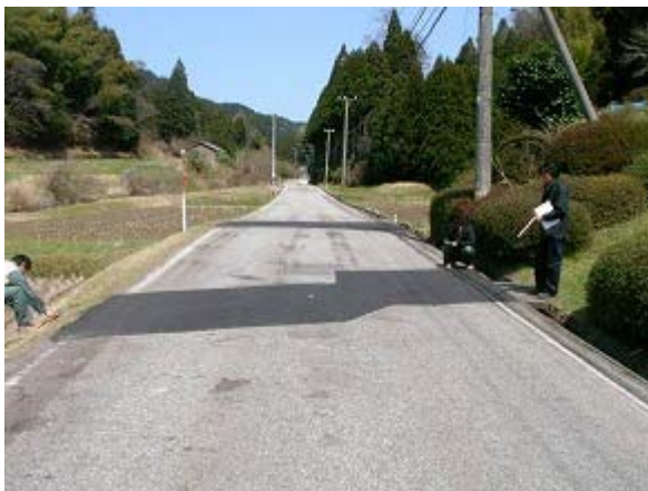
C-a 路面のクラックの補修跡
