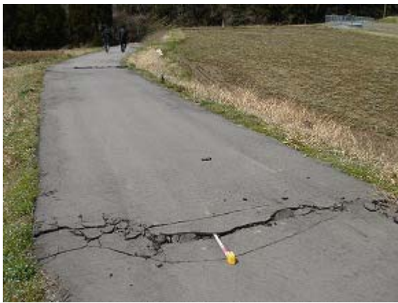
D-e 道路に生じたクラック
