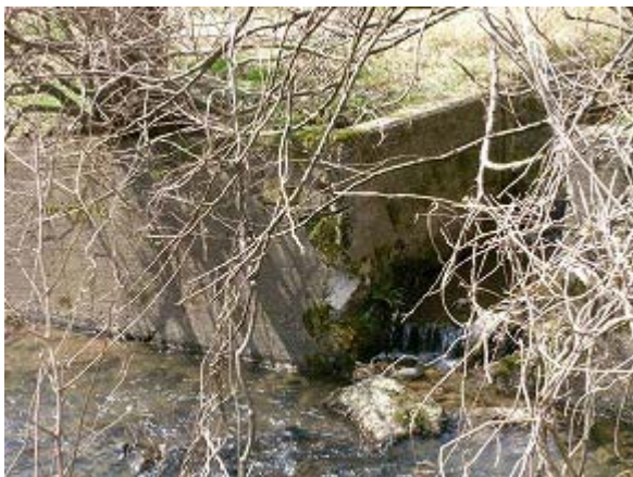
C-g 水路角の崩落
