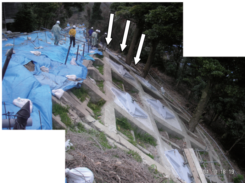
写真-3.2.9 輪島市門前町鹿磯における施設の被災状況（南東側斜面） 図-3.2.15 の①の方向から撮影（矢印が破断したアンカー）
