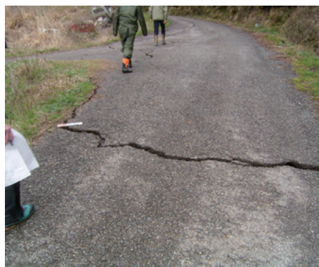
写真-3.3.8 北側ブロック頭部付近の農道に発生した開口亀裂
