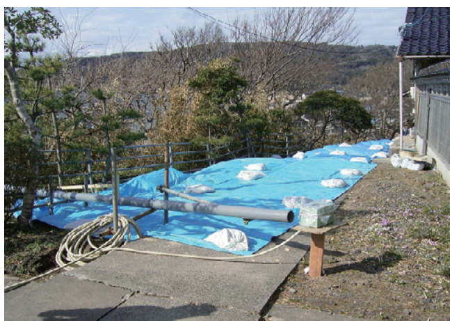
写真-3.2.11 輪島市門前町黒島地区の被災状況（斜面上部の平坦地）
