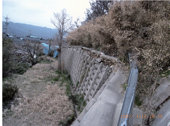
写真-3.2.13 枠組擁壁工と落石防護柵の被災状況 (のり枠工はこの上部に設置されている)
