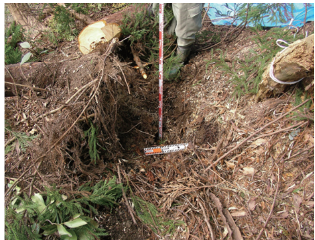
写真-3.3.14 地すべり頭部の陥没
