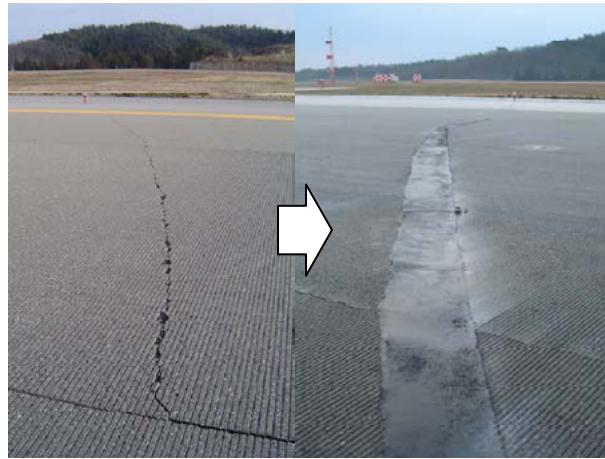
写真-9.1 能登空港滑走路クラック（左：発生クラック、右：応急復旧による補修）
