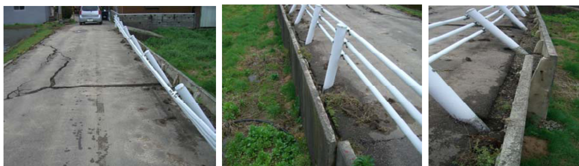
写真-10.6.11 L型コンクリート擁壁の被害例
