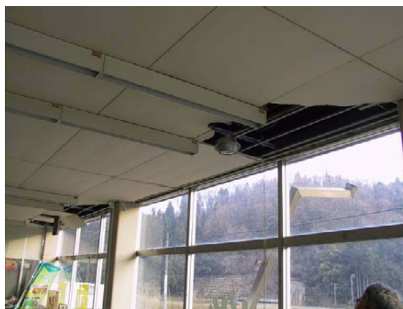
写真-10.5.12 せっこうボードの破損
