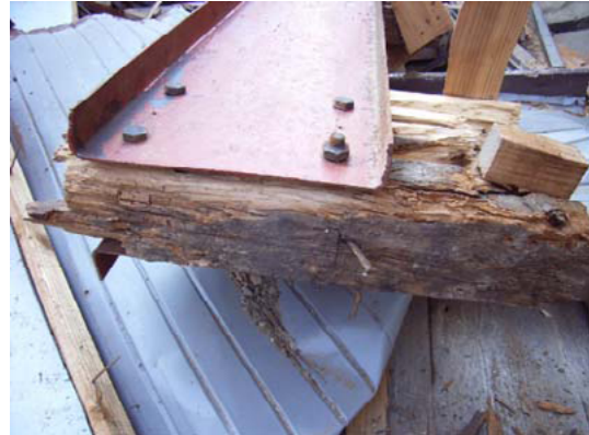
写真-10.4.2 倒壊した家屋（写真-10.4.1）の腐朽した部材
