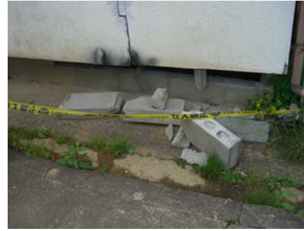
写真-10.6.8 ブロック基礎による増築部の 被害
