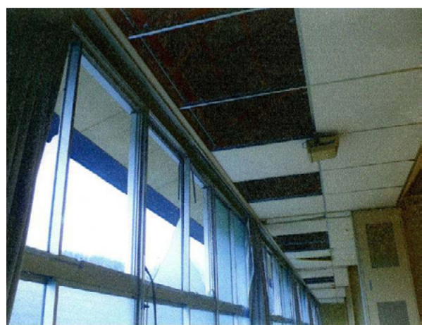
写真-10.5.10 被災直後のランニングロード上部の様子（加賀市役所提供資料より）
