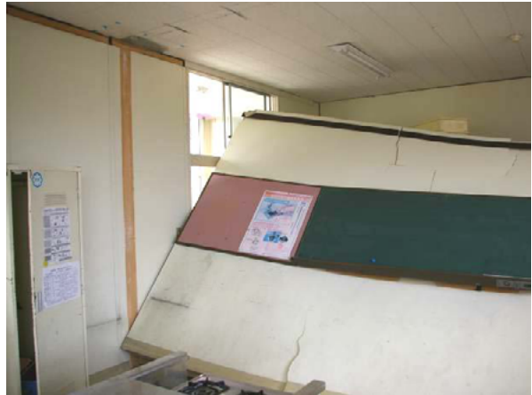
写真-10.5.8 転倒した間仕切り壁
