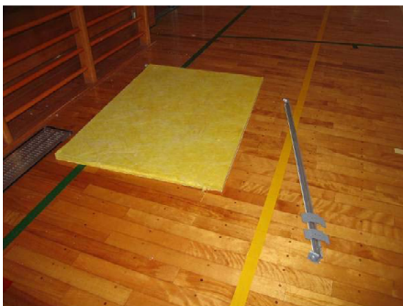
写真-10.5.2 脱落した天井部材
