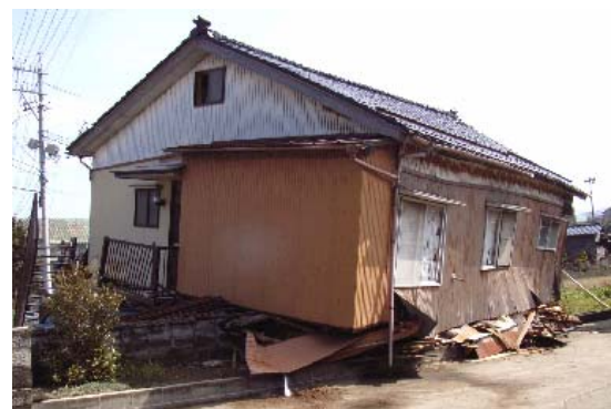
写真-10.4.4 輪島市小伊勢町で倒壊した作業場兼住宅
