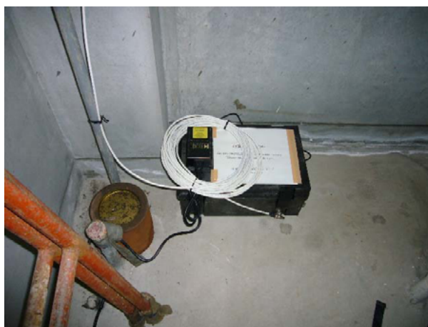
写真-10.3.3 輪島市役所1階強震計設置状況
