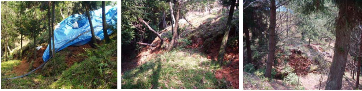
写真-10.6.14 崩壊した斜面の先端付近の状況
