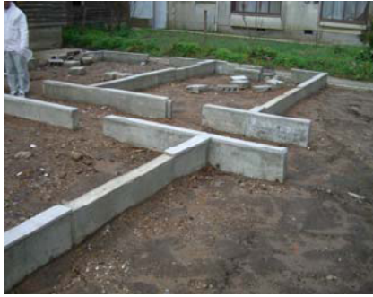
写真-10.6.7 アンカーボルトが乏しい基礎 無筋コンクリートの基礎
