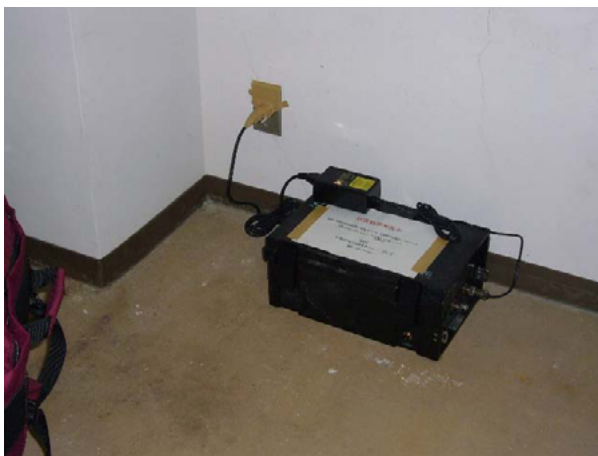
写真-10.3.7 門前支所地下1階強震計設置状況
