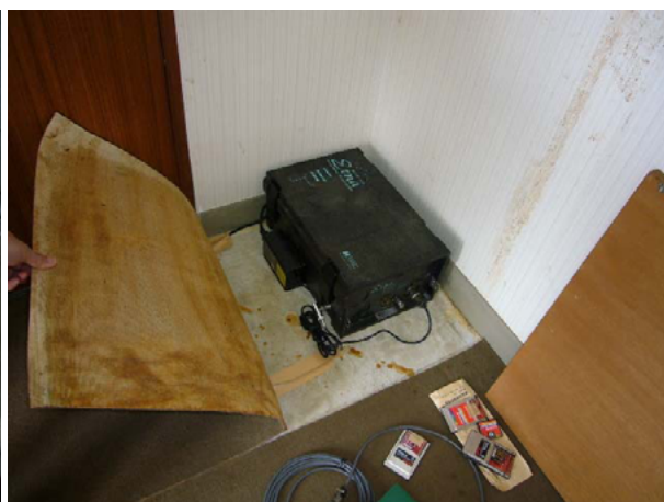
写真-10.3.4 輪島市役所4階強震計設置状況
