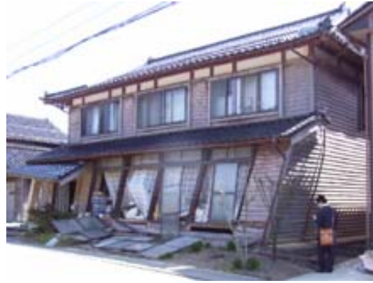
写真-10.4.10 通りと平行方向に大きく傾いた家屋
