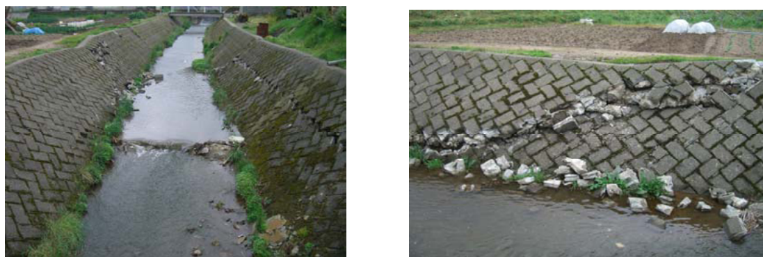
写真-10.6.12 ブロック積み擁壁の被害（門前道下地区）
