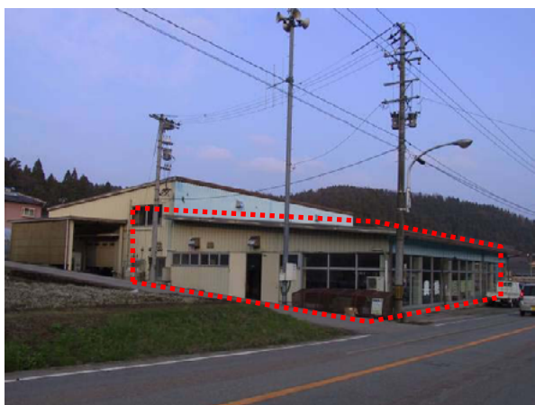
写真-10.5.11 建物F外観（破線部で天井被害を確認）
