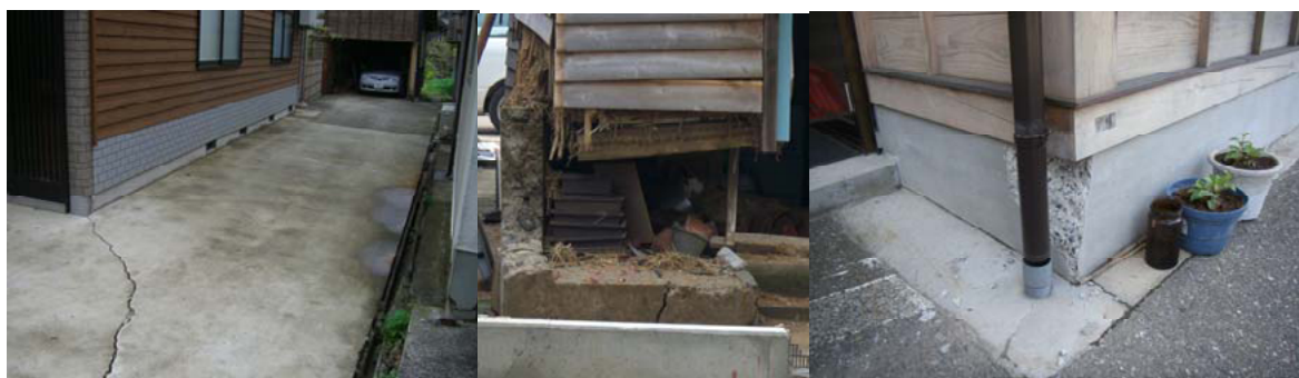
写真-10.6.6 コンクリート基礎の被害
