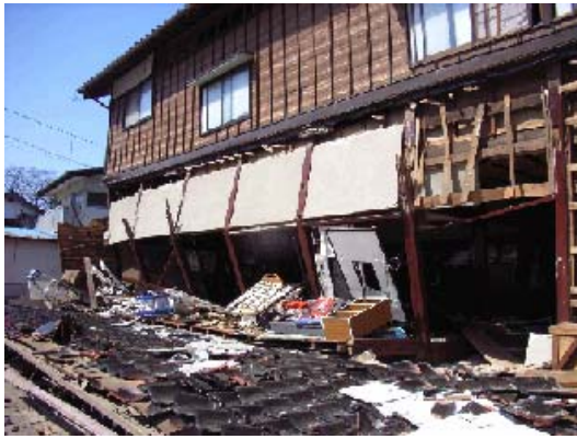
写真-10.4.9 倒壊は免れたが柱が折損するなどの甚大な被害を受けた住宅
