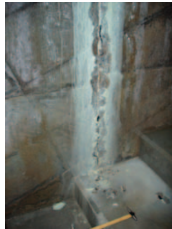
写真-6.19 監査廊内継目 (J-9) 床版の クラックと継目補修モルタルや遊離石灰の剥落状況
