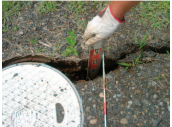
写真-6.6 天端中央のクラック 地震直後（2007.7.16 撮影）（柏崎市提供）
