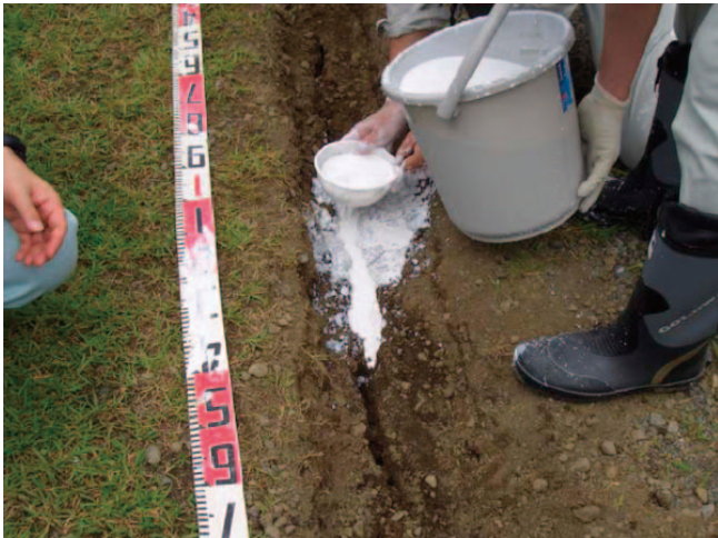
写真-6.12 天端クラックへの石膏注入状況
