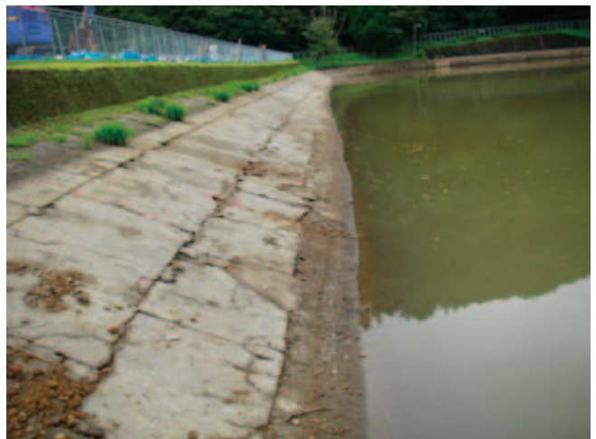
写真-6.10 堤体上流面の張コンクリートブロッ ク（上流張ブロックの隙間から堤体 材料の吸出しが見られる）
