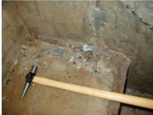
写真-6.17 監査廊内の継目（J-6）における補修モルタルの剥落
