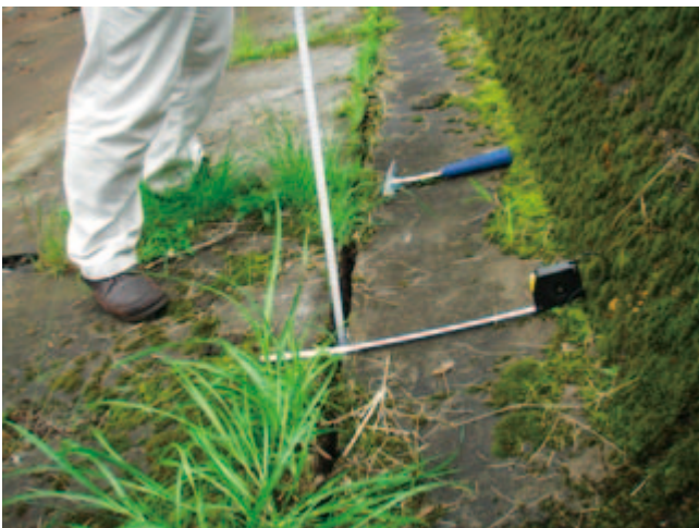
写真-6.9 上流法面張コンクリートブロックの 目地の開き
