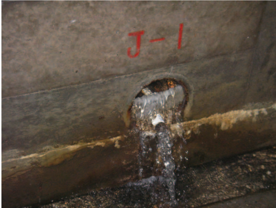
写真-6.4 継目排水孔 J-1 からの漏水 (2007 年 7 月 17 日撮影)
