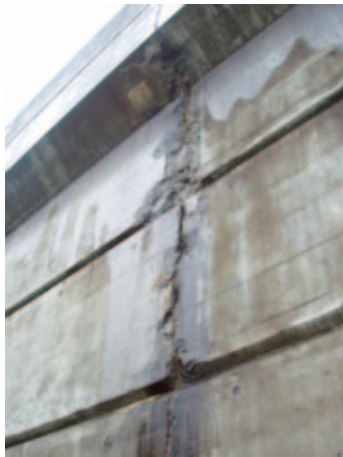
写真-6.18 継目 (J-2) 下流面の剥落跡 (大部分は、2004年中越地震時によるもの)
