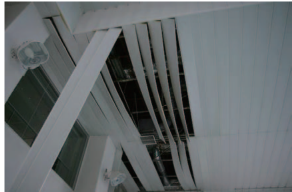
図-8.4.21 落ちかけている天井パネル
