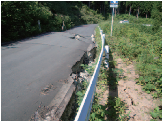
写真-2.2.1 地点aに生じた変状
