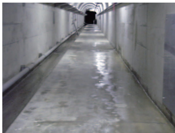
写真-5.24 河床部付近の監査廊の上流側側壁とインバートからのしみ出し
