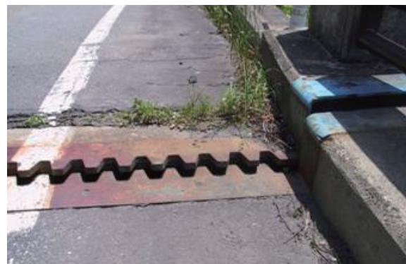
写真-6.9 伸縮装置のずれ
