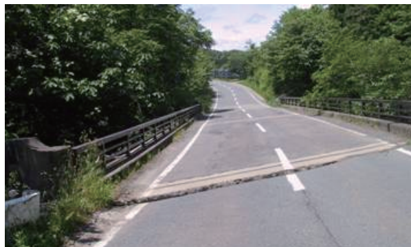
写真-6.7 荒沢橋の被害状況（段差）
