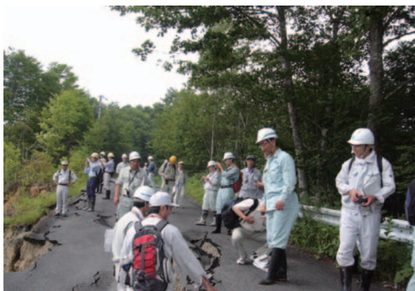
写真-3.4.32 御沢支川の崩壊による市道に生じた亀裂（8月9日撮影）
