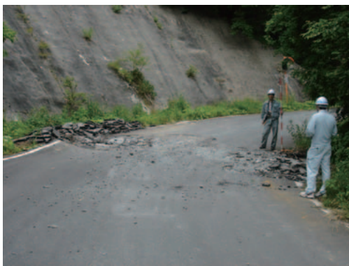
写真-2.2.29 地点 a に生じた変状 北東を望む。走向は N33E、西上がり。左手コンクリート吹きつけ面にひび割れあり。
