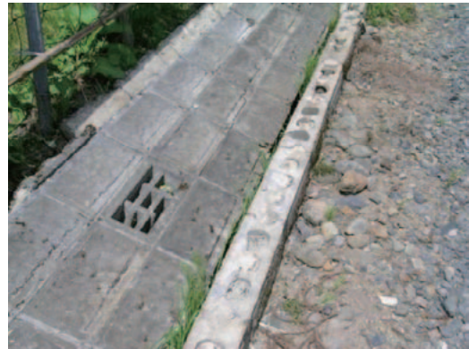
(b) 同詳細 鉄筋は見当たらない
