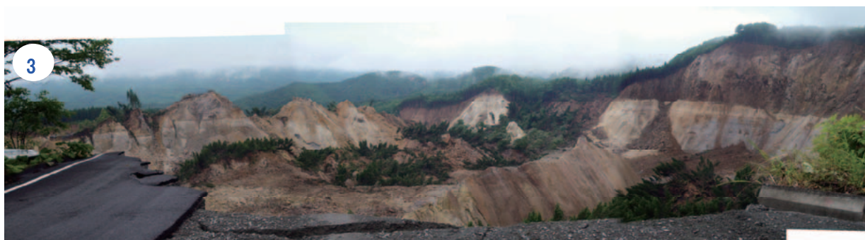
写真-3.4.6 地すべり頭部の寸断された道路下方を望む。写真右の滑落崖の上部は溶結凝灰岩（茶色）が、下部は軽石凝灰岩（薄黄色）が露頭。写真中央～左側の露頭は、地すべり本体から取り残された分離小丘の斜面上側が滑落した面。明瞭な条線が見られる。(6月22日撮影)
