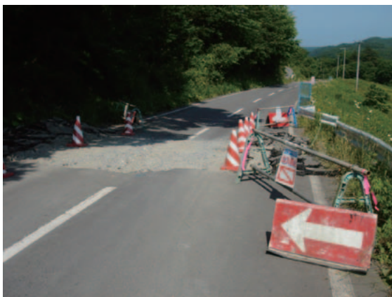
写真-2.2.12 地点iの県道49号線の段差跡
