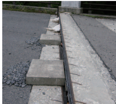
写真-6.48 A1 胸壁天端と上部工との段差
