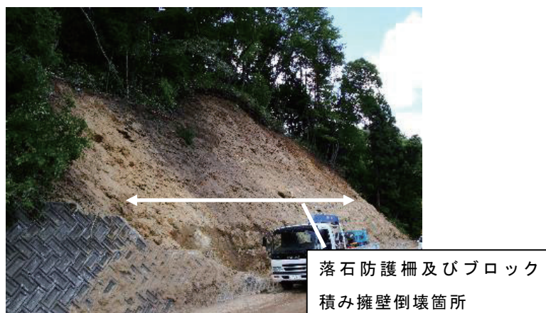
図-7.3.2 一関市巖美町天王～下真坂 ブロック積擁壁上方斜面の表層崩壊
