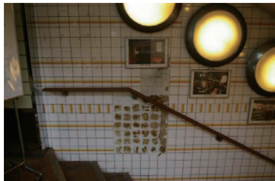
図-8.4.4 地下1階への階段で剥落したタイル
