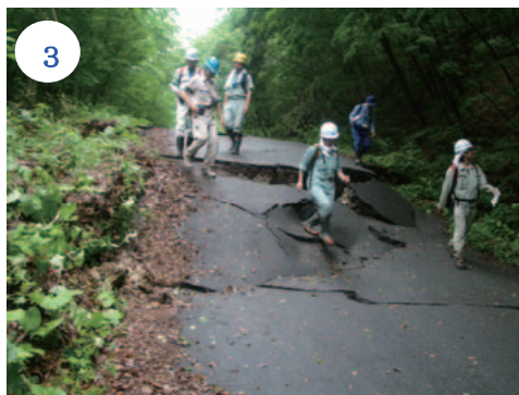
写真-3.4.15 道路に生じた段差道路に見られる2m程度の段差。手前側が地すべりにより相対的に沈下したと考えられる。 (6月21日撮影)
