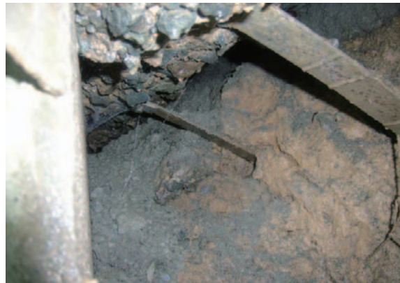
図-7.5.5 国道 398 号線 壁面パネル背 後のストリップの露出
