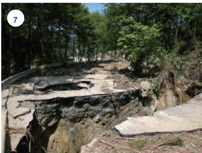
写真-3.4.10 尾根地形部の地すべりブロックにおける左翼道路部の段差を伴う亀裂。本ブロックの発生原因が地震か本体ブロックの衝突かであるかは不明。(6月22日撮影)
