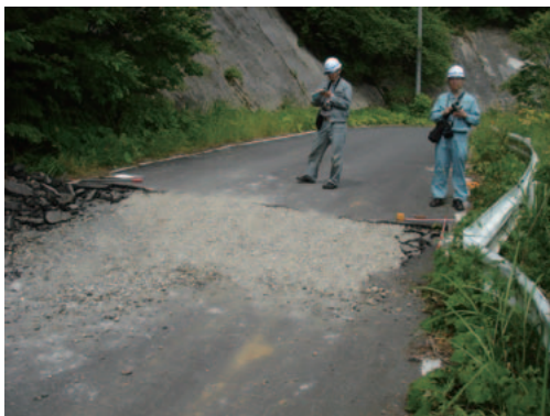
写真-2.2.31 地点 c に生じた変状 西を望む。走向 N10E、約 40cm の西上がり、短縮量は 23cm。
