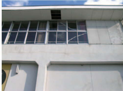
(b) 軒天落下及びブレース座屈
