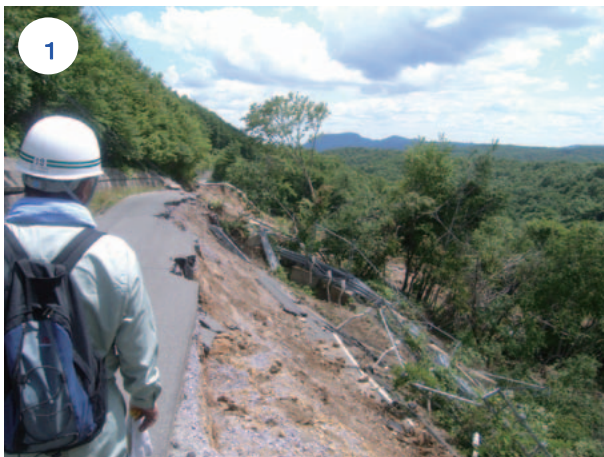
写真-3.4.37 頭部滑落崖（高さ約6m） （7月15日撮影）
