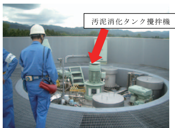
写真-4.8 汚泥消化タンク攪拌機
