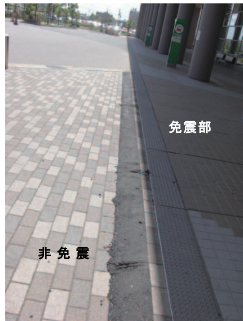
(b) 舗装の損傷（補修済み）
