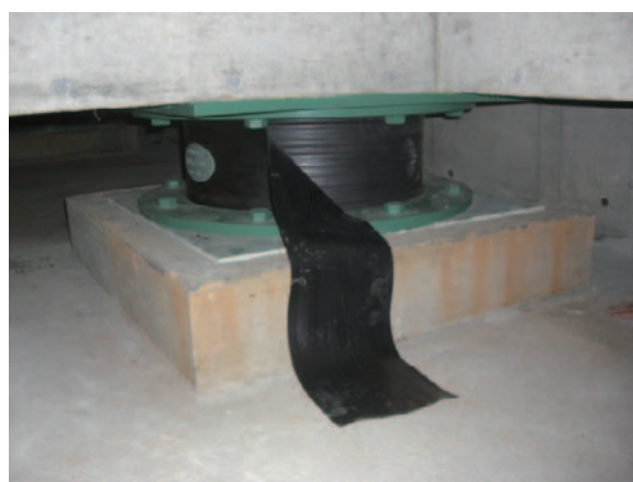
(d) 積層ゴム支承及びカバー脱落 (本震直後の点検時の状況を再現したもの)
