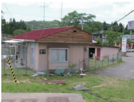
図-8.2.10 栗駒松倉地区の住家被害（妻壁仕上げ剥落）
