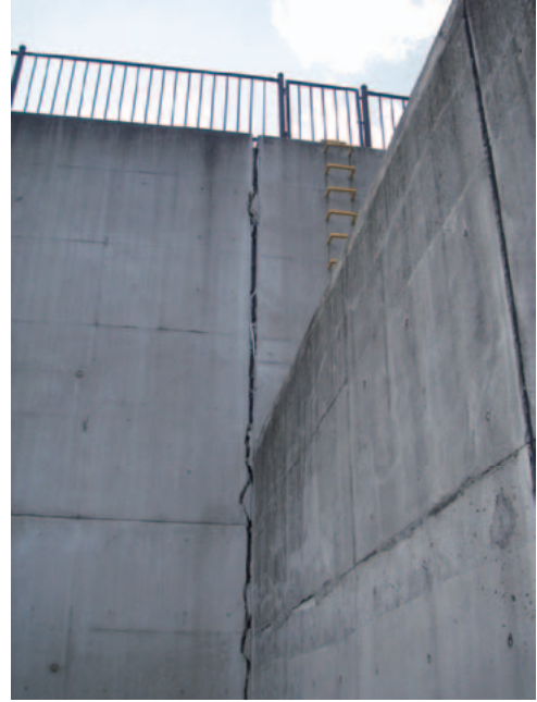
写真-5.45 洪水吐き流入部の導流壁の継目の開き
