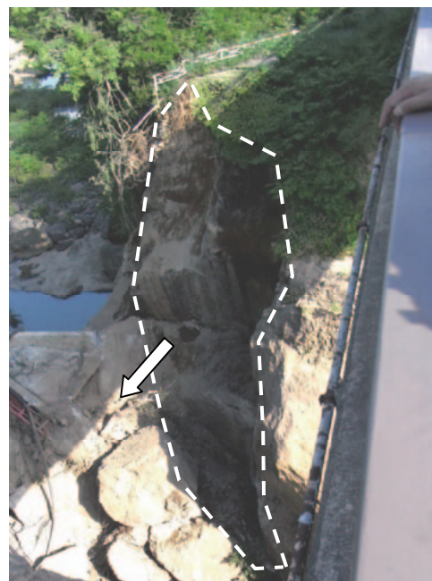
(b) 右岸側の岩盤崩壊
