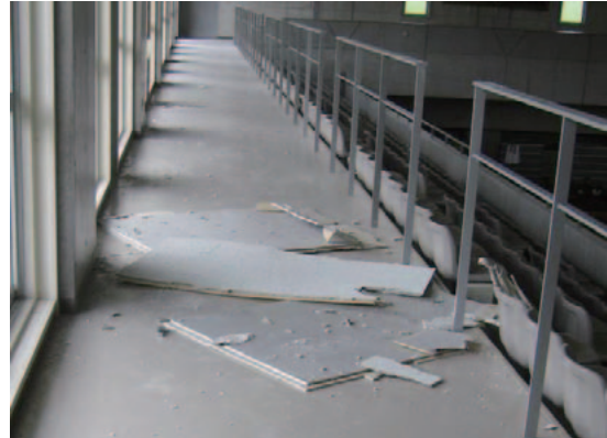
図-8.4.17 脱落した天井版
