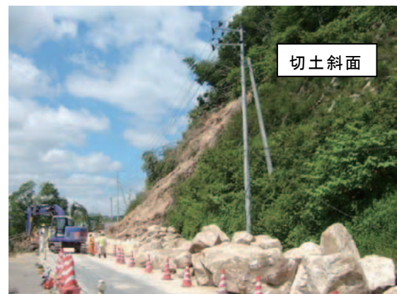
図-7.4.2 軽量盛土箇所、切土斜面の崩壊
