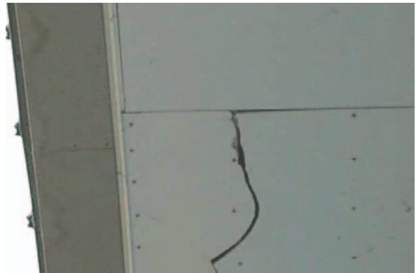
図-8.4.14 軒天の破損及びとめ付け状況
