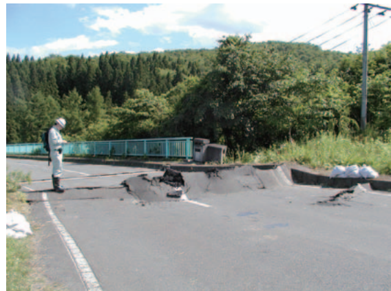
写真-2.2.9 地点jの県道49号線餅転橋アバウト部（奥州市側）の路面座屈
