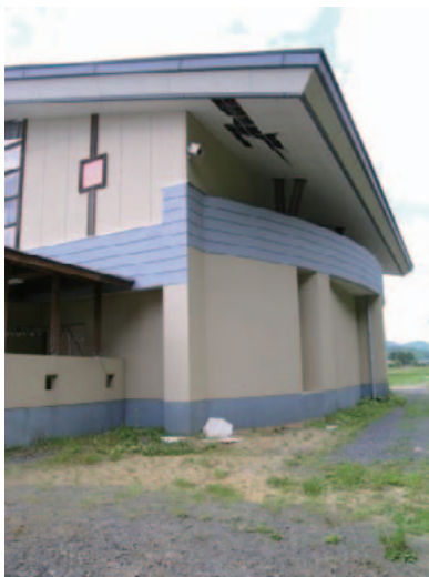
(a) 軒天外装材落下
