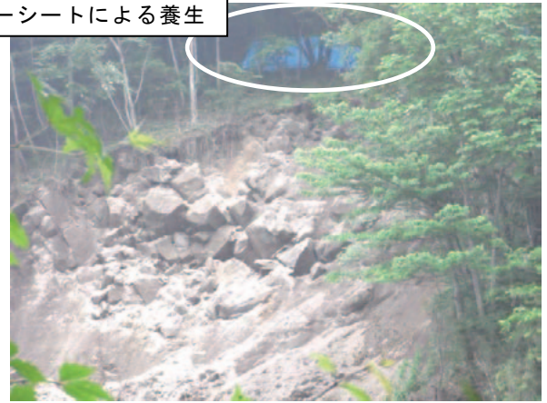
(b) 崩壊発生斜面 (正面から)
