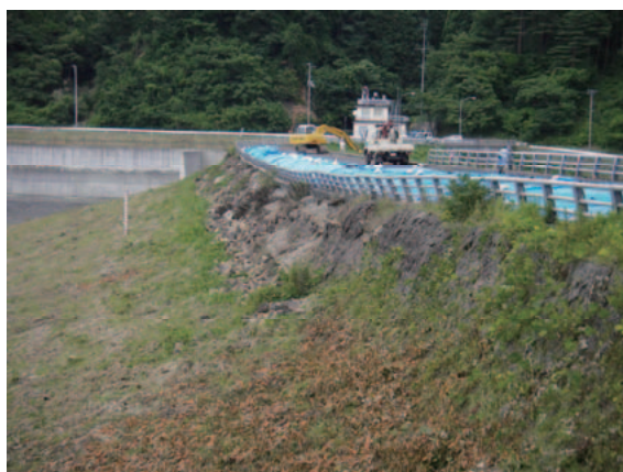
写真-5.42 波返しの石積の損傷状況
