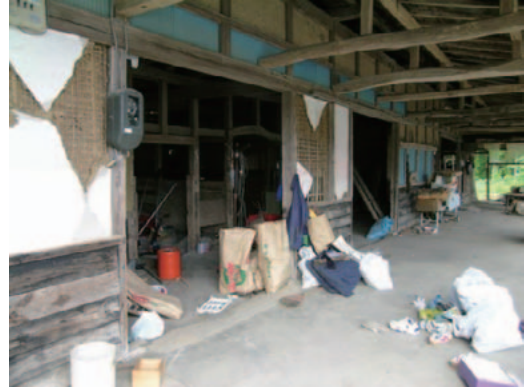
(b) 同住宅牛小屋の土壁剥落
