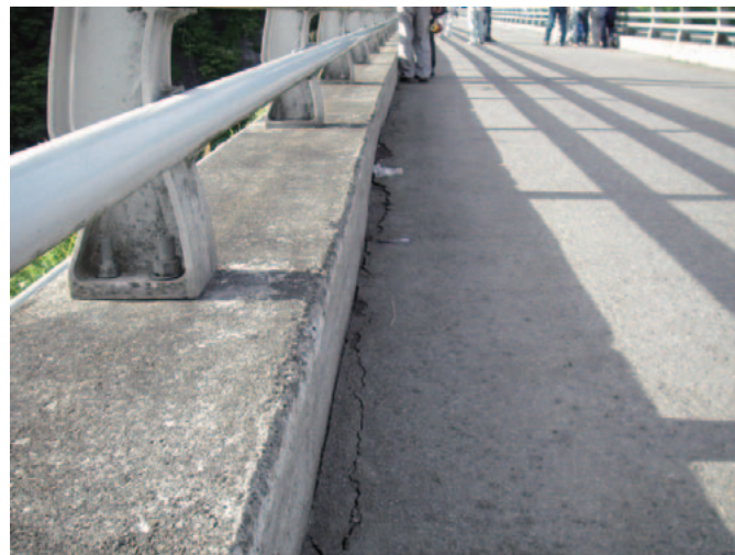
写真-5.27 下流法肩部の高欄に沿って発生した舗装面のヘアークラック
