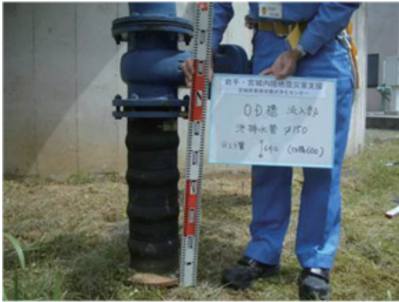
写真-4.9 池排水管用可とう管の伸び状況
