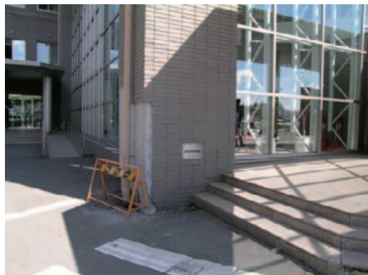
(a) 外装タイルの剥落
