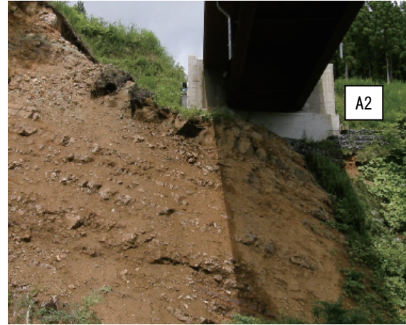
写真-6.42 地山の崩落
