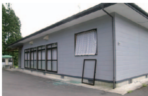
(a) 建築物F（窓サッシ脱落）
