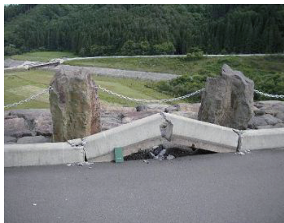
写真-5.32 天端の縁石の破損
