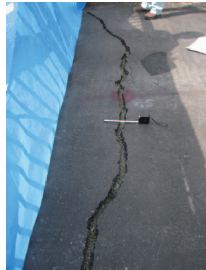
写真-5.52 衣川4号ダム天端舗装の横亀裂（右岸側地山取り付け部）
