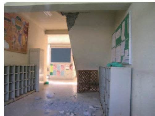
(d) 1階階段上部の損傷
