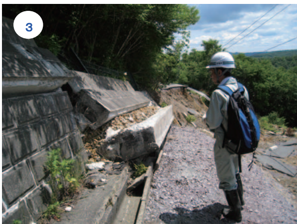
写真-3.4.39 滑落崖上部の擁壁の被災状況 （7月15日撮影）
