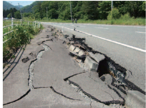
図-7.4.7 栗原市松ノ原における腹付け盛土の被害
