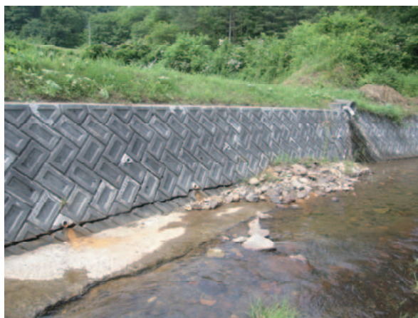
写真-2.2.16 地点 b の河川護岸の亀裂と はらみ出し
