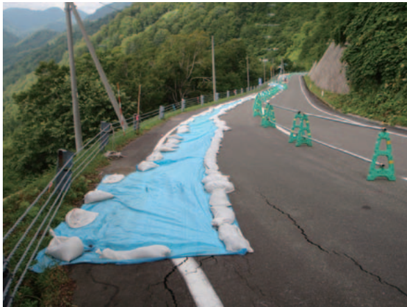
図-7.5.6 国道 342 号線 成瀬村付近におけるテールアルメ壁の被害（路面の被害）
