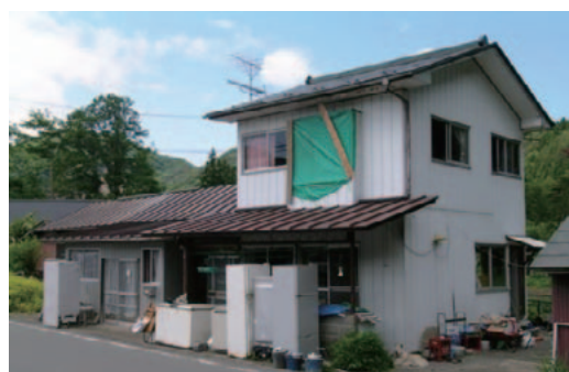
(b) 住宅の窓の損傷
