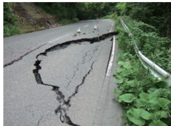
図-7.4.5 築館栗駒公園線、沢埋め盛土の被害
