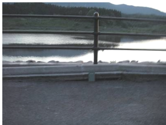
写真-5.30 天端縁石の損傷
