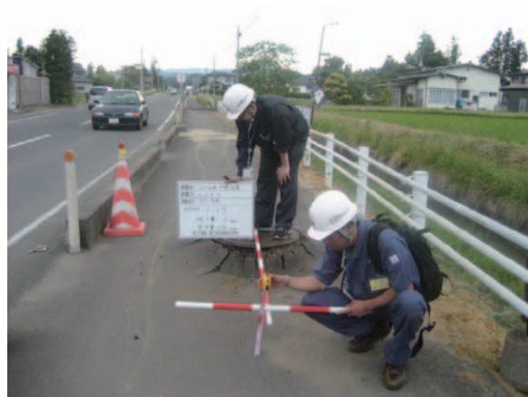
写真-4.7 マンホール浮上がり 29cm 【鶯沢幹線管渠MH.1-13】
