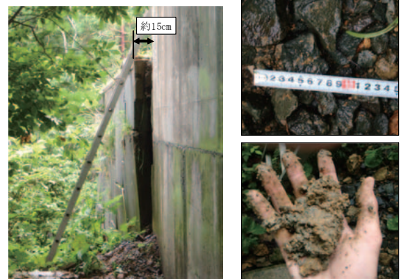
図-7.5.4 国道 398 号線 テールアルメ 壁の傾斜とはらみ出した背後 アルメ壁
