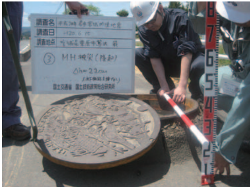
写真-4.1 マンホール隆起【栗原市・鶯沢】
