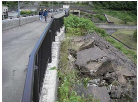
写真-5.5 下流面天端付近のリップラップ材のせり上がり
