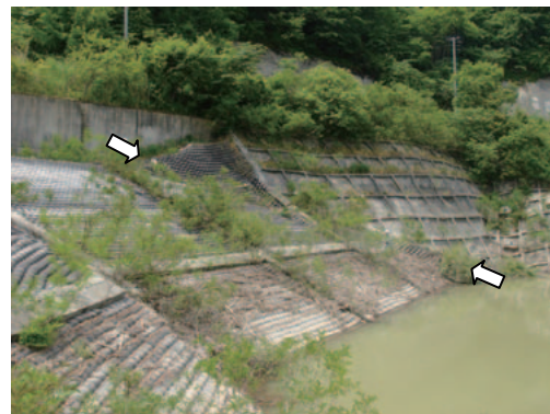
写真-2.2.32 地点 d に生じた変状 矢印に挟まれた箇所では護岸の座屈変形、のり枠の破断が生じている。
