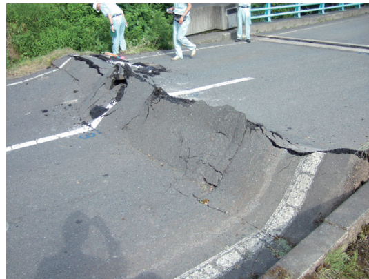
写真-6.37 A2 橋台背面付近の路面の割れ
