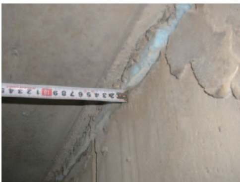
図-8.5.3 シール材のずれ
