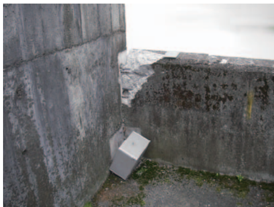
写真-5.39 天端高欄コンクリートの剥落
