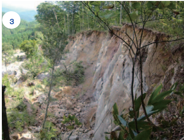
写真-3.4.36 右岸の頭部滑落崖（8月9日撮影）
