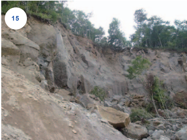
写真-3.4.29 B-B断面付近の頭部滑落崖（8月9日撮影）
