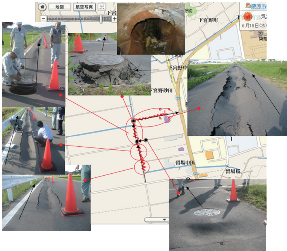
図-4.6 築館地区における埋戻し部の路面沈下
