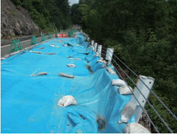
図-7.5.10 国道 342 号線宮城県境付近の重力式擁壁の被害
