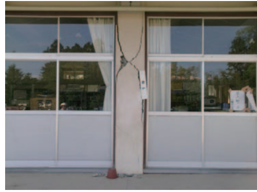
(b) 1階柱のせん断破壊
