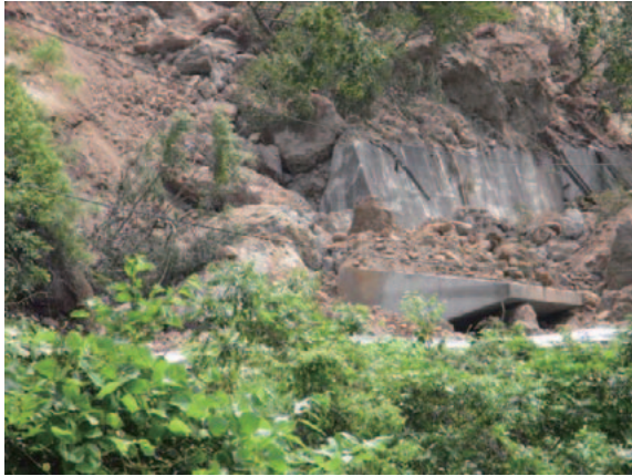
(c) 倒壊した擁壁
