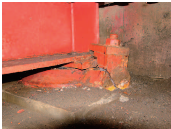
写真-6.3 固定支承の損傷
