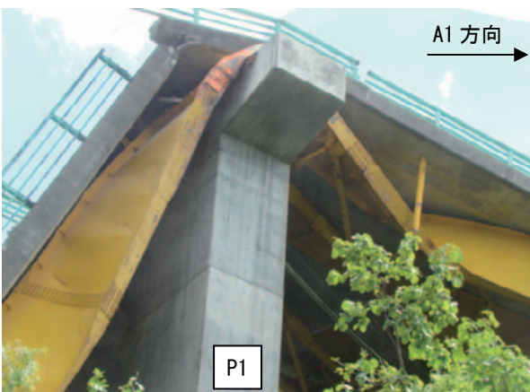
写真-6.17 P1 橋脚のA1 方向への傾斜
