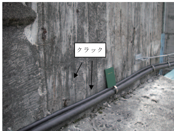
写真-5.38 門柱の亀裂（貯水池側の面）
