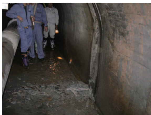
写真-5.31 アクセストンネルのジョイント部の破損
