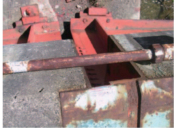
写真-6.5 桁変位の痕跡
