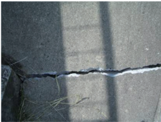
写真-4.11 放流渠法面防護壁の亀裂
