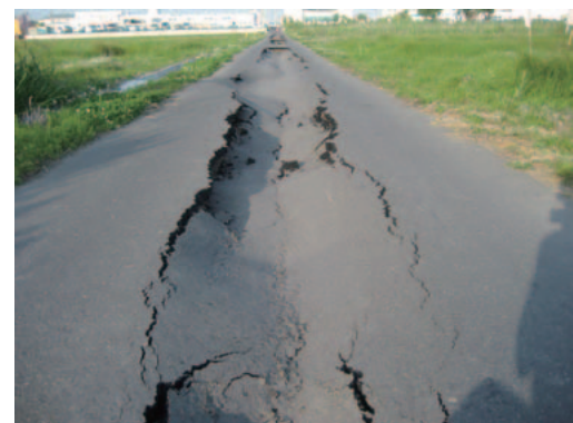
写真-4.6 埋戻し部沈下【栗原市・築館】
