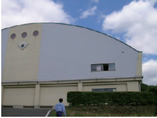
(a) 体育館妻面の窓ガラス破損
