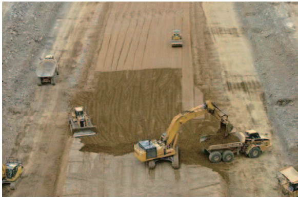
写真-5.14 コアの再盛立のための掘削状況（東北地方整備局胆沢ダム工事事務所提供）
