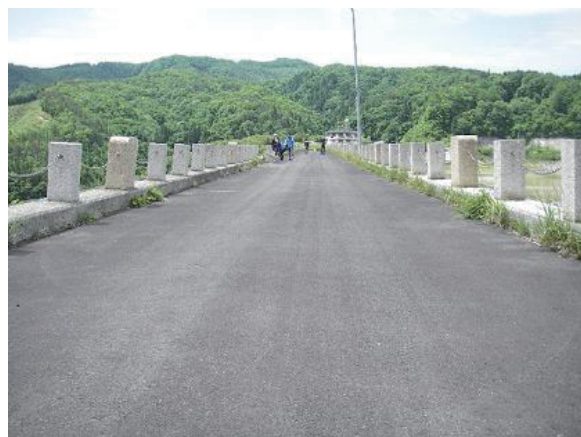
写真-5.20 天端の状況（天端舗装面のアンジュレーションは生じたが、亀裂はほとんど確認されなかった）
