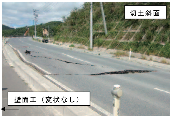
図-7.4.1 軽量盛土における路面のクラック、段差
