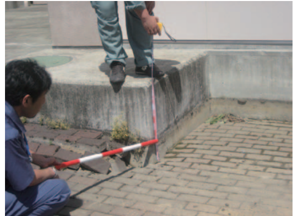
写真-4.12 場内地盤沈下
