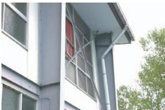
図-8.4.5 ブレース及び窓ガラスの被害
