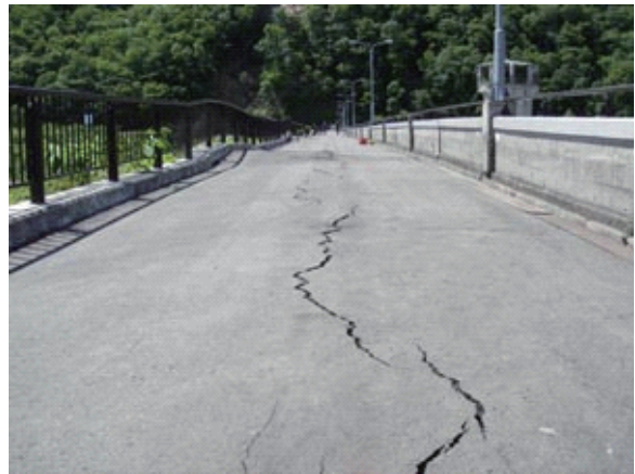
写真-5.3 天端舗装面の亀裂
