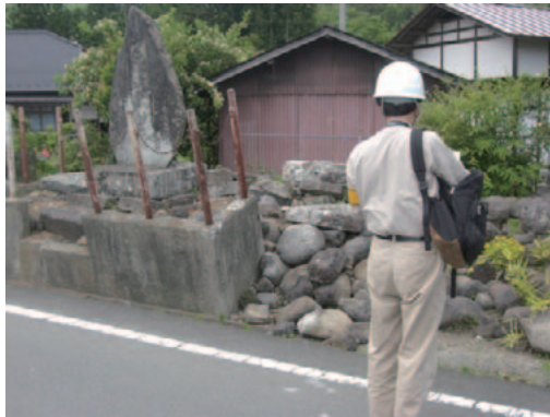
(a) 石碑基部の崩壊
