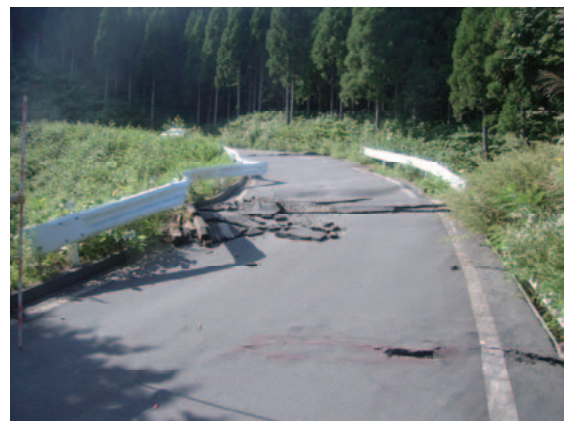
写真-2.2.2 地点bに生じた変状
