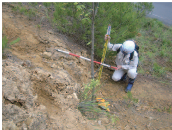
写真-2.2.21 栗駒ダム北方の段差
