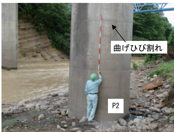
写真-6.2 橋脚の曲げひび割れ
