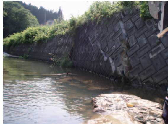
写真-2.2.11 地点dの真打川護岸の亀裂と はらみ出し
