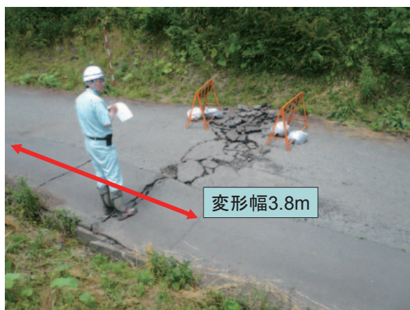
写真-2.2.17 地点 f の路面の段差 西側（左）が相対的に隆起していた。変形幅は 3.8m で、舗装や側溝が破断していた。
