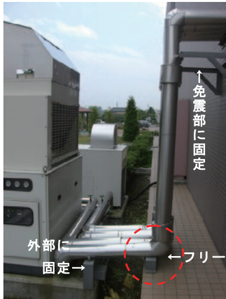
(a) 接続状況
