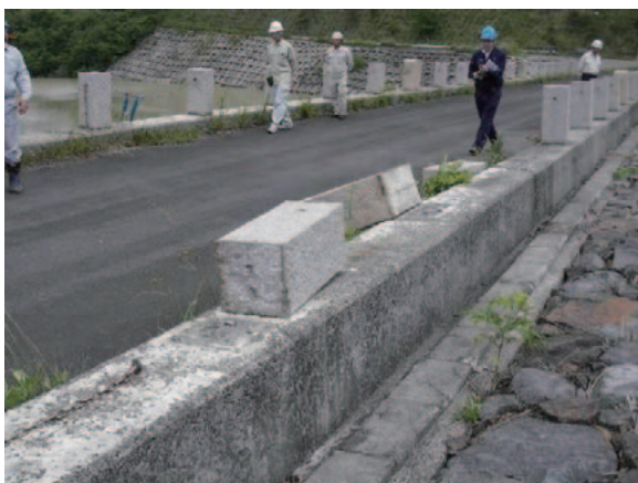
写真-5.19 天端の状況（天端高欄支柱が一部倒壊）
