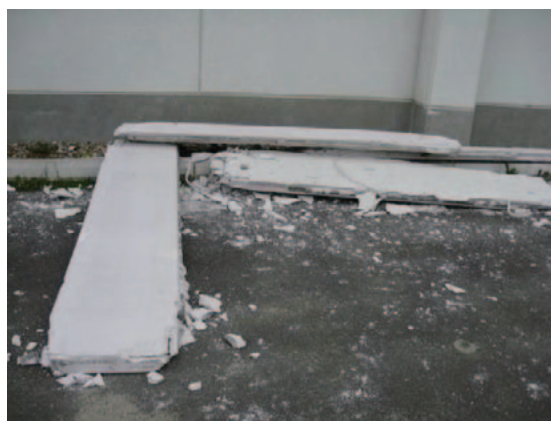
図-8.4.8 脱落したALCパネル
