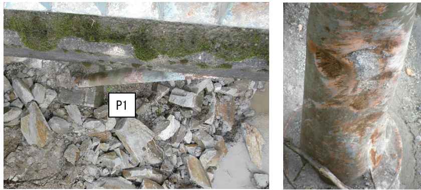
写真-6.35 P1 橋脚の変形
