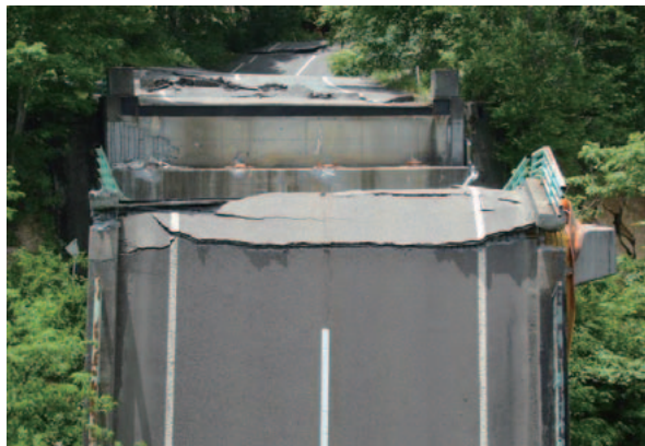
写真-6.14 落橋した祭時大橋
