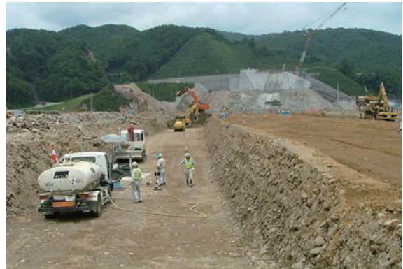
写真-5.15 フィルターの再盛立のための掘削状況（東北地方整備局胆沢ダム工事事務所提供）
