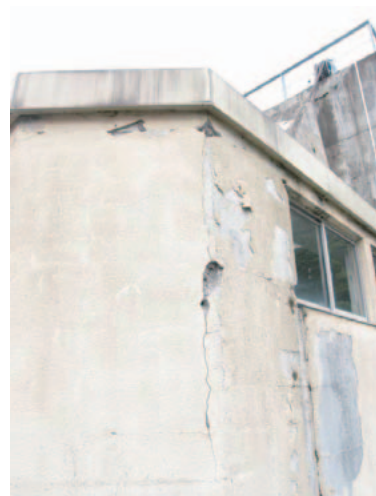
写真-5.40 ゲート巻上機室の壁面の損傷
