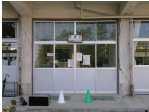
(c) 1階出入口脇の柱の損傷
