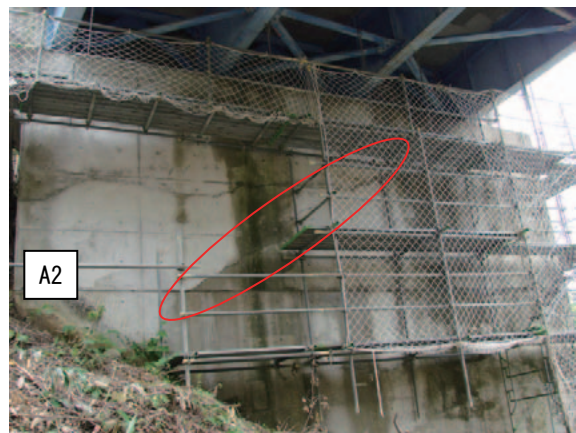
写真-6.11 A2 橋台の斜めひび割れ
