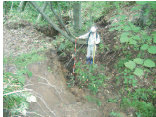
写真-2.2.25 地点 e に生じた変状
