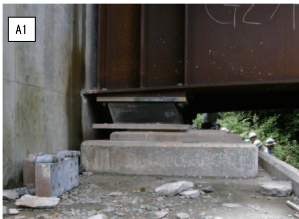
写真-6.43 桁の衝突と支承部の損傷
