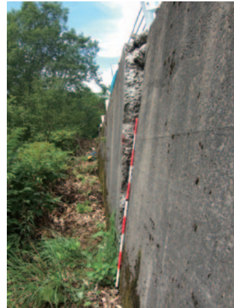
図-7.5.11 国道 342 号線宮城県境付近の重力式擁壁の被害（壁面の傾斜）
