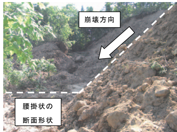
(b) 崩壊箇所上部
