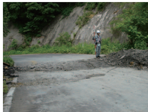
写真-2.2.30 地点 b に生じた変状 南西を望む。走向 N25W、約 30cm の西上がり。左ずれ約 10cm を伴う。
