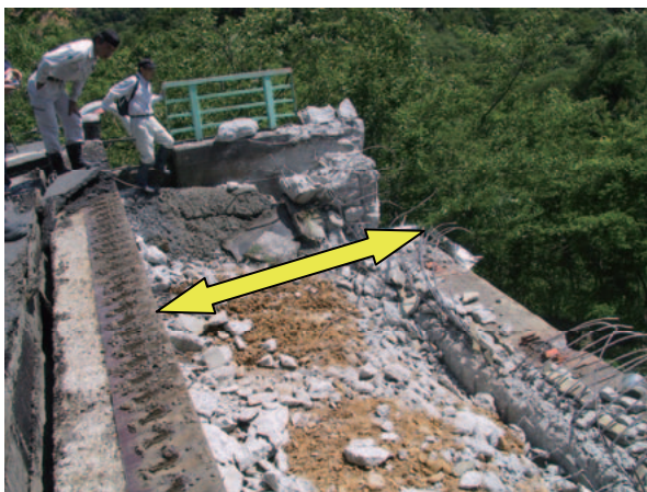
写真-6.21 A2 橋台パラペットと躯体との離れ
