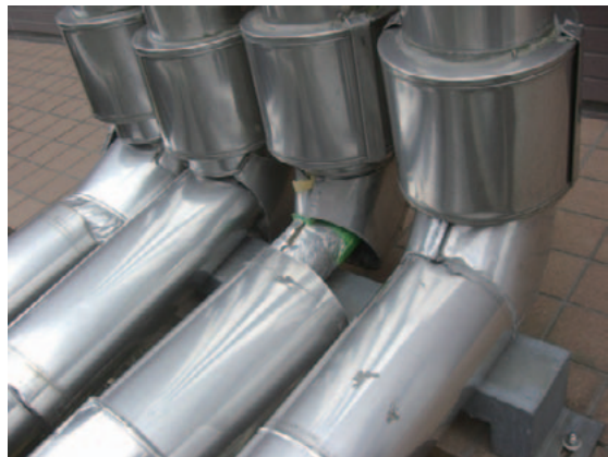
(b) 屈曲部カバーの損傷・脱落落下
