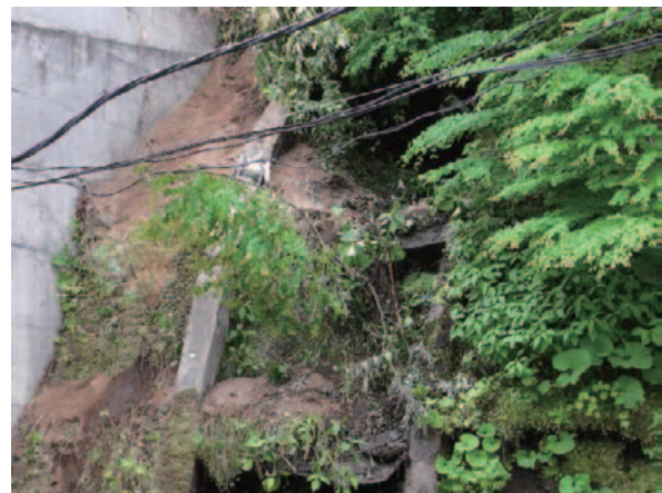
(d) のり枠の損傷
