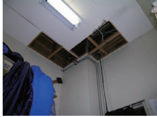
(b) ステージ脇 2 階天井板の落下
