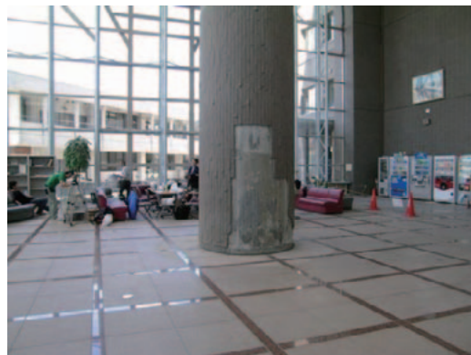
(b) 内部柱の仕上げタイル剥落
