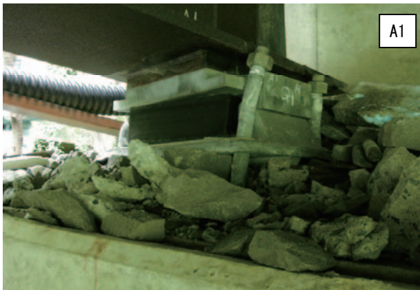
写真-6.47 A1 支承沓座の破壊
