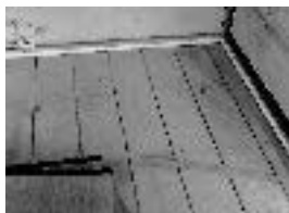
図 14 畳下地の荒板の隙間
