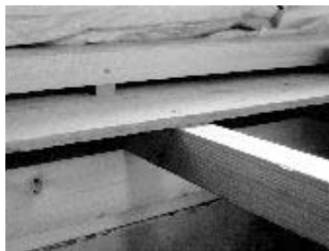
図 15 荒板と敷居の隙間
