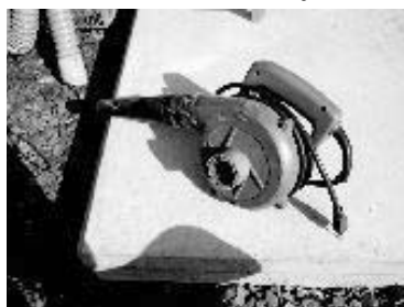
図 12 吹込みに使用した送風機
