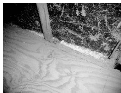
図8 床下から吹付けた断熱材が壁と床の隙間から床上に漏れ出した様子
