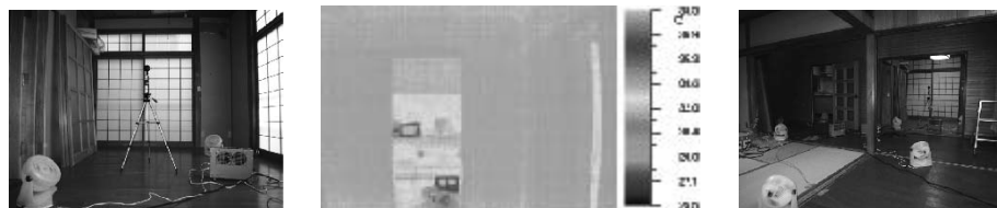
写真 2 1階廊下間仕切壁表面温度分布(改修前:室内 20.3^{\circ}\text{C} 、外気 7.8^{\circ}\text{C} 、改修後:室内 32.3^{\circ}\text{C} 、外気 9.3^{\circ}\text{C} )
