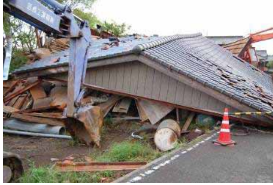
写真 4.2-2 上部構造の倒壊
