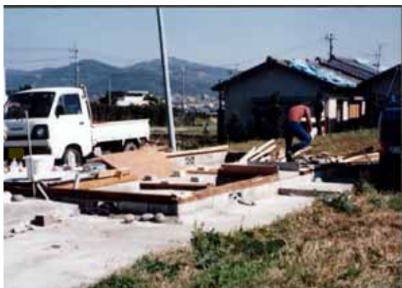
写真 6.2-1 枕崎竜巻（1990）での被害 （鹿児島地方気象台）
