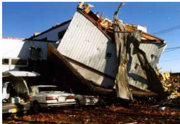
写真 6.2-2 茂原竜巻（1990）での被害 （茂原市消防署）
