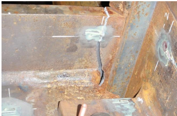
(c) 梁上フランジの貫通き裂
