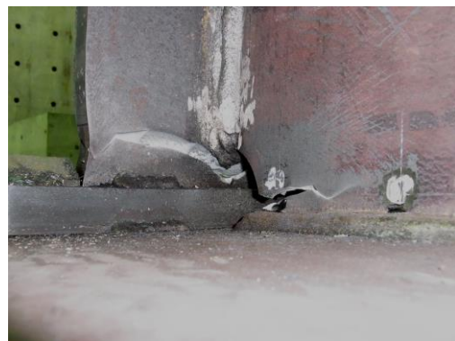
上フランジ破断状況(+7 サイクル)
