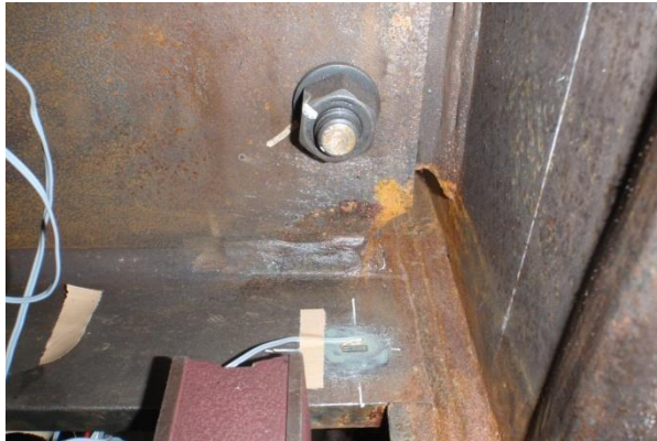
(a) スカラップ底に生じた亀裂(1 サイクル)
