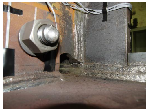
耳形スカラップ底の亀裂(-15 サイクル)
