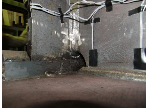
上フランジ側スカラップ底の亀裂(+20 サイクル)
