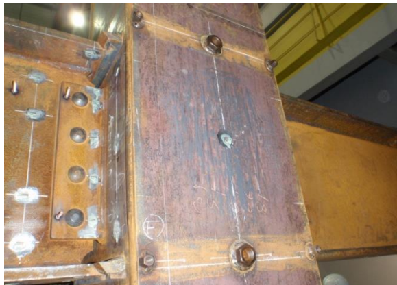
(c) 接合部パネルの塑性化によるミルスケールの剥離
