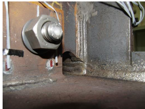
耳形スカラップ底の亀裂(-4 サイクル)
