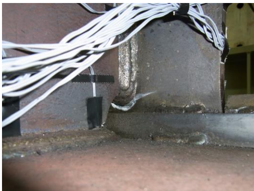
下フランジ側スカラップ底の亀裂(-6 サイクル)
