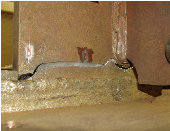
(c) +32 サイクル:フランジ破断状況
