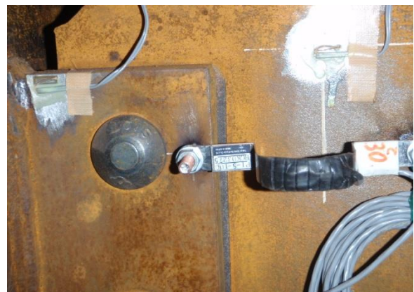
(d) ウェブボルト接合部のすべり
