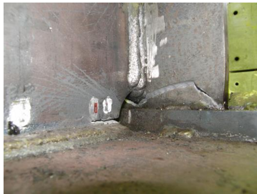
下フランジ破断状況(-20 サイクル)
