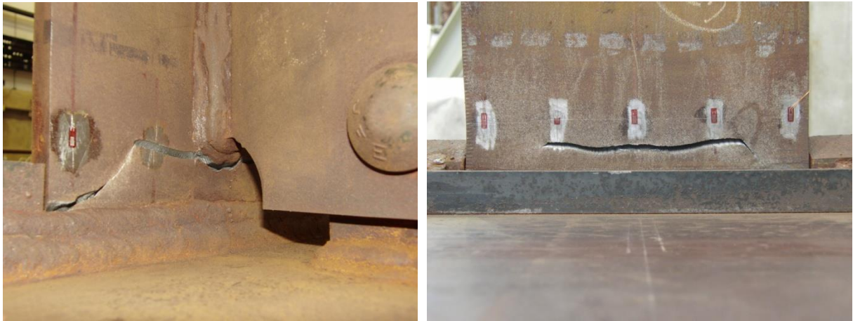
写真 2.3.2-5 最終破壊状況 (G-R2: +56 サイクル)
