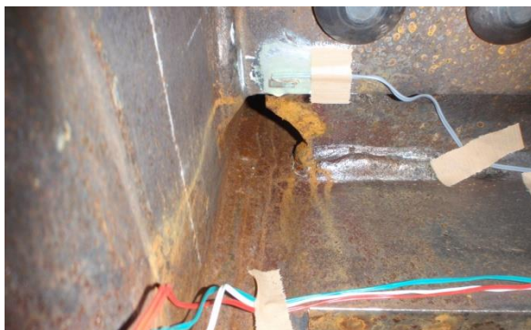
(a) スカラップ底に生じたき裂(2 サイクル)
