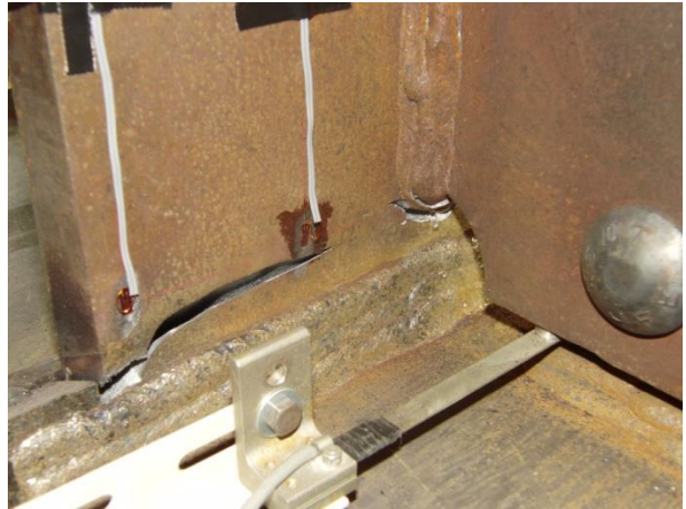
(b) +31 サイクル:破断直前の亀裂状況
