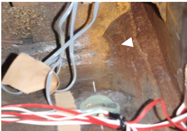
(a) スカラップ底に生じたき裂(10 サイクル)
