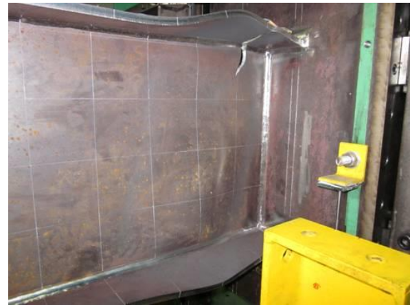
最終破壊状況(-126 サイクル目)
