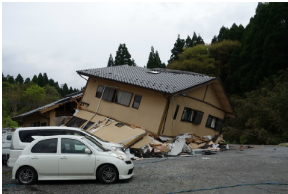
写真 5.3-64 倒壊した木造住宅
