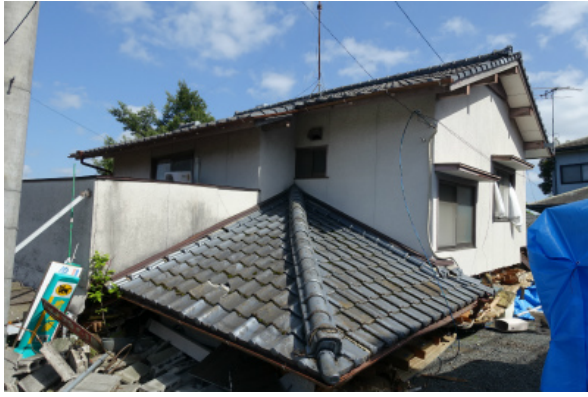
写真 5.3-14 倒壊した木造住宅
