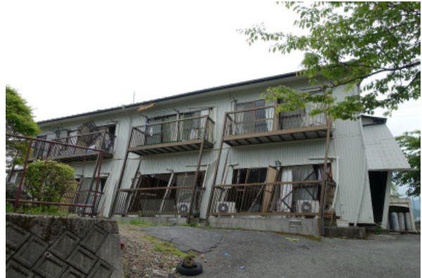
写真 5.3-61 傾斜した木造アパート
