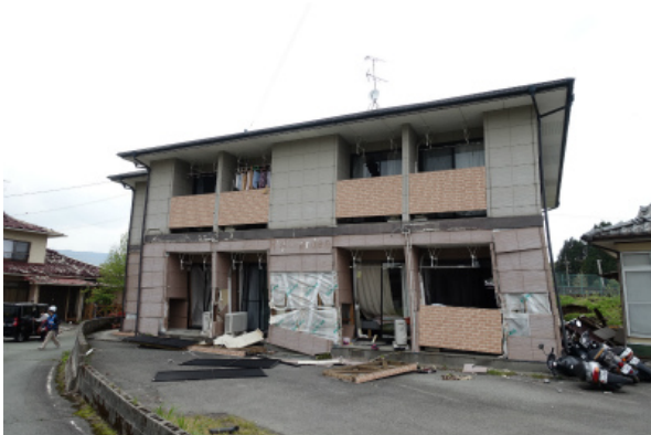
写真 5.3-60 傾斜した木造アパート
