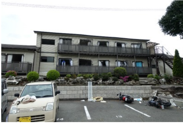
写真 5.3-62 大破した木造アパート
