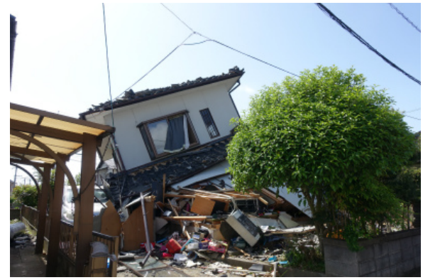
写真 5.3-9 倒壊した木造住宅
