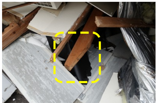
写真 5.3-53 アパート C の筋かい端部 (釘打ち)
