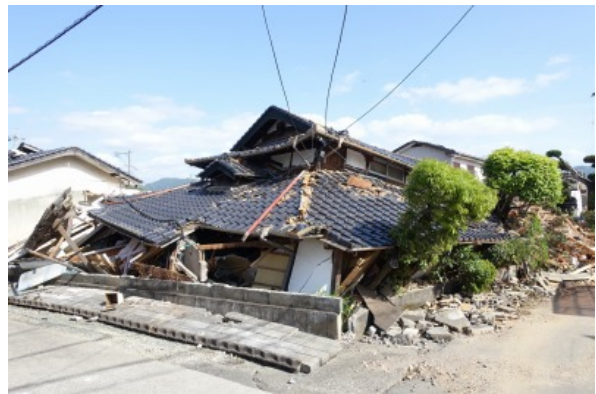
写真5.3-3 倒壊した木造住宅
