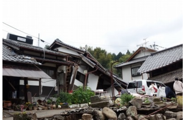
写真 5.3-39 倒壊した木造住宅
