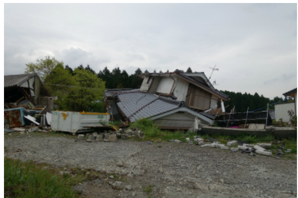
写真 5.3-67 倒壊した木造住宅
