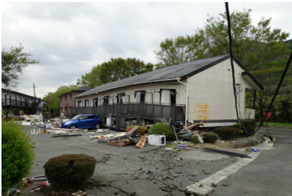
写真 5.3-50 倒壊したアパート B
