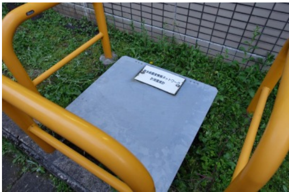
写真 5.3-25 震度計の設置状況
