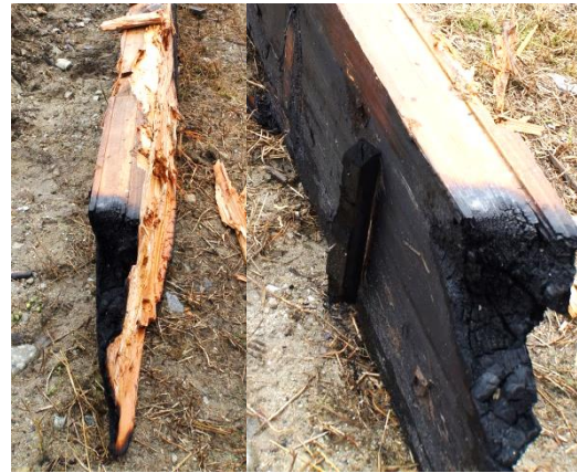
写真 4.7.7-23 北側桁の残火による燃焼跡
