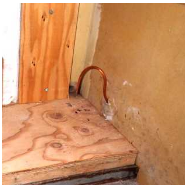
写真 4.5.8-1 微差圧計のチューブの端部
