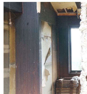
写真 4.7.7-21 3階柱・梁の炭化状況
