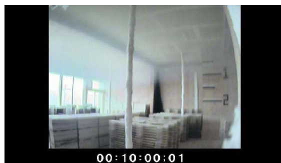
写真 4.7.2-3 自然鎮火した火源付近
