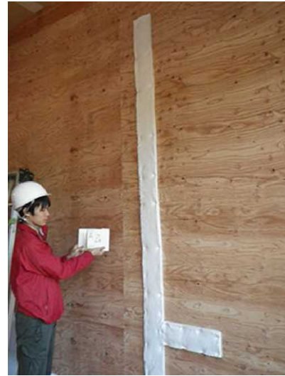
写真 4.5.3-4 熱電対配線の様子
