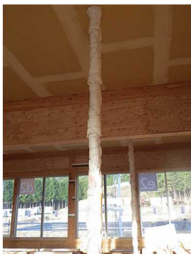
写真 4.5.3-1 熱電対タワー
