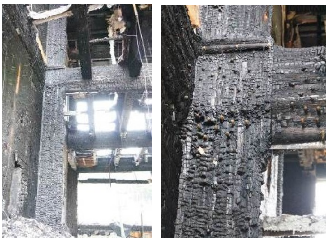
写真 4.7.7-29 出火源直上の柱・梁接合部
