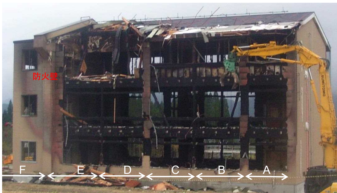
写真 4.7.7-7 実験後の実験建物（北面）
