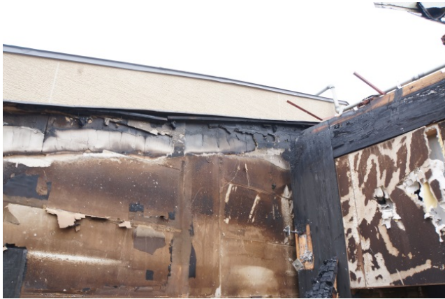
写真 4.7.7-22 防火壁境界部分の登り梁の燃焼跡
