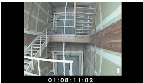
写真 4.7.2-22 1階防火戸から侵入する煙
