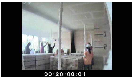
写真 4.7.2-4 再着火の様子
