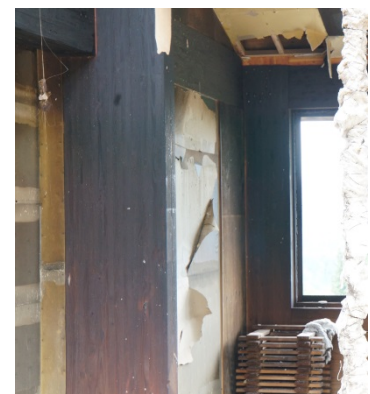
写真 4.7.7-21 3階柱・梁の炭化状況
