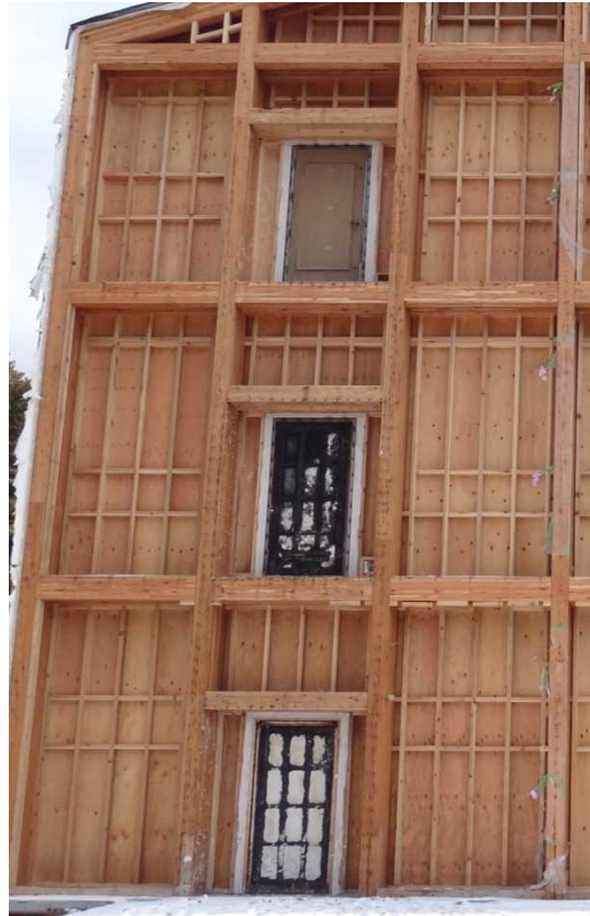
写真 3.7.7-25 防火壁防火戸の残存状況
