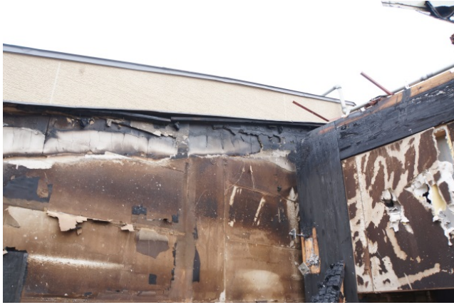
写真 4.7.7-22 防火壁境界部分の登り梁の燃焼跡
