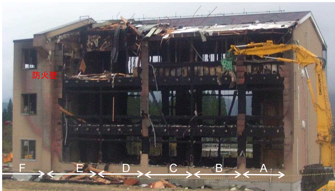
写真 4.7.7-7 実験後の実験建物（北面）
