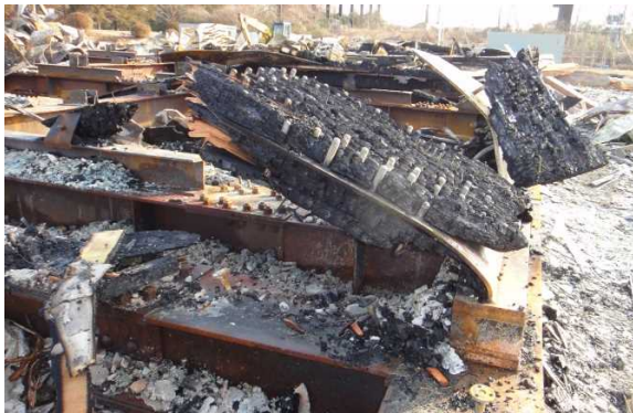
写真 2.7.7-10 残存した柱脚部の様子
