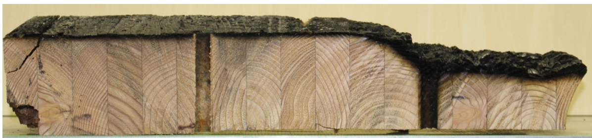
写真 4.7.7-36 ドリフトピン周りの炭化状況
