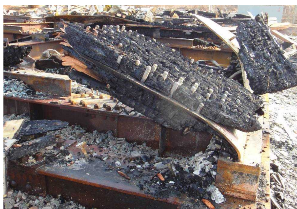
写真 2.7.7-13 変形した柱脚鋼板
