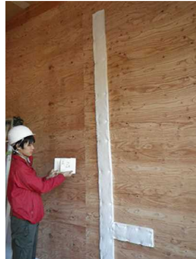
写真 4.5.3-4 熱電対配線の様子
