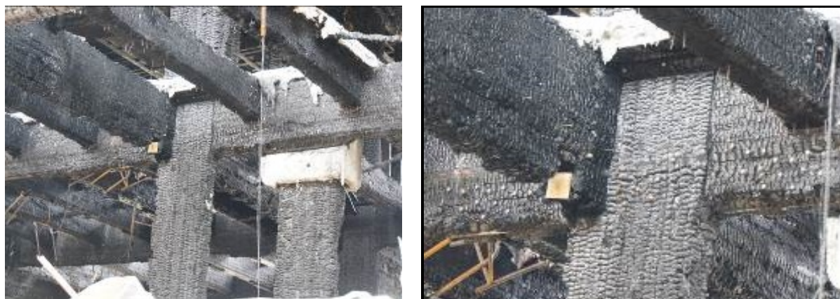
写真 4.7.7-30 1階 X3-Y3 柱の柱・梁接合部
