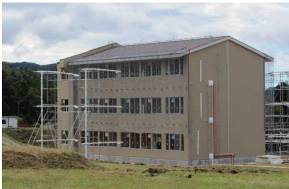
c) 北側 熱流束計タワー
