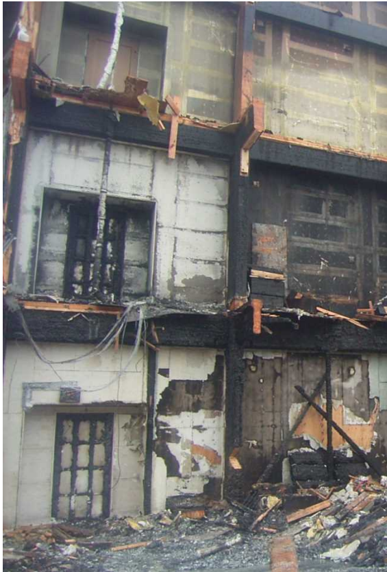
写真 3.7.7-24 防火壁と防火戸の残存状況
