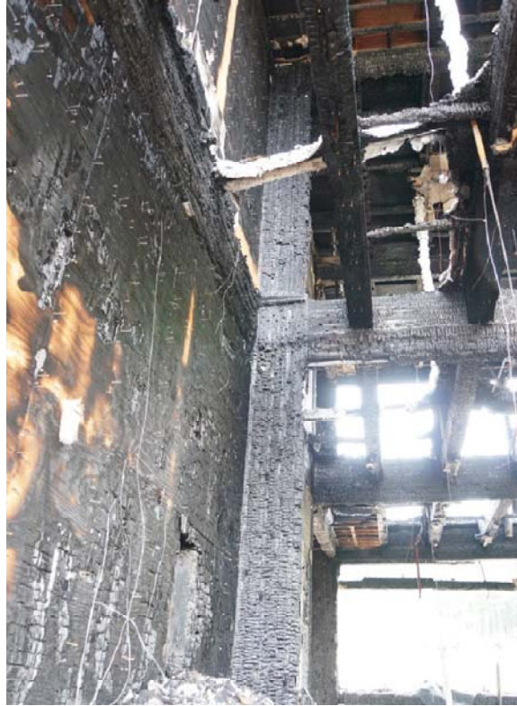
写真 4.7.7-8 1階出火源近傍の状況
