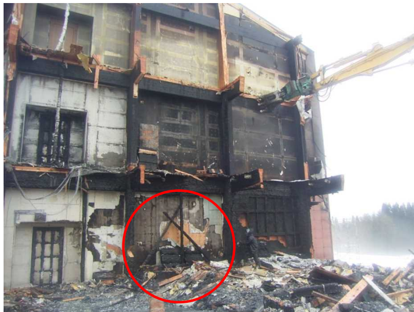
写真 3.7.7-26 防火壁の温度測定における損傷状況
