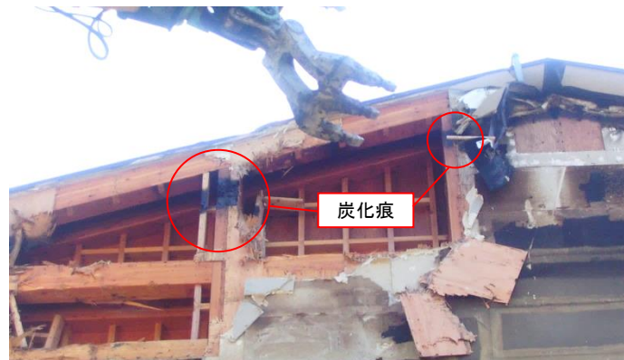
写真 4.7.7-31 防火壁の残火による炭化痕
