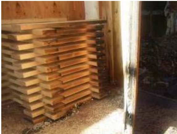
写真 4.7.7-28 防火戸近傍のクリブの変色
