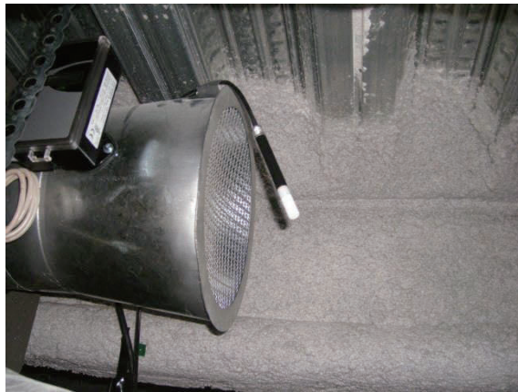
写真 9 吸込み口センサー設置位置
