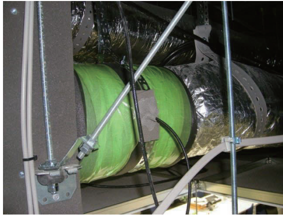
写真 4 外調機吹出し口センサー設置箇所
