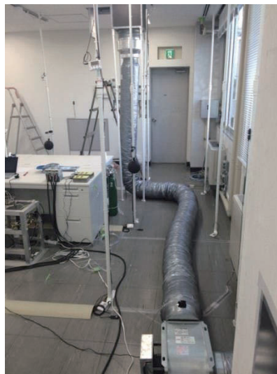
写真 21 RA 側補助ファン、補助ダクト取付位置
