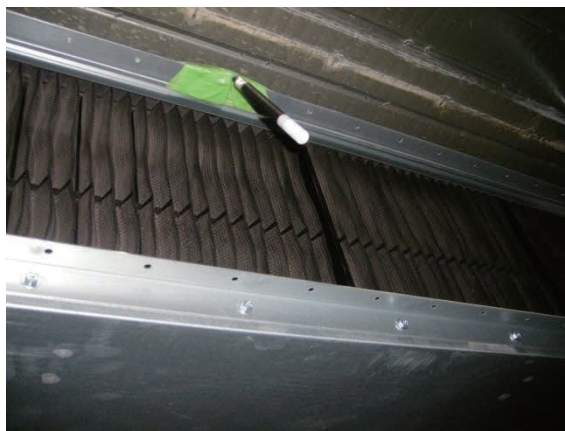
写真 1 室内機吸込み口センサー設置箇所
