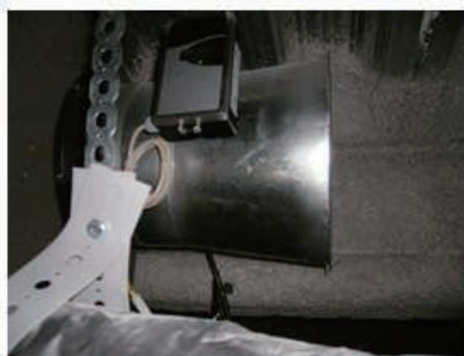
写真 17 既存 RA 吸込み口
