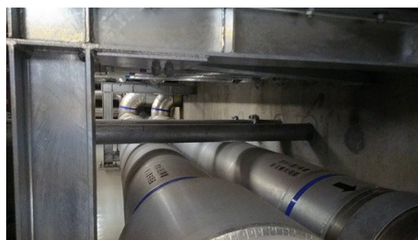
冷水配管 (行き・返り)
