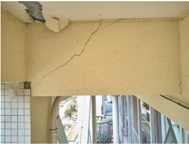
写真 8.4.3.29 梁Cの損傷
