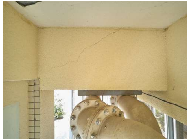
写真 8.4.3.30 梁Dの損傷
