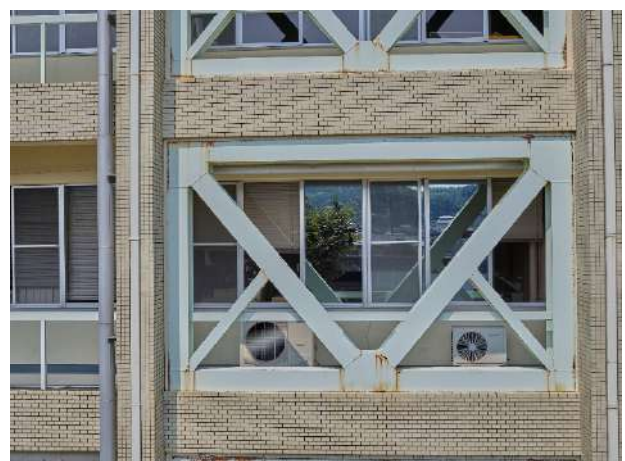
写真 8.4.3.32 ブレース⑦の損傷（1億画素）
