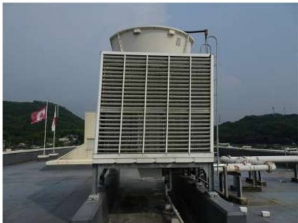
写真 8.4.3.22 傾斜した貯水槽
