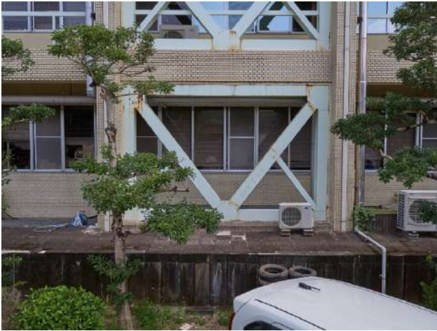
写真 8.4.3.33 ブレース⑥の損傷 (2000 万画素)
