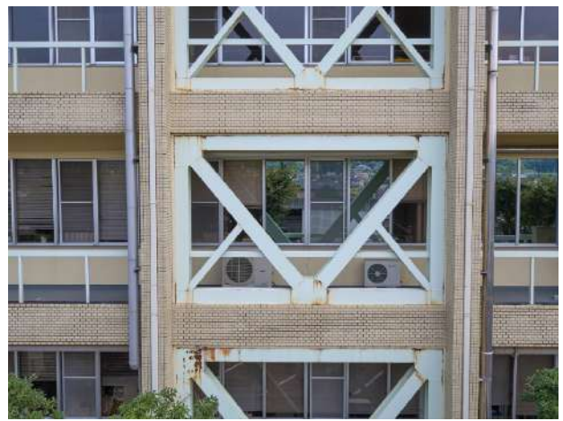
写真 8.4.3.34 ブレース⑦の損傷 (2000 万画素)
