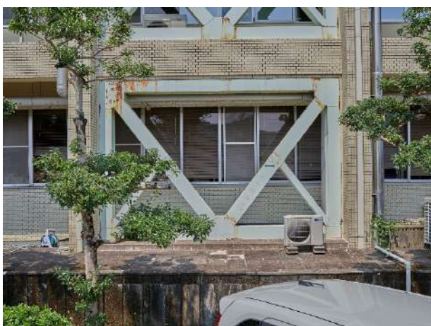
写真 8.4.3.31 ブレース⑥の損傷（1億画素）
