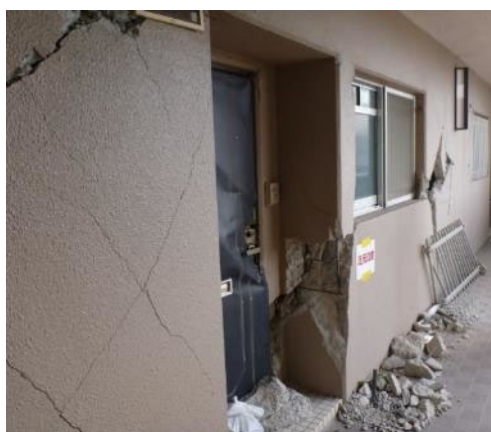
図 1.1.3-7 2階共用廊下側の方立壁の被害
