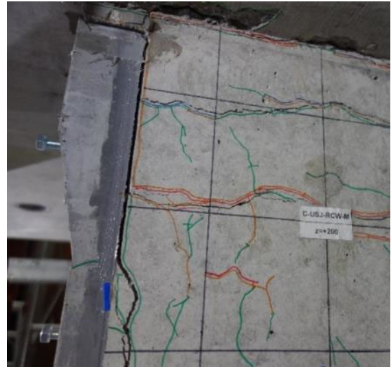
(b) 柱パネル界面の縦ひび割れ
