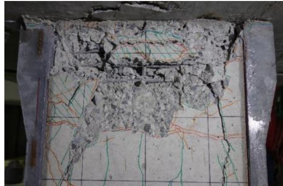
(d) 柱頭圧縮側主筋座屈
