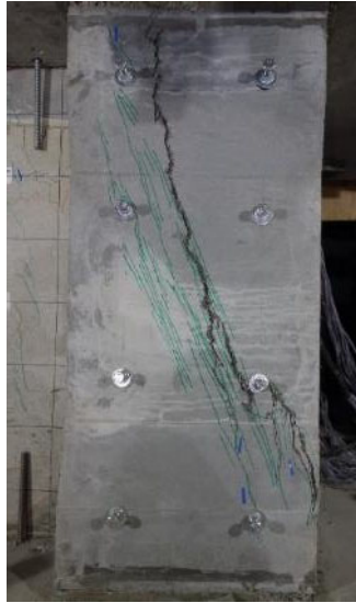
(a) 柱パネルせん断破壊
