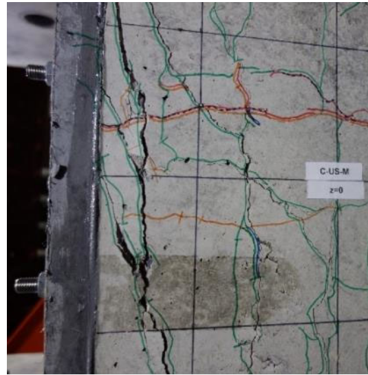
(b) パネル界面ひび割れ
