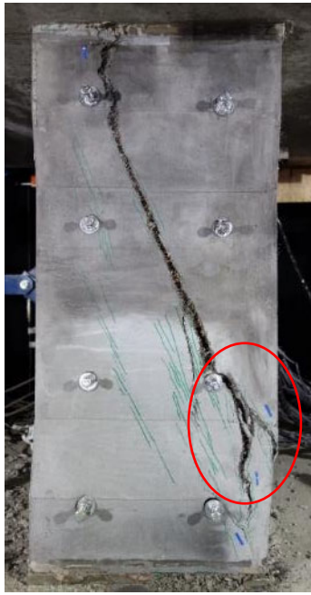
(a) パネルせん断破壊
