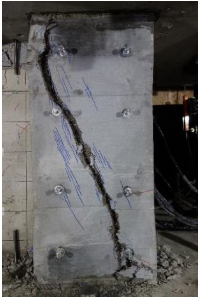
(a) 柱パネルせん断破壊
