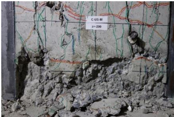
(c) 柱脚圧縮側コンクリート圧壊
