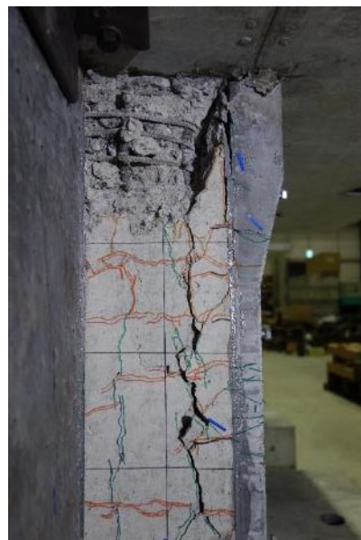
(f) 柱頭柱主筋座屈
