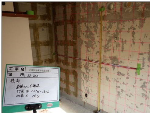
写真 8.2.2-7 既存壁鉄筋探査結果
