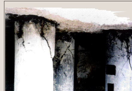
写真5:杭基礎の被害(兵庫県南部地震)
