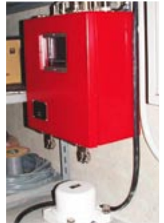
■写真2 強震計の設置例
