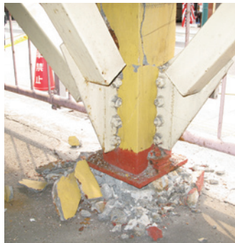
■写真4 露出柱脚の被害
