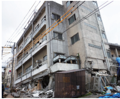
■写真7 ピロティ構造の1階における層崩壊
