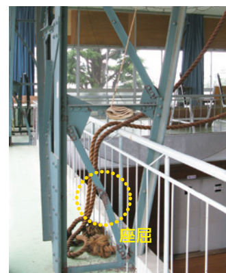
■写真6 ラチス柱の斜材の座屈 (黄点線部)
