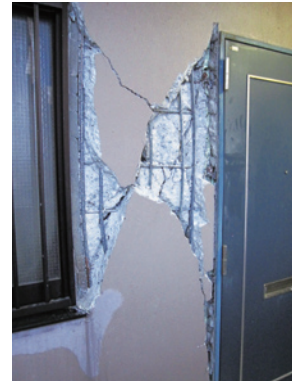
■写真9 非構造壁のせん断破壊
