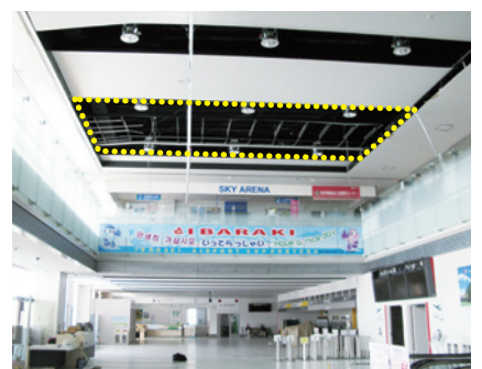
■写真13 空港出発ロビーにおける天井材の脱落(黄点線が天井脱落箇所)
