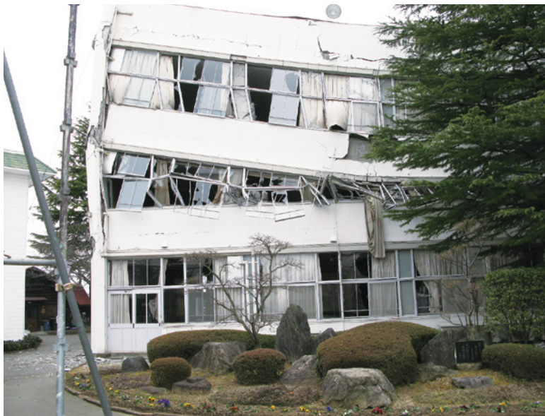
写真1 低層建築物の中間階における層崩壊
