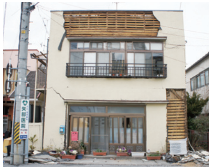
■写真2 外装材の脱落
