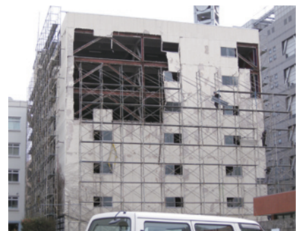
■写真12 パネル外壁の脱落
