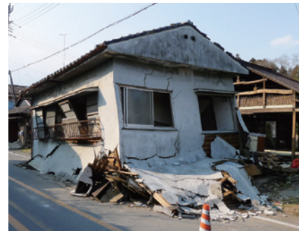
■写真3 1階の層崩壊
