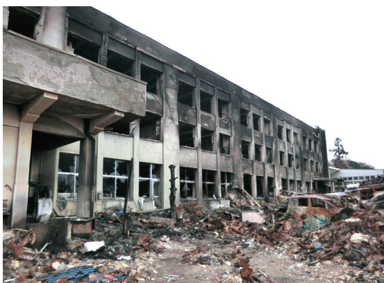
写真1 開口から侵入した火災で3階がほぼ全焼した小学校
