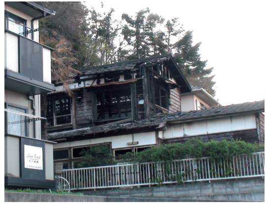
■写真3 復電後の住宅火災の一例
