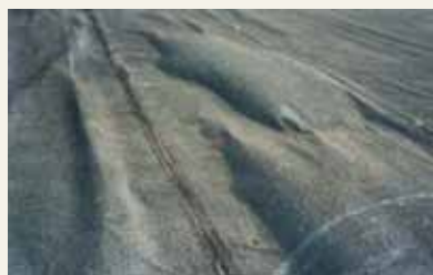
写真1 防水層のふくれに関する劣化度判定のための写真例
