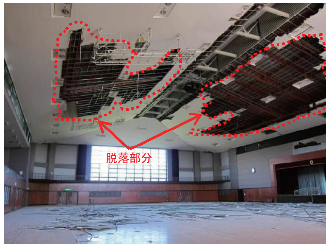
■ 写真2 体育館での天井脱落被害
