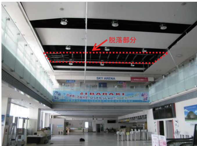
■ 写真1 空港での天井脱落被害
