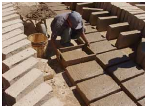
■写真4 組積体(アドベ)の製造(型枠に材料を打設し、天日で乾燥させる)
