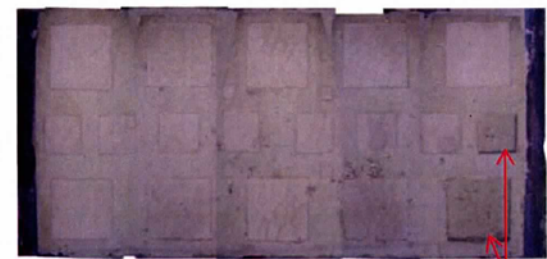
写真2 No.2(パッチ補修)実験後の状況 剥落
