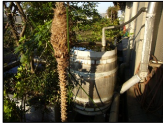
雨水貯留タンク
