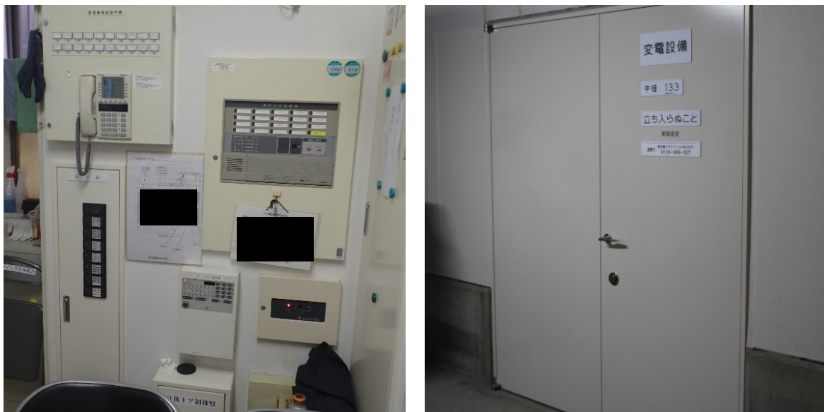
図Ⅲ-8 電気設備関連(左:電気制御機器、右:電気室、一部情報秘匿のため黒塗り)
