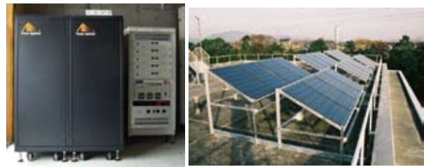
写真1 蓄電装置 写真2 太陽光発電装置
