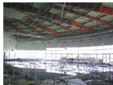
写真 2 大規模天井の脱落（平成 17 年宮城県沖地震）
