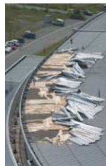
写真 1 二重折板屋根の剥離（平成 16 年読売新聞）
