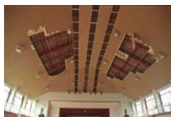
写真4 平成13年芸予地震時の天井脱落状況
