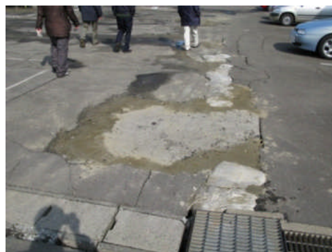
(b) 駐車場の亀裂と噴砂の跡
