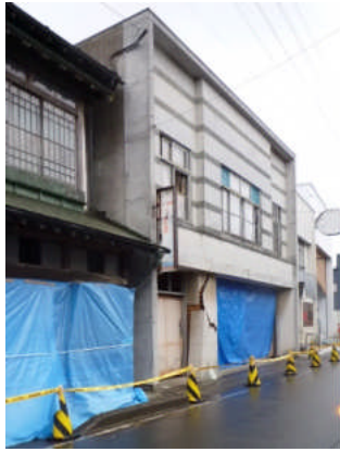
写真 5.2.1-13 商店建築物の被害
