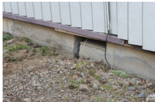
写真 5.2.7-22 写真 5.2.7-19 の無筋基礎の ひび割れ
