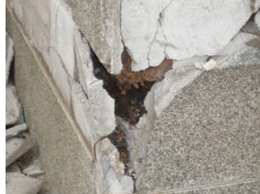
写真5.2.7-4 写真5.2.7-3柱脚部の生物劣化
