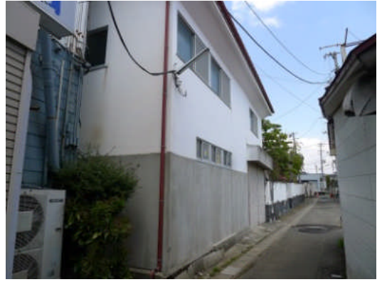
写真 5.2.2-26 外壁モルタルが剥落した倉庫
