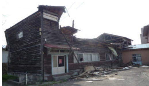
写真 5.2.2-10 2階が崩壊した学校建築
