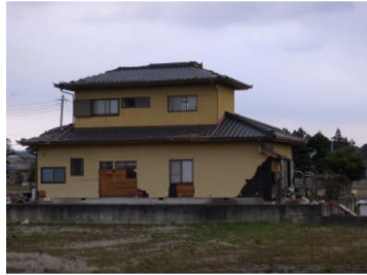
写真 5.2.9-4 モルタル外壁の剥落
