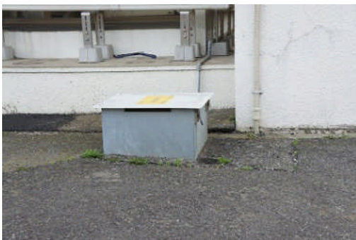
写真 5.2.13-1 龍ヶ崎市震度計設置状況
