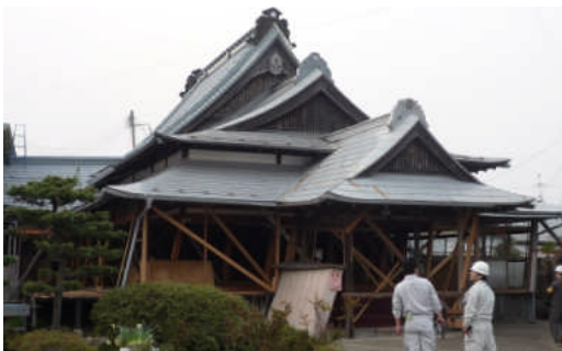
写真 5.2.2-17 大きく傾斜した寺社建築
