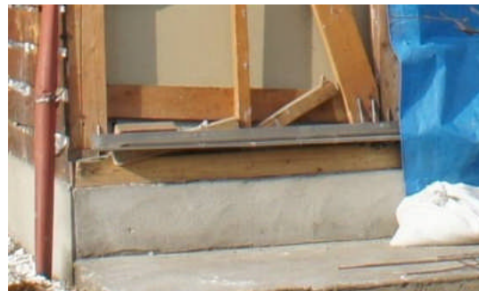
写真 5.2.7-16 写真 5.2.7-14 の柱脚、筋かい端部接合部
