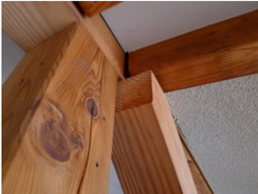
写真5.2.10-11 写真5.2.10-10の筋かいのはずれ
