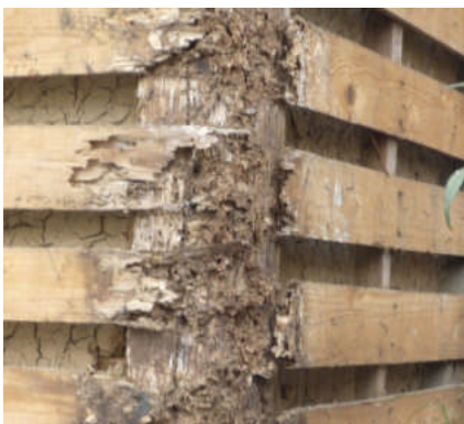
写真 5.2.6-7 写真 5.2.6-6 の柱・下地の生物劣化
