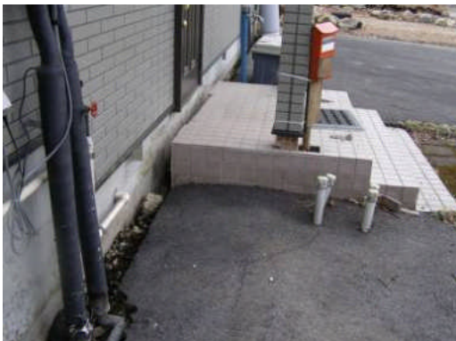
写真 5.2.7-5 那須町豊原乙の別荘地の地盤変状
