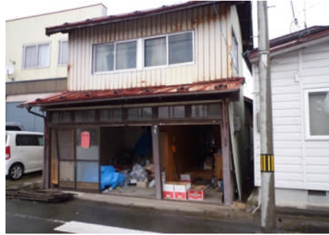
写真 5.2.1-6 町屋形式の住宅の被害
