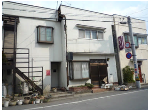
写真 5.2.6-8 外壁モルタルが剥落した住宅
