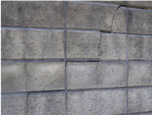
写真 5.2.8-5 塀のひび割れ
