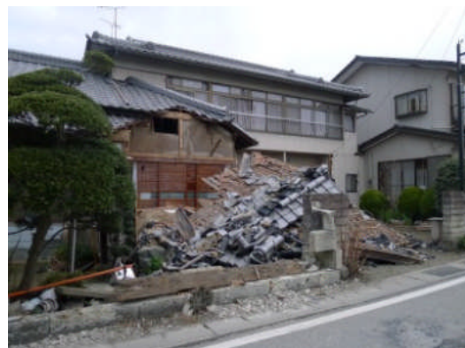
写真 5.2.9-2 住宅の玄関部分の崩壊
