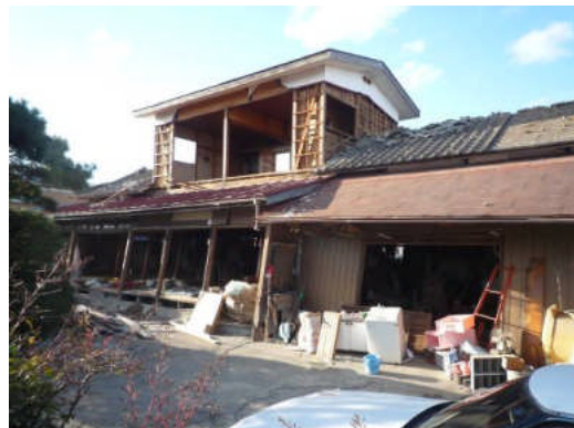
写真 5.2.3-8 1階が大きな残留変形の 住宅
