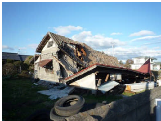
写真 5.2.3-10 倒壊した納屋
