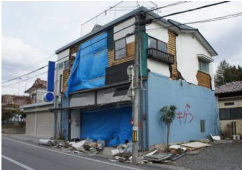
写真 5.2.6-3 店舗併用住宅の被害
