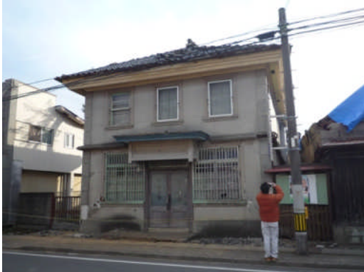
写真5.2.7-3 旧郵便局庁舎の被害
