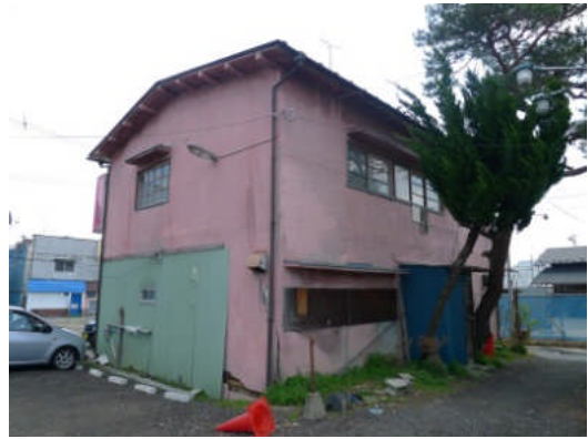
写真 5.2.2-28 傾斜した木造住宅
