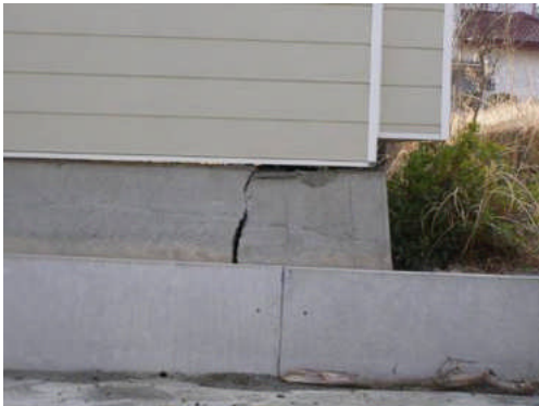
写真 5.2.8-9 住宅基礎の割れ
