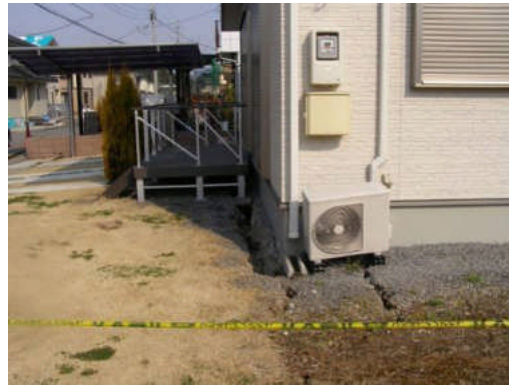
写真 5.2.8-4 地盤のひび割れとすべり
