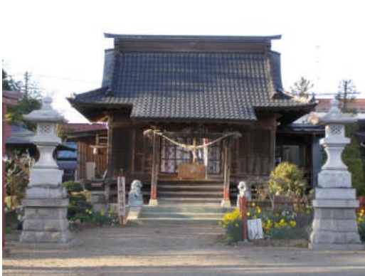
写真 5.2.3-9 残留変形が認められる神社
