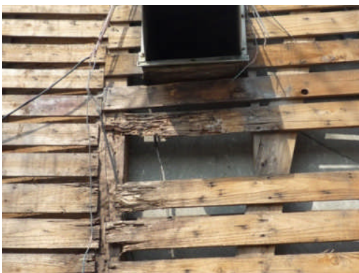
写真 5.2.2-5 写真 5.2.2-4 の南側における生物劣化
