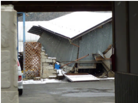
写真 5.2.1-15 作業小屋の倒壊 (栗原市栗駒桜田)
