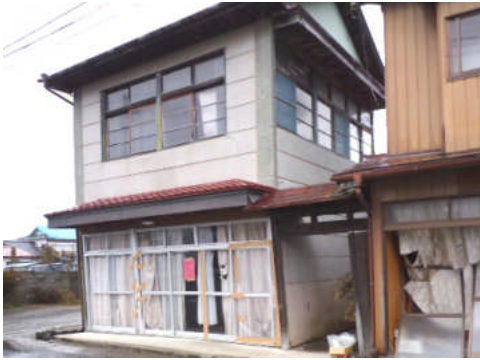
写真 5.2.1-7 町屋形式の住宅の被害
