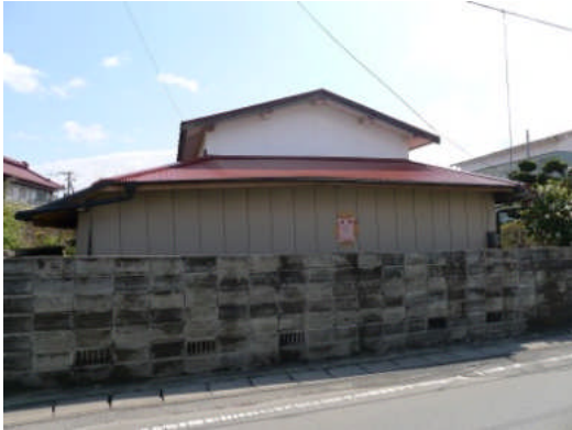
写真 5.2.2-18 地盤変状により傾斜した平屋の住宅
