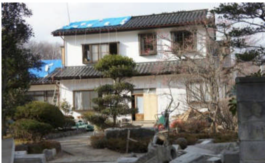
写真 5.2.7-15 住宅の外壁の剥落 (西大久保地区)
