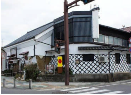
写真 5.2.6-1 土蔵を利用した店舗の被害
