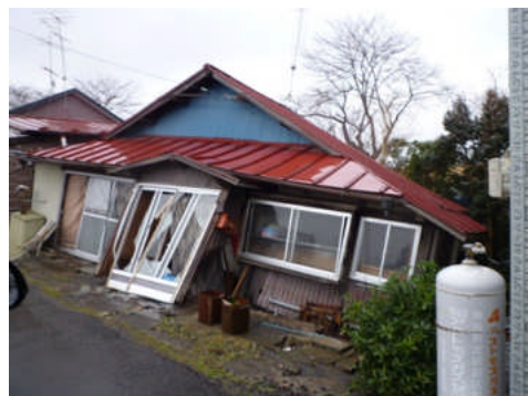
写真 5.2.1-4 地盤変状によると見られる被害
