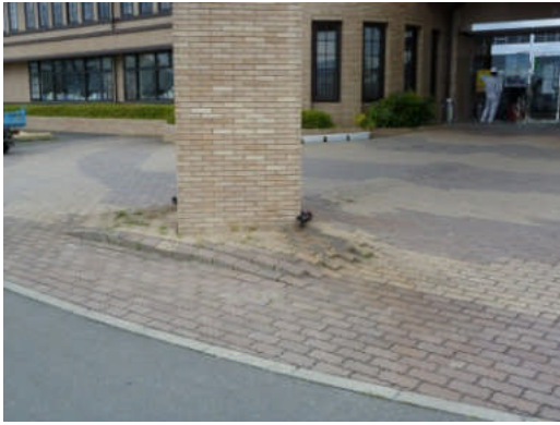
写真 5.2.3-11 南郷支所の地盤変状
