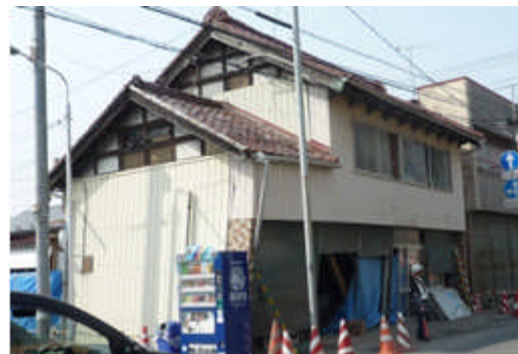
写真 5.2.2-12 残留変形が大きい店舗併用住宅
