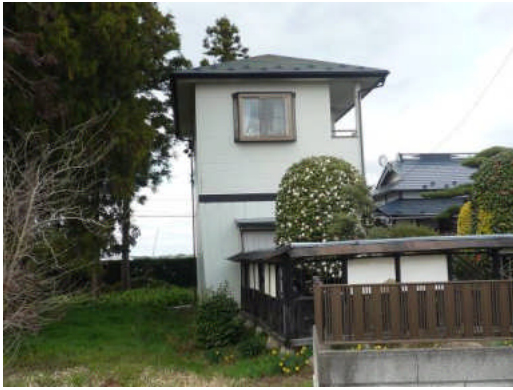
写真 5.2.3-5 2階増築と思われる建物の 残留変形
