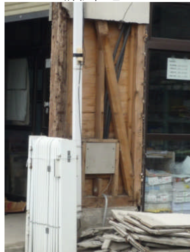
写真 5.2.3-16 写真 5.2.3-15 の隅角部の柱の腐朽
