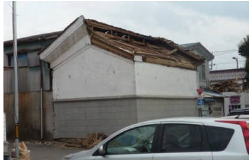
写真 5.2.6-12 屋根だけが崩壊した土蔵
