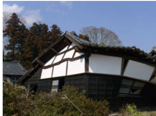
写真 5.2.10-2 大きく傾斜した納屋 (那珂市門部)
