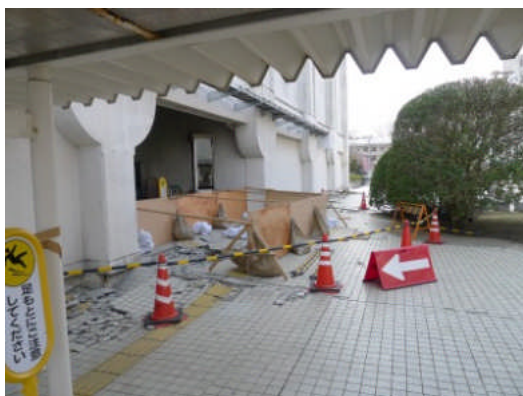
写真 5.2.11-1 市役所周辺の地盤変状
