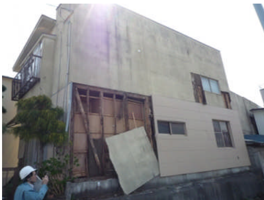
写真 5.2.2-6 外壁モルタルが剥落して、筋かいの生物劣化が顕著
