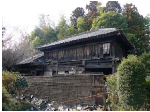
写真 5.2.10-4 下屋の被害 (那珂市門部)
