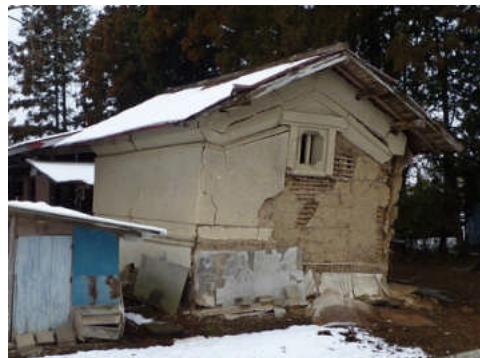
写真 5.2.1-18 大きく損壊した土蔵 (栗原市栗駒桜田)
