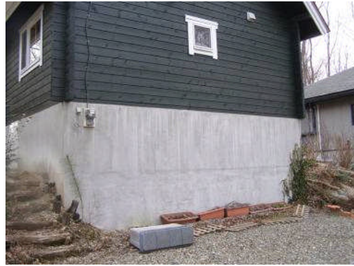
写真 5.2.7-10 高基礎部分のひび割れ (豊原乙地区)
