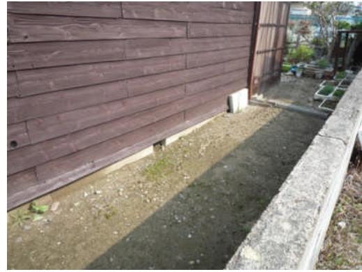
写真 5.2.2-16 写真 5.2.2-15 の液状化した敷地
