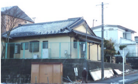
写真 5.2.5-11 棟瓦落下および塀の倒壊 (仙台市青葉区旭ヶ丘)
