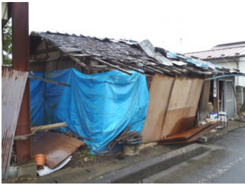
写真 5.2.1-9 老朽化した家屋の倒壊
