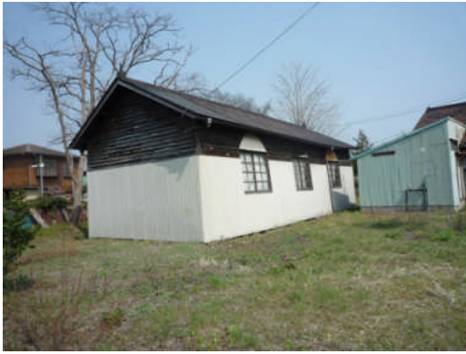
写真 5.2.2-7 残留変形が大きな倉庫
