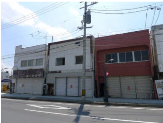
写真 5.2.2-29 傾斜した店舗併用住宅 3 棟
