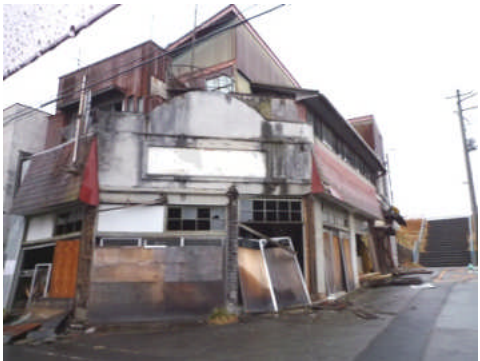
写真 5.2.1-12 老朽化した商店建築物の被害
