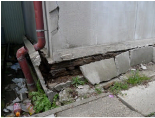
写真 5.2.2-27 写真 5.2.2-26 の剥落部の 土台の腐朽
