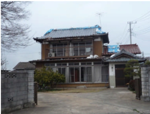
写真 5.2.12-3 常総市上蛇町の屋根瓦の被害
