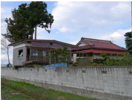
写真 5.2.3-3 ほぼ倒壊相当の住宅 （ブロック塀に載っている）
