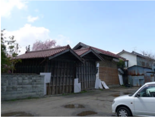
写真 5.2.2-25 傾斜した土蔵、倉庫
