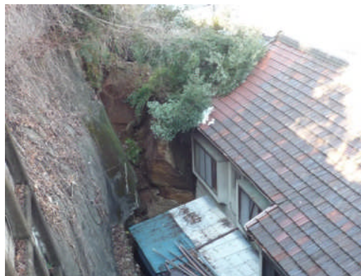
写真 5.2.5-13 崩壊した旅館の裏山
