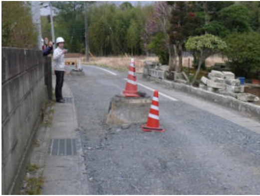
写真 5.2.9-3 道路の地盤変状 (写真 5.2.9-2 の前面道路)
