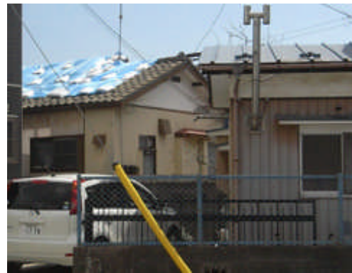
写真 5.2.4-2 日和が丘 屋根の被害
