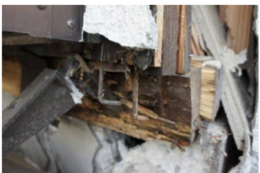
写真 5.2.7-24 写真 5.2.7-23 の柱脚接合部 及び生物劣化
