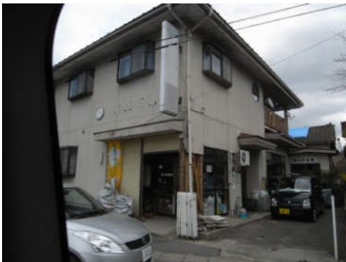
写真 5.2.3-15 外壁の一部が剥落した店舗併用住宅
