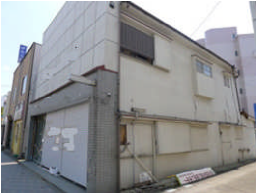
写真 5.2.2-31 く の字に変形した店舗併用住宅
