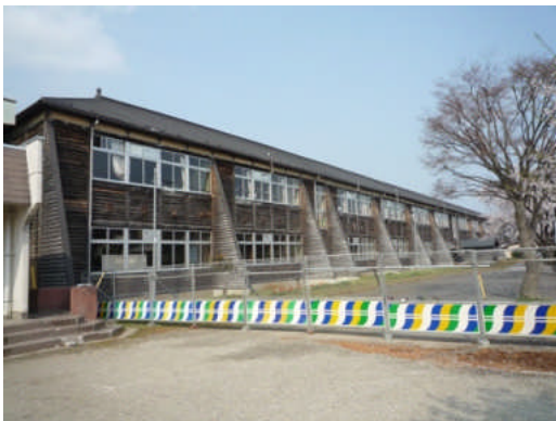
写真 5.2.2-11 外観上被害軽微に見えた学校
