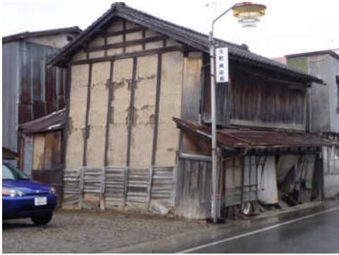
写真 5.2.1-5 町屋形式の住宅の被害
