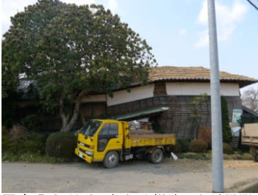
写真 5.2.11-3 大きく損壊した長屋門 (水戸市吉沼町)
