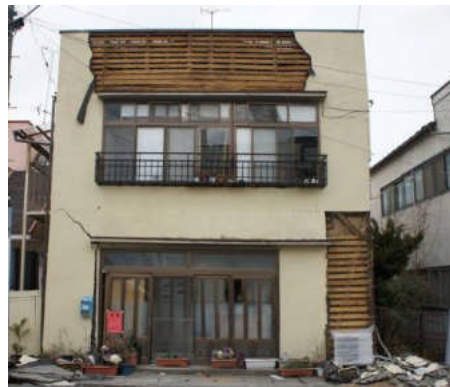
写真 5.2.6-6 外壁モルタルが剥落した住宅
