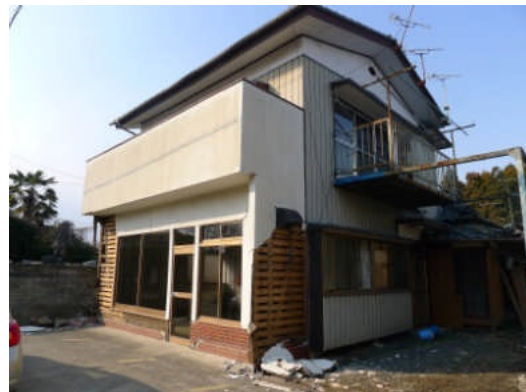
写真 5.2.10-6 モルタルの剥落 (那珂市瓜連)
