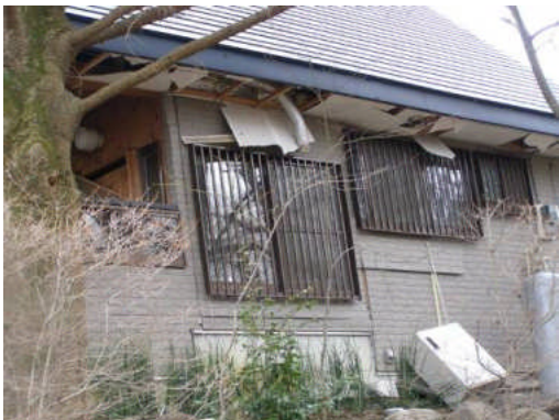
写真 5.2.7-13 軒裏天井の落下 (豊原乙地区)
