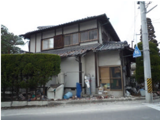
写真 5.2.6-15 屋根瓦の被害
