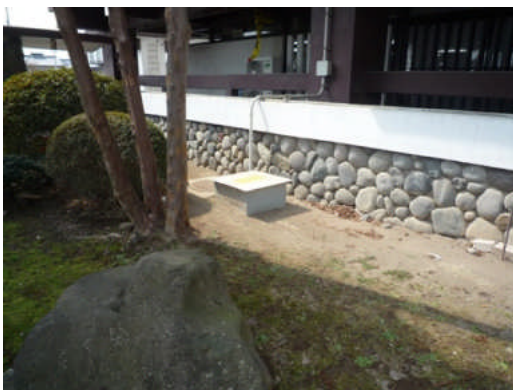
写真 5.2.8-1 矢板市の震度計設置状況
