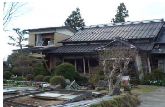
写真 5.2.3-2 残留変形の大きな住宅
