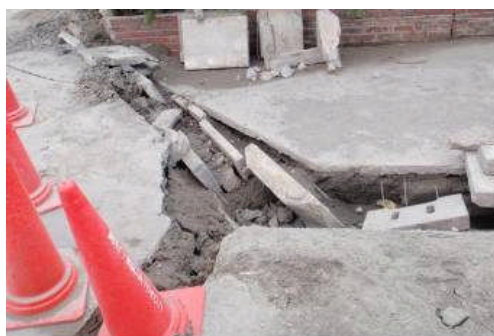
写真 5.5.2.2-12 破断した道路面
