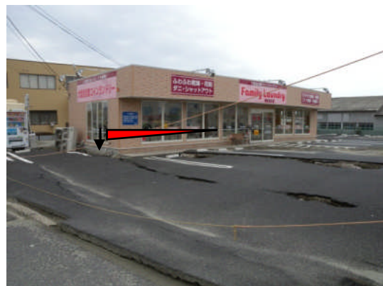
写真 5.5.2.1-14 片側が不同沈下した建築物(同)
