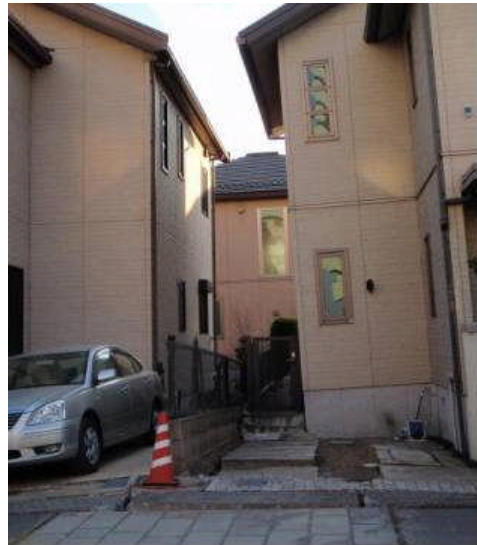
写真 5.5.2.2-18 傾斜した住宅
