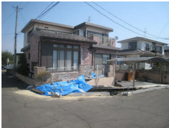
写真 5.5.2.3-33 丘陵地の頂部付近③で宅地盛土の変状により被災した住宅
