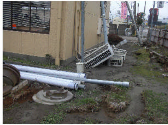
写真 5.5.2.1-16 写真 5.5.2.1-15 の周囲の変状 (右側が県道 11 号)
