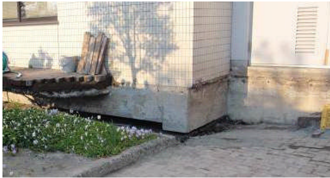
写真 5.5.2.2-16 周辺地盤が沈下した建物
