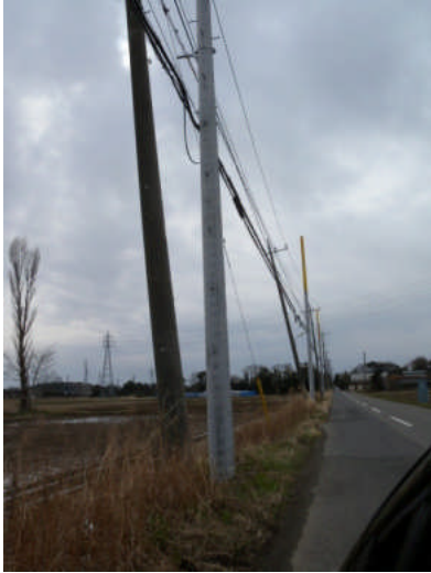
写真 5.5.2.1-1 電柱の傾斜（復旧中）
