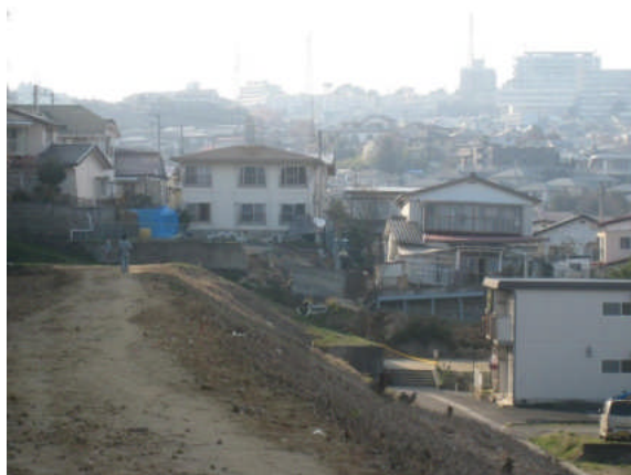
写真 5.5.2.3-9 宅地盛土の滑动・地盤変状により被災した住宅群(青山2丁目付近)
