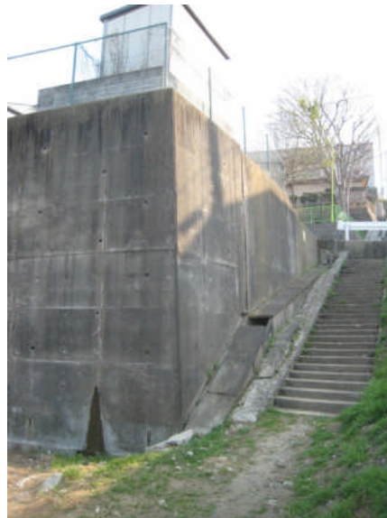
写真 5.5.2.3-14 宅地盛土の滑動・地盤変状による宅地擁壁の損傷（青山2丁目付近）
