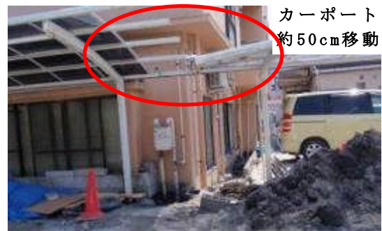
写真 5.5.2.2-4 移動したカーポート
