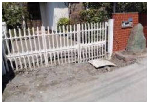
写真 5.5.2.2-3 沈下と敷地内噴砂の状況
