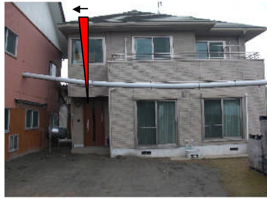
写真 5.5.2.1-25 傾斜した住宅 (写真 5.5.2.1-24 の左端)
