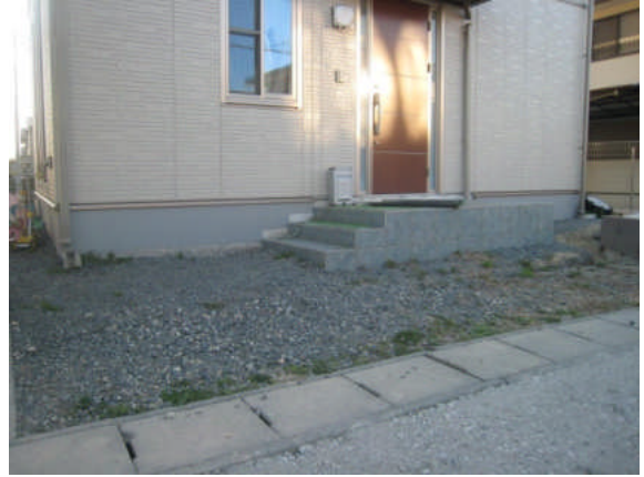
写真 5.5.2.3-54 住宅に対する地盤の相対沈下
