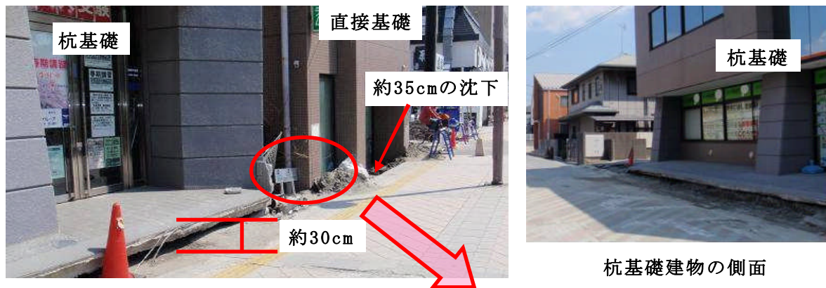
写真 5.5.2.2-14 支持機構による被害状況の違い
