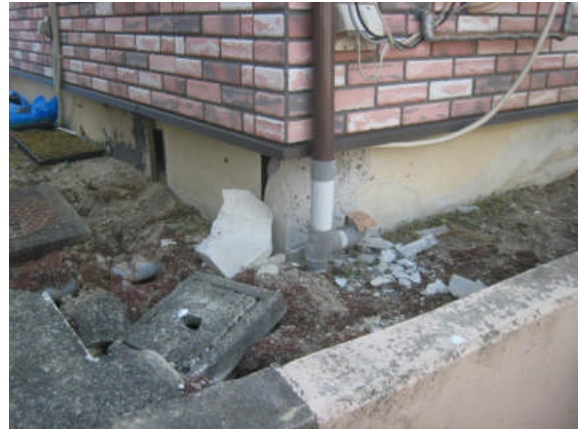
写真 5.5.2.3-34 写真 5.5.2.3-33 の住宅の基礎の損傷と盛土の変状
