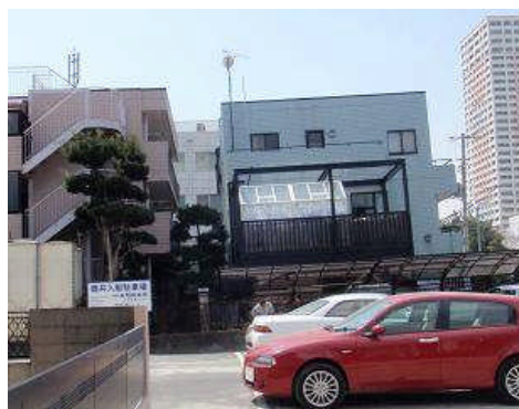
写真 5.5.2.2-15 沈下・傾斜した建物
