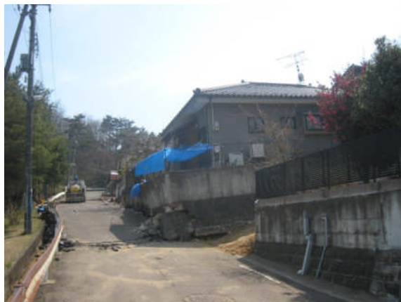
写真 5.5.2.3-1 宅地盛土の滑動・地盤変状による擁壁の損傷と住宅の移動・傾斜
