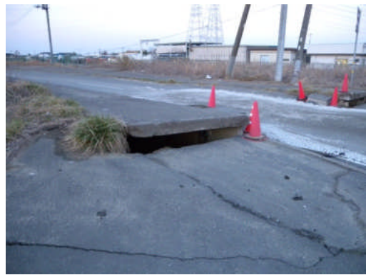
写真 5.5.2.1-42 周辺歩道部分の被害(段差約40cm)
