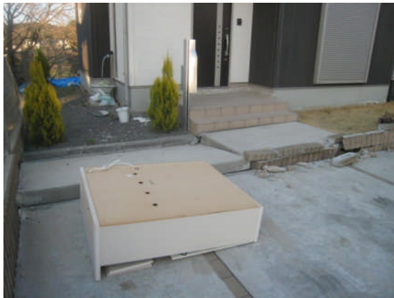
写真 5.5.2.3-55 宅地地盤の変状による損傷
