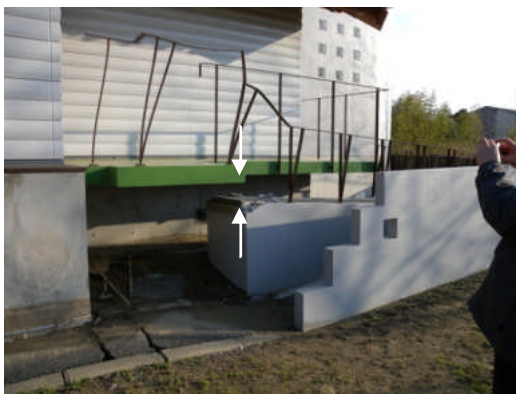
写真 5.5.2.1-35 スロープ部の段差
