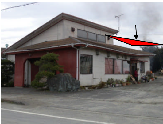
写真 5.5.2.1-17 中央が不同沈下した建築物 (手前側が県道 11 号)
