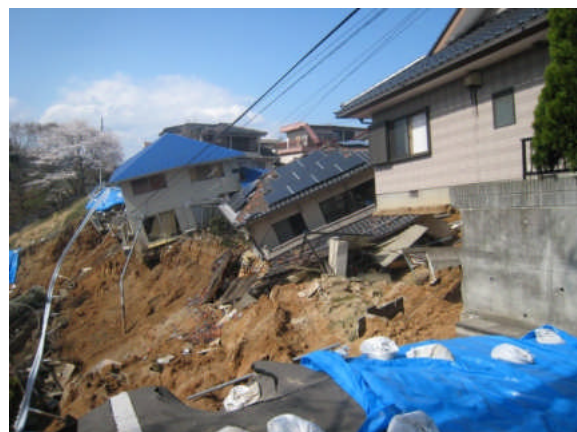
写真 5.5.2.3-46 丘陵の南西側の斜面地①の地すべりと滑り落ちかけた住宅
