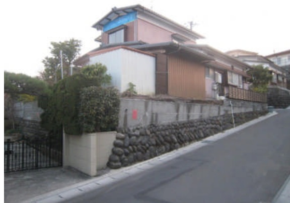
写真 5.5.2.3-20 擁壁の上部に設置されたブロック塀の転落の痕跡
