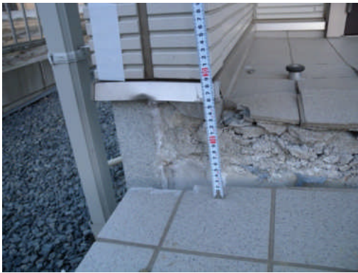
写真 5.5.2.1-41 建築物入口付近の段差
