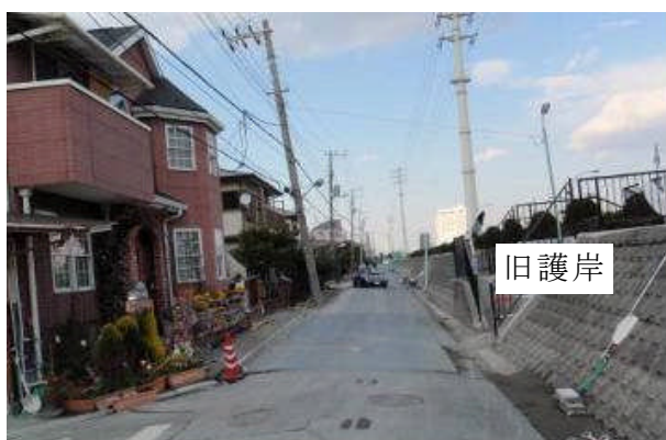
写真 5.5.2.2-11 右側に傾斜した道路
