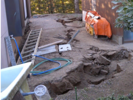
写真 5.5.2.1-37 敷地内の地割れ
