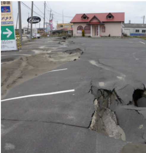
写真 5.5.2.1-13 駐車場路面の変状 (左側が県道 11 号)
