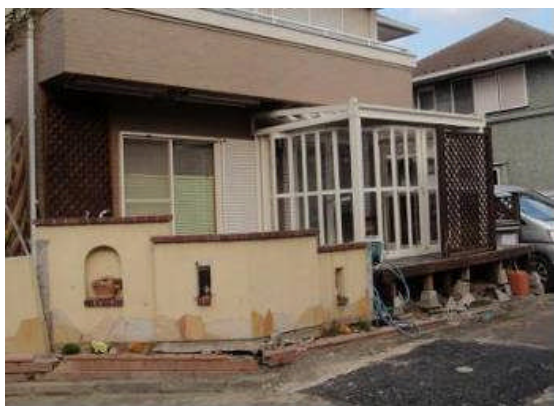
写真 5.5.2.2-9 バルコニー基礎部の被害
