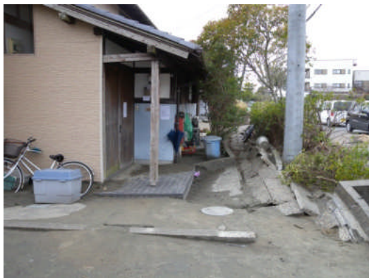
写真 5.5.2.1-29 住宅玄関付近の沈下
