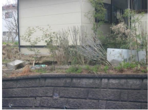
写真 5.5.2.3-40 写真 5.5.2.3-39 の盛土破壊（沈下）により露出した住宅基礎
