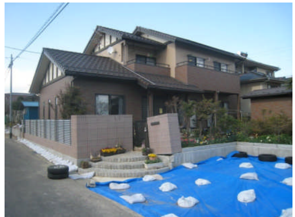
写真 5.5.2.3-50 丘陵の頂部付近の宅地盛土の変状による被害
