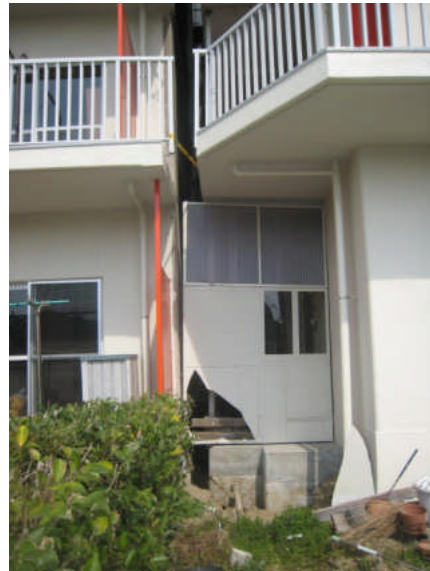
写真 5.5.2.3-26 写真 5.5.2.3-25 の 1 階部分における 2 棟の隙間および地盤の相対沈下
