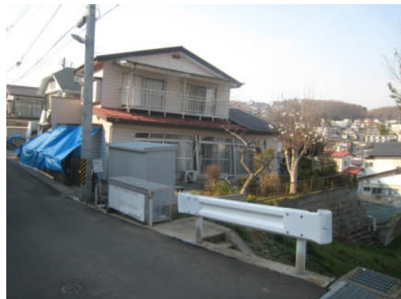
写真 5.5.2.3-10 宅地盛土の滑动・地盤変状による住宅の変形(青山2丁目付近)
