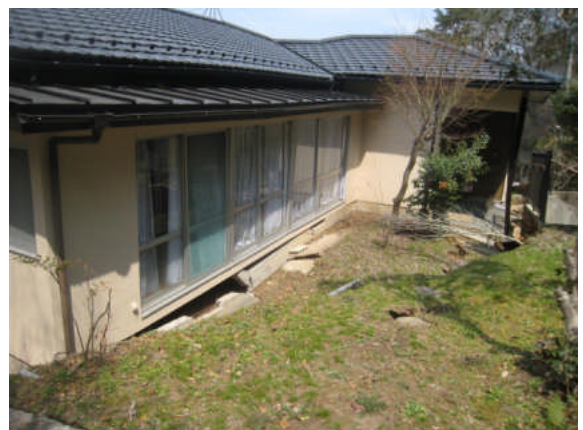
写真 5.5.2.3-8 写真 5.5.2.3-7 の住宅の宅地盛土の滑動・地盤変状による基礎の破壊
