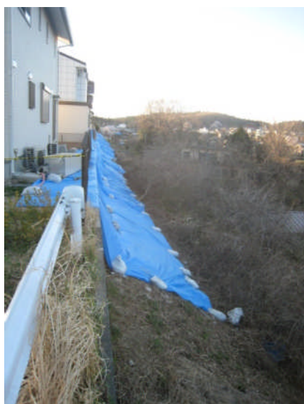
写真 5.5.2.3-51 宅地盛土の沼地側（紙面の右側）への滑動による地盤の変状と、それに伴う擁壁の被害（ブルーシート掛け）
