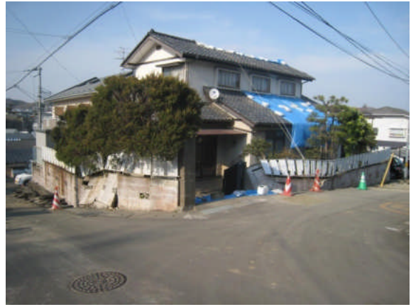
写真 5.5.2.3-12 宅地盛土の滑動・地盤変状により被災した住宅（緑ヶ丘4丁目付近）
