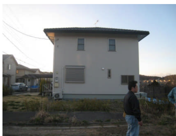
写真 5.5.2.3-52 写真 5.5.2.3-51 の住宅（沼地側（紙面の右側）に傾斜している）
