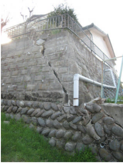
写真 5.5.2.3-11 写真 5.5.2.3-10の住宅の斜面側に位置する擁壁の損傷（青山2丁目付近）
