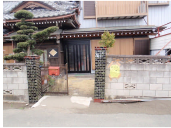
写真 5.5.2.1-6 ブロック塀の段差
