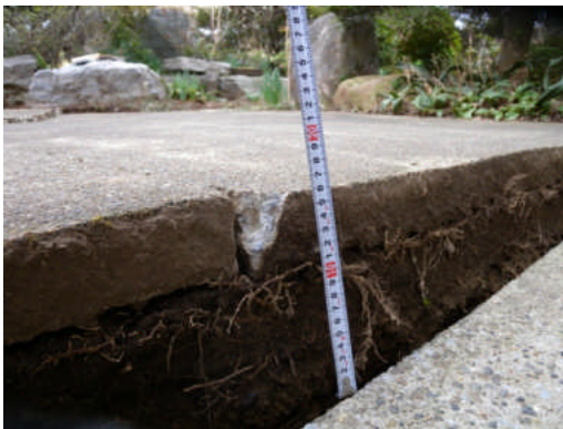
写真 5.5.2.1-9 入口付近の沈下
