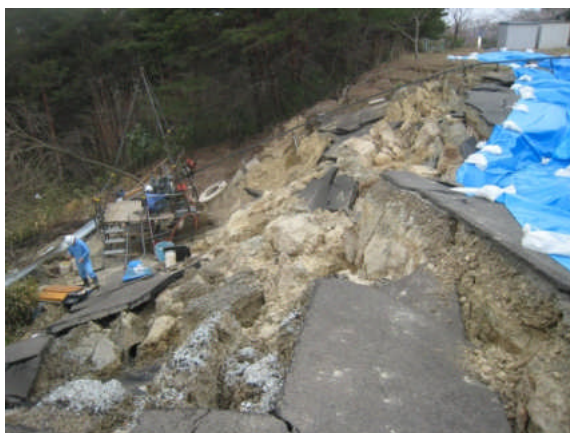
写真 5.5.2.3-37 高台の端部斜面①の地すべり(ボーリング調査が行われている)
