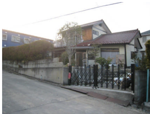
写真 5.5.2.3-16 宅地盛土の滑動・地盤変状による住宅の大変形
