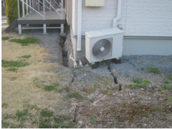
写真 5.5.2.3-53 写真 5.5.2.3-52 の住宅の地盤の変状
