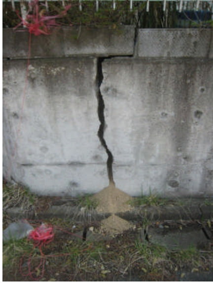
写真 5.5.2.3-31 写真 5.5.2.3-30 の住宅の盛土擁壁の破壊
