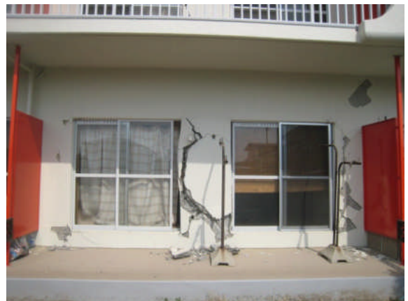
写真 5.5.2.3-28 建物 A の傾斜していない棟の 1 階における非構造壁の損傷
