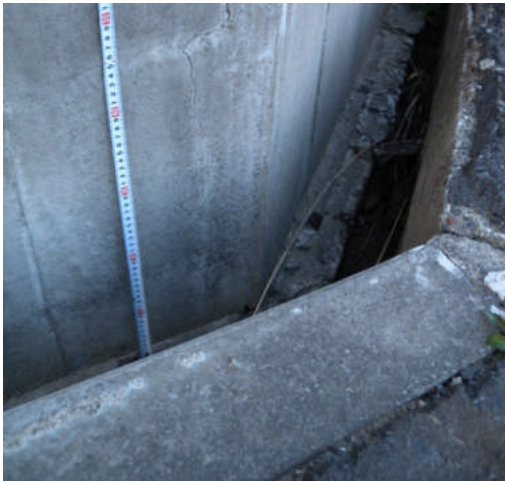
写真 5.5.2.1-39 外周部塀と前面道路との段差
