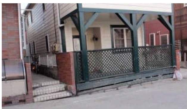
写真 5.5.2.2-13 左側が沈下・傾斜した住宅
