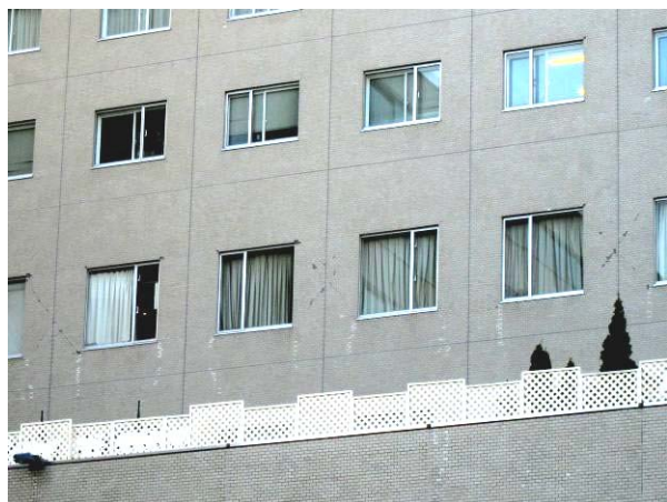
写真 5.6-26 外壁タイルの被害
