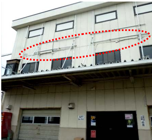
写真 5. 6-5 ALC パネルの損傷被害
