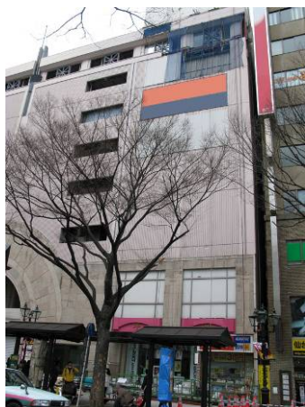
写真 5. 6-8 ALC パネルの脱落被害
