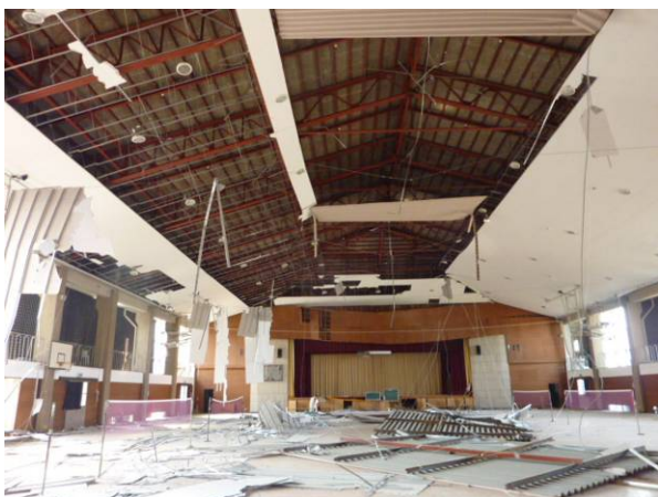
写真 5.6-40 在来工法による天井等の脱落被害
