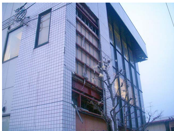
写真 5.6-16 ラスモルタル外壁の脱落被害
