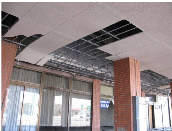
写真 5.6-25 軒天井の被害
