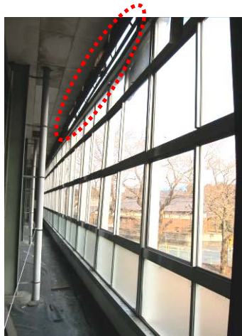
写真 5. 6-59 窓サッシの外側への倒れ
