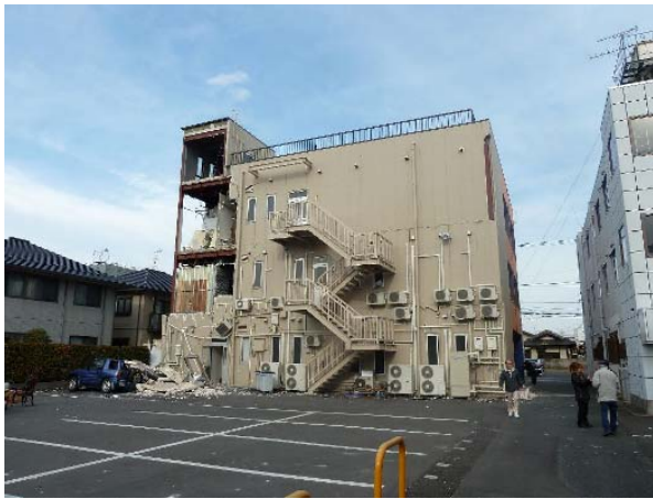
写真 5.6-18 ALC パネル外壁の脱落被害
