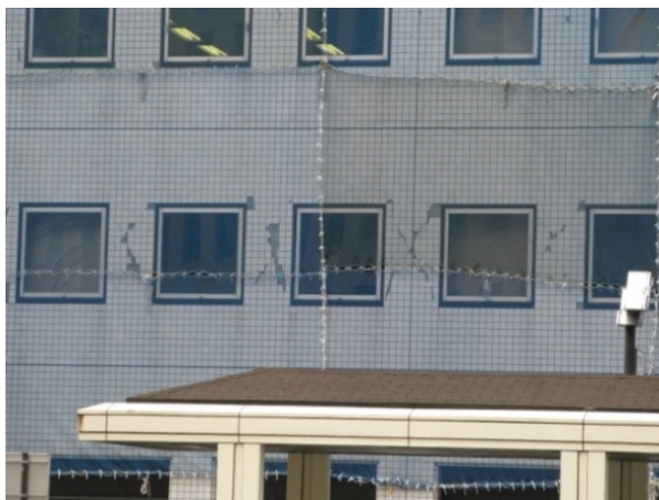
写真 5.6-1 外壁タイルの脱落被害
