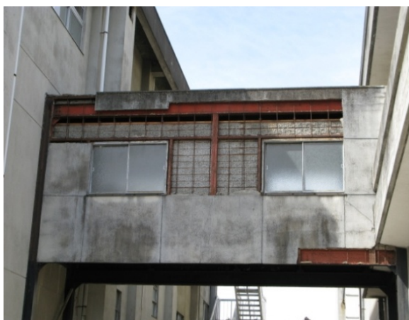
写真 5.6-17 ラスモルタル外壁の脱落被害
