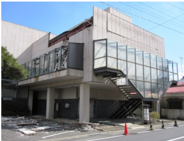
写真 5.6-20 ALC パネル外壁の脱落被害
