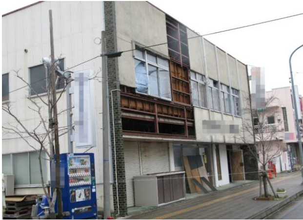
写真 5. 6-3 ラスモルタル外壁の脱落被害
