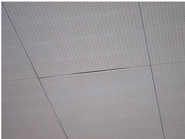
写真 5. 6-46 天井板のとめつけ箇所での浮き
