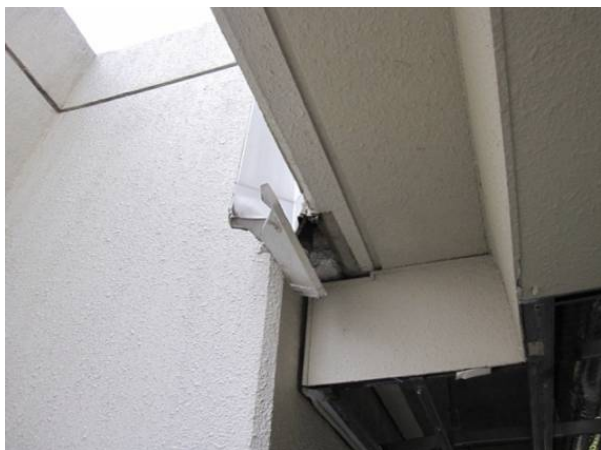
写真 5. 6-12 エキスパンションジョイント部での被害
