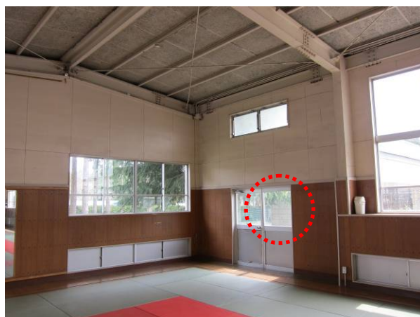
写真 5.6-57 両開きドアのガラスの被害
