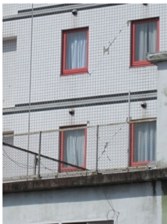
写真 5.6-14 外壁タイルの脱落被害
