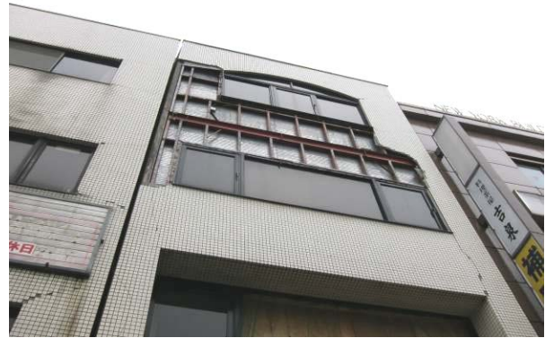
写真 5.6-29 ラスモルタル外壁の脱落被害
