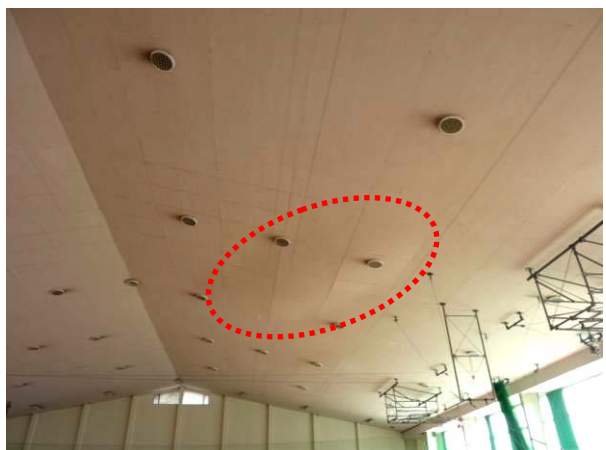
写真 5.6-41 在来工法による天井の天井面の異状
