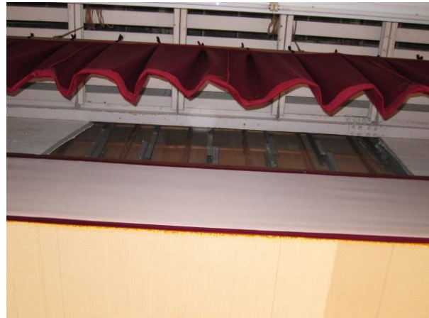
写真 5. 6-51 舞台上部の内壁の脱落被害
