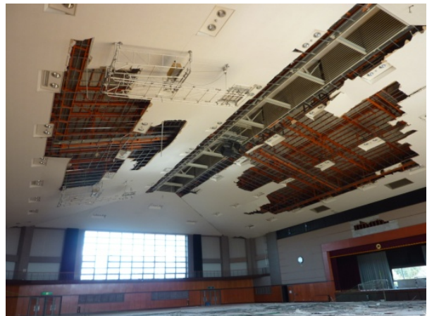
写真 5.6-39 在来工法による天井の脱落被害
