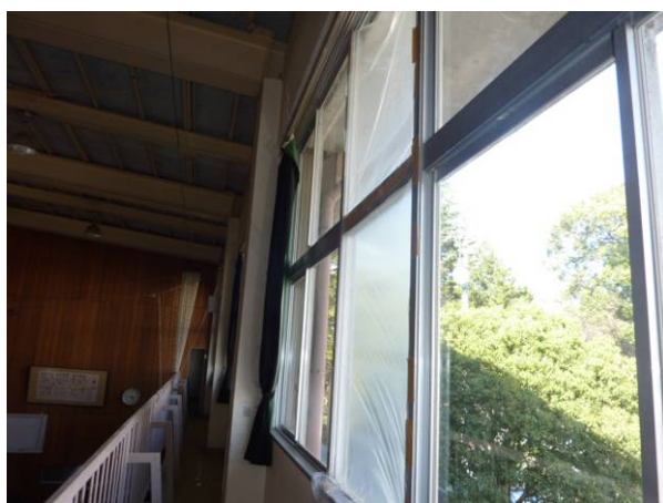
写真 5.6-55 はめ殺し窓のガラスの被害
