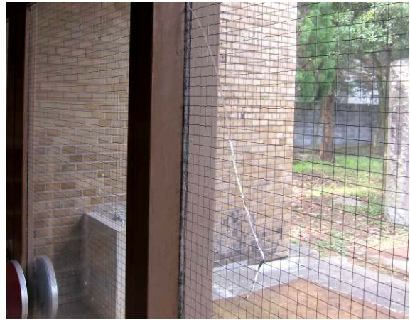
写真 5. 6-33 窓ガラスの被害
