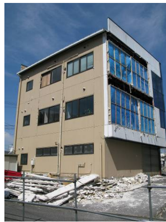
写真 5.6-19 ALC パネル外壁の脱落被害
