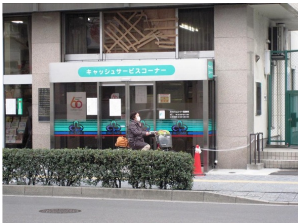
写真 5. 6-10 建物の低層部のガラスの破損
