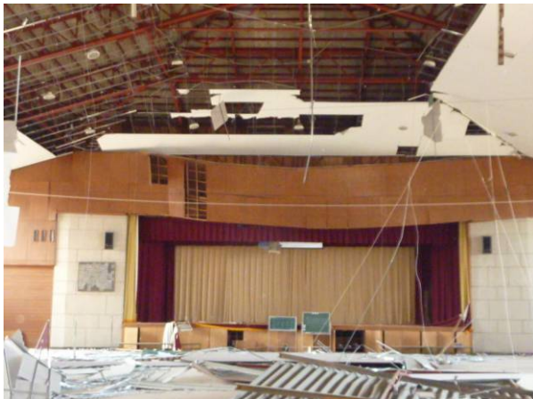
写真 5. 6-50 舞台上部の内壁での被害
