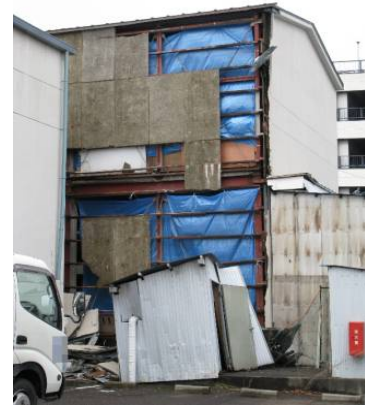
写真 5. 6-4 ラスモルタル外壁の脱落被害
