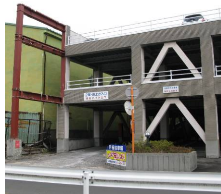
写真 5. 6-9 ALC パネルの脱落被害
