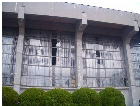
写真 5.6-23 体育館の窓ガラスの被害
