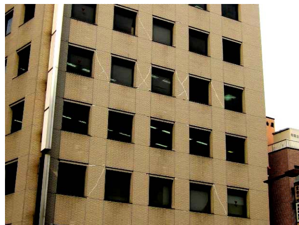
写真 5.6-27 外壁タイルの被害
