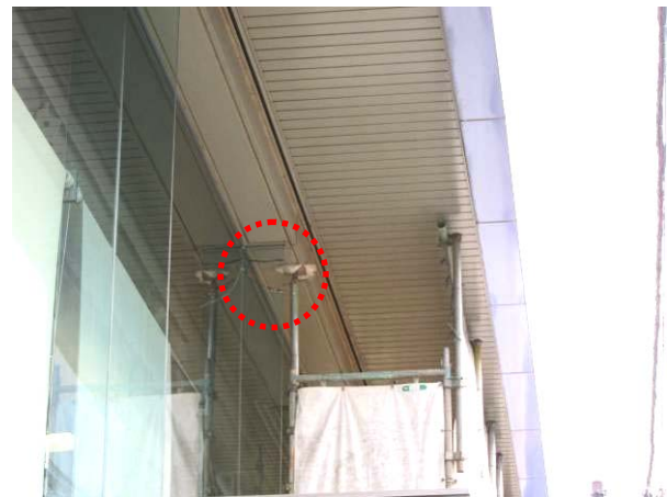
写真 5. 6-35 ガラススクリーンの被害
