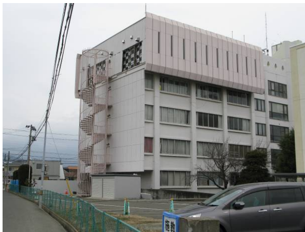
写真 5.6-21 ALC パネル外壁の脱落被害
