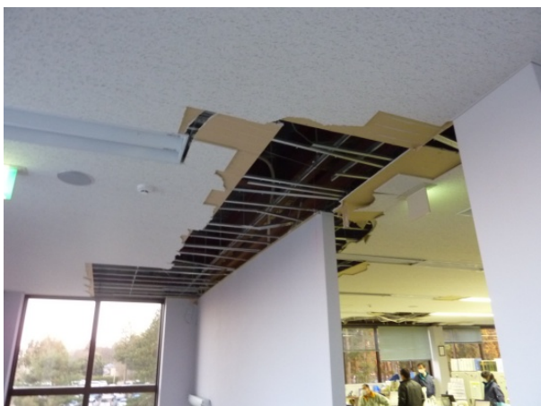
写真 5. 6-36 間仕切り上部での天井の被害
