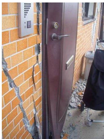
写真 5.6-24 玄関ドアの被害
