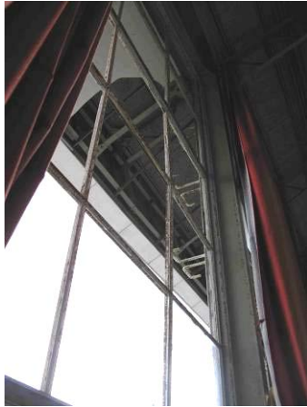
写真 5. 6-48 在来工法による軒天井の被害
